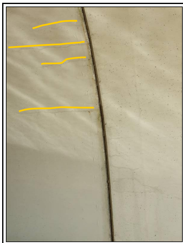
Fisuras longitudinales paralelas por falta de recubrimiento
