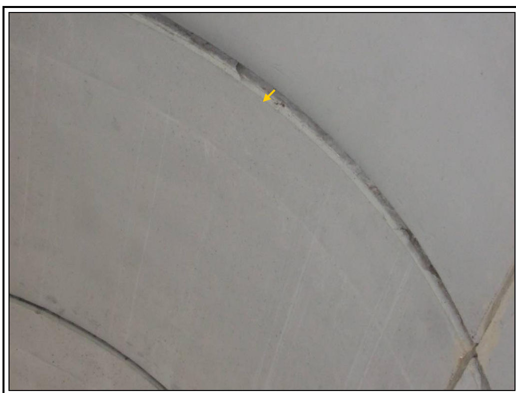
Elemento desplazado de su posición original
