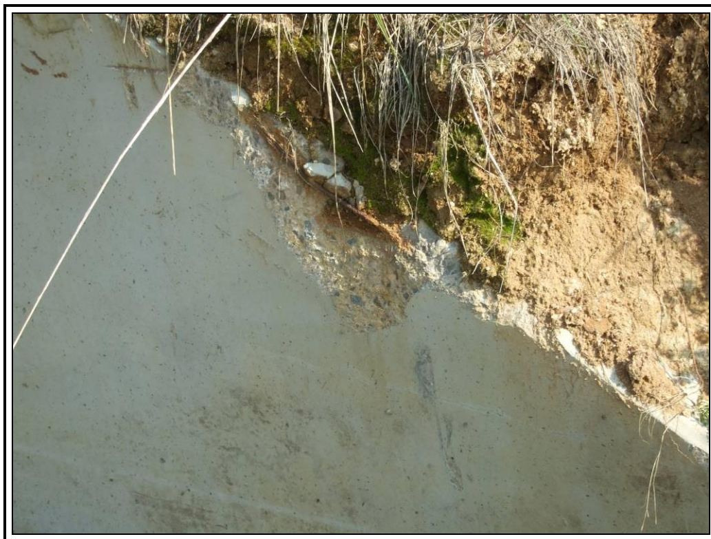
Desconchón con armadura implicada en acceso izquierdo
