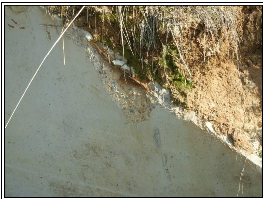
Desconchón con armadura implicada en acceso izquierdo
