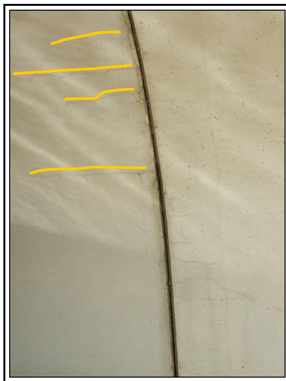
Fisuras longitudinales paralelas por falta de recubrimiento
