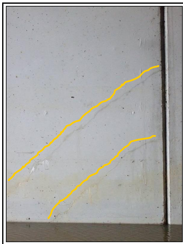
Fisuras oblicuas en la tercera dovela de hastial de salida
