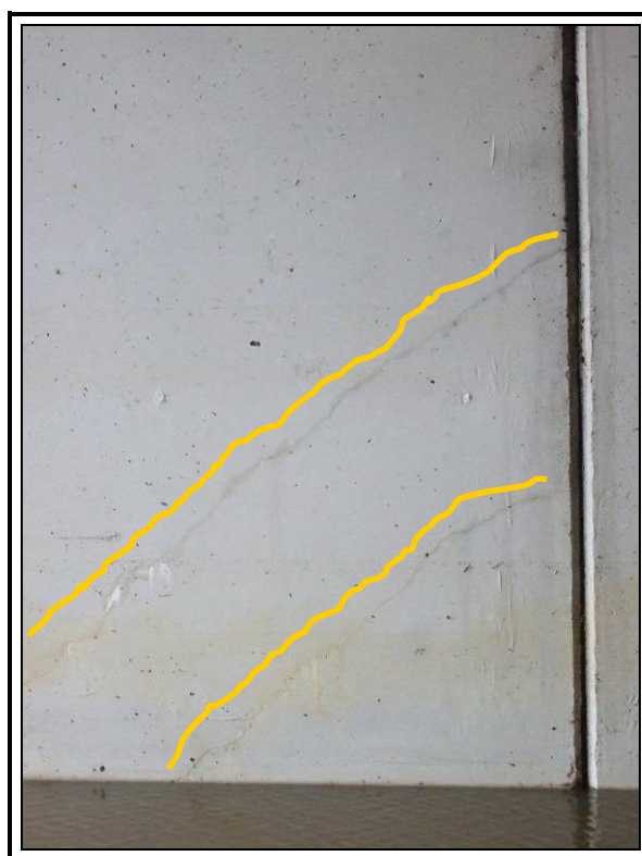
Fisuras oblicuas en tercer elemento prefabricado hastial de salida
