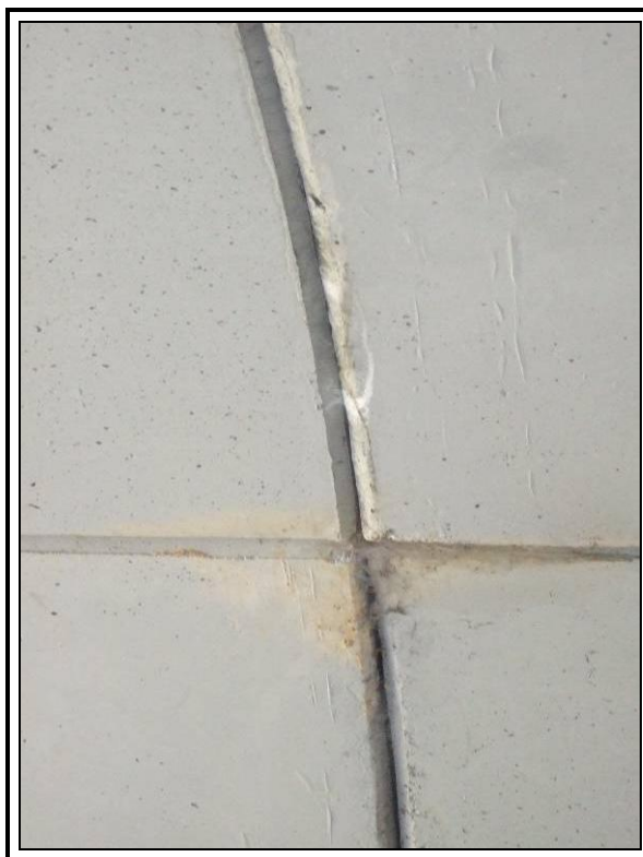
Filtraciones con eflorescencias en la clave de la bóveda
