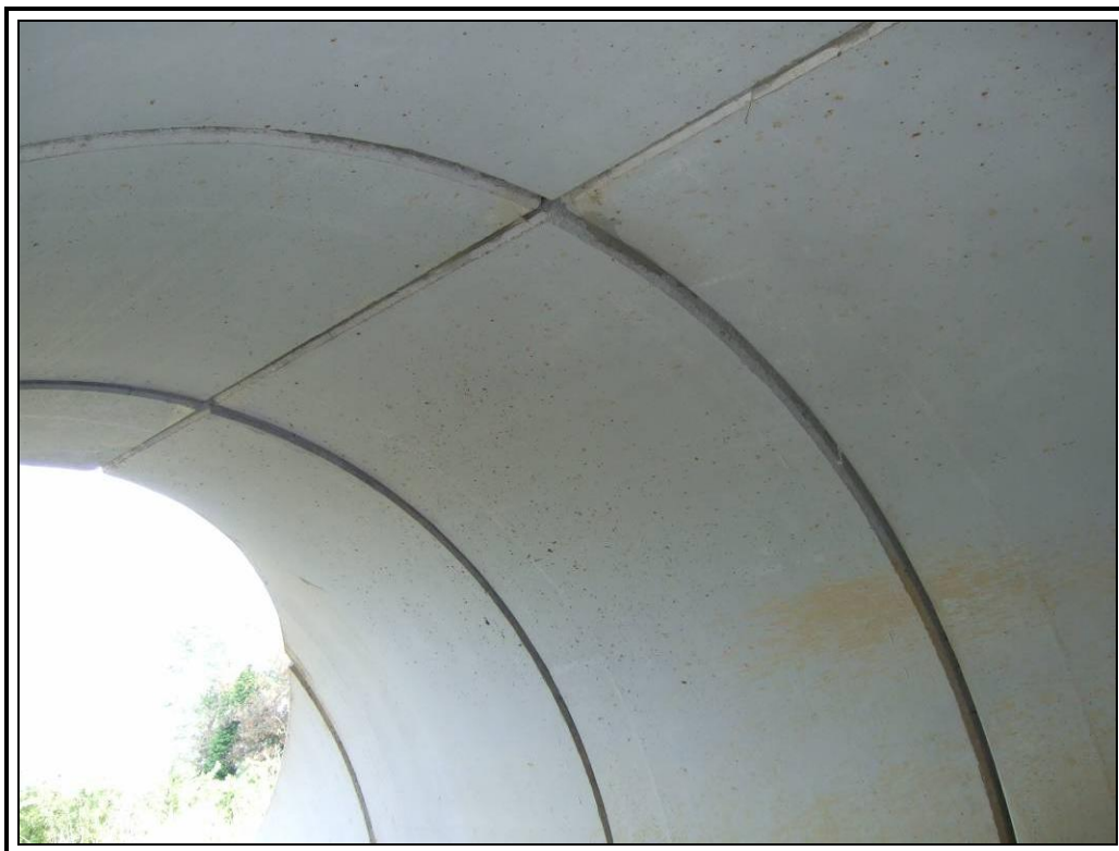
Desplazamiento relativo entre anillos de la bóveda
