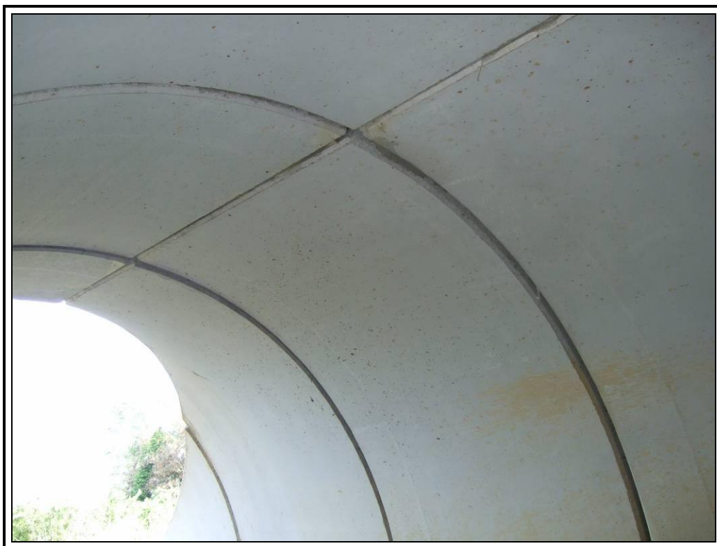
Desplazamiento relativo entre anillos de la bóveda
