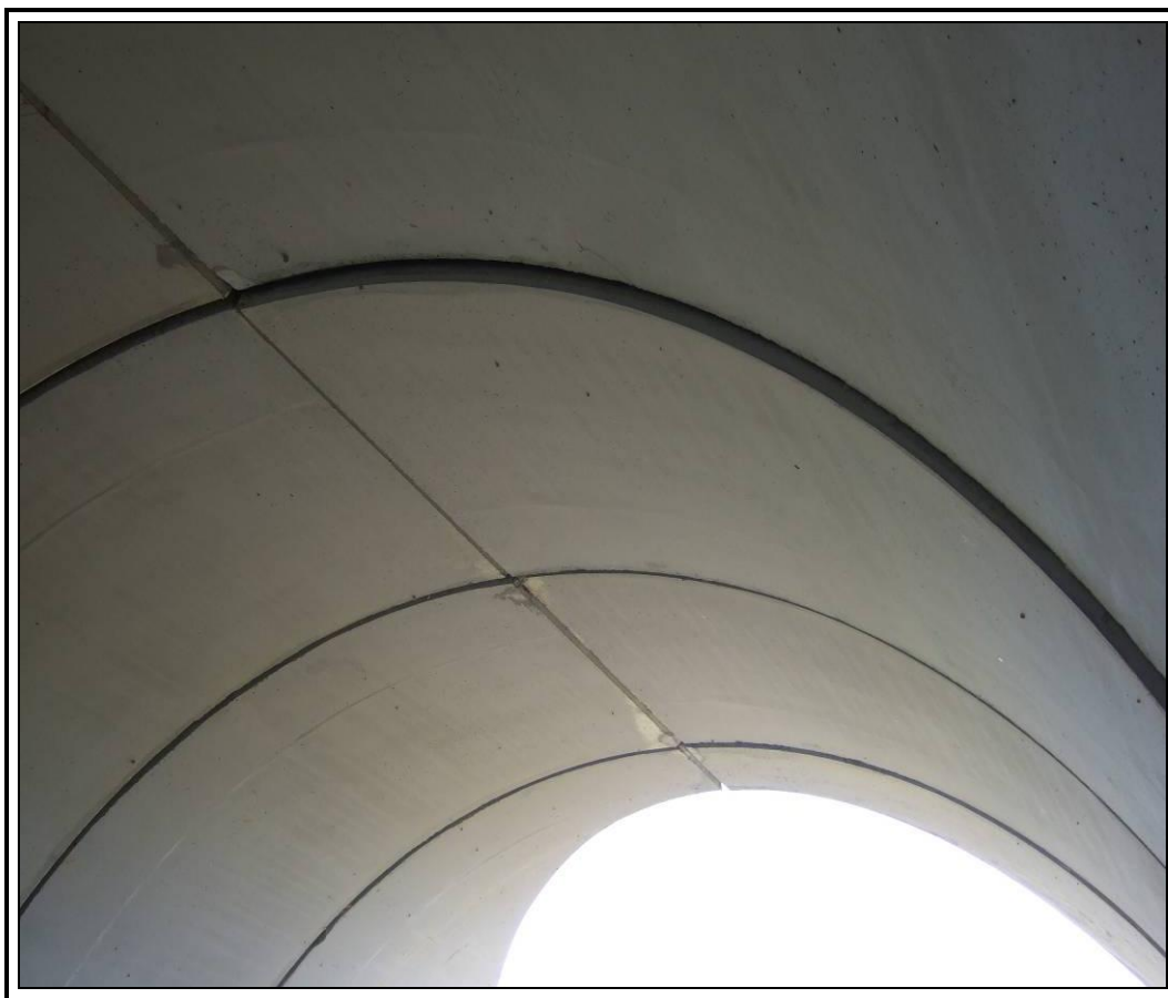
Desplazamiento entre el 2º y el tercer elemento en el lado derecho.
