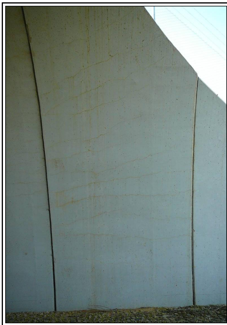
Familia de fisuras en elemento lado izquierdo.
