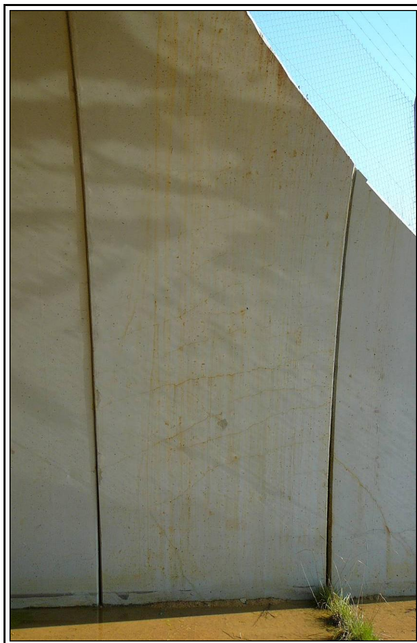
Familia de fisuras en elemento lado derecho.
