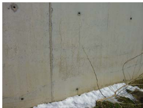
Fotografía nº 8. Nidos de grava en la aleta derecha del estribo de entrada
