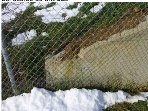
Fotografía nº 9. Desconchón en la aleta derecha del estribo de entrada
