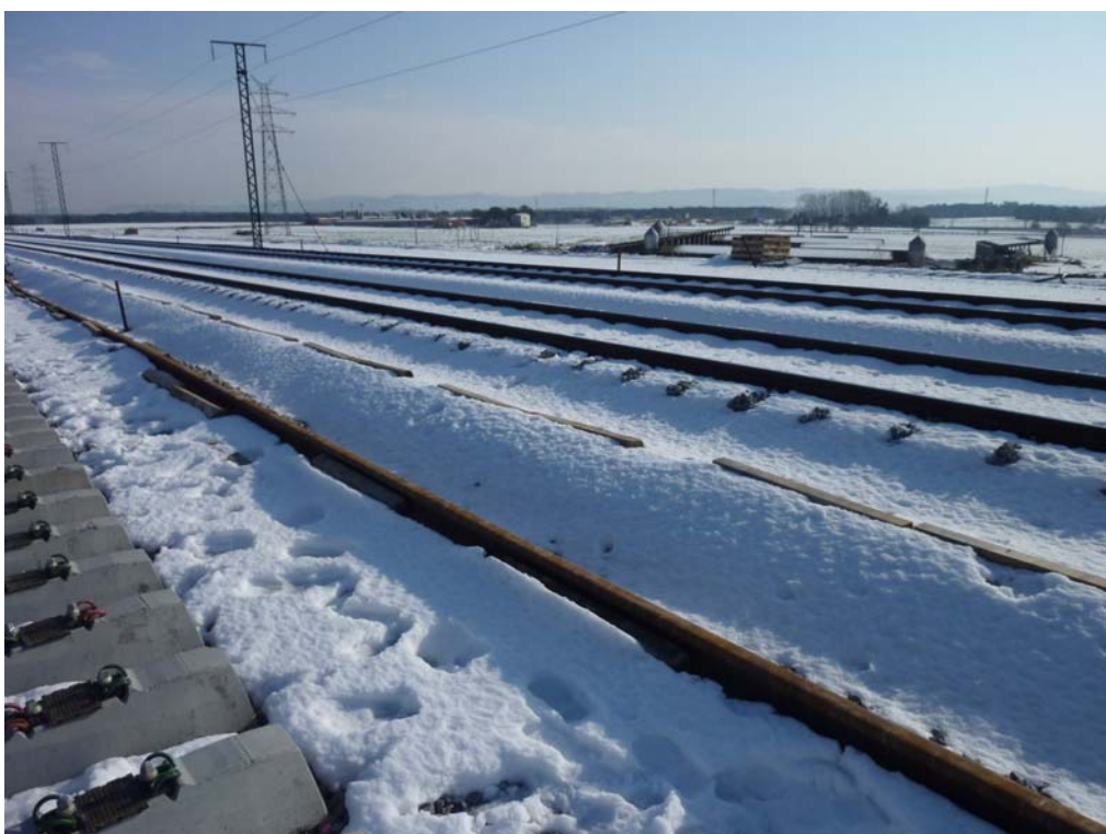
Fotografía 308: Material de vía
