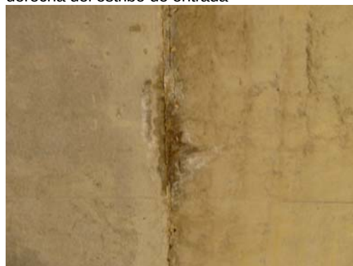
Fotografía nº 10. Eflorescencias en el paramento inferior de la losa superior
