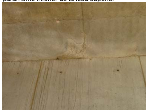
Fotografía nº 10. Nido de grava en el paramento inferior de la losa superior
