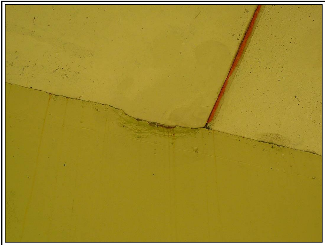
Desconchón por contacto con armadura implicada en vano 5 viga izquierda.
