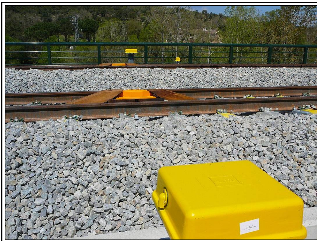
Material de vía (señalización)
