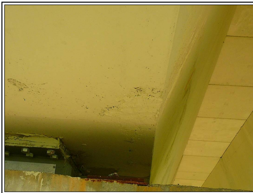
Nido de grava con reparación deficiente vano 11.
