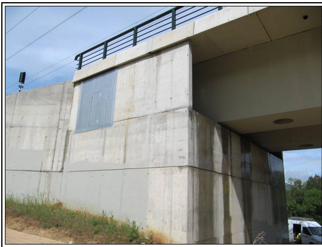
Filtraciones en estribo 1.
