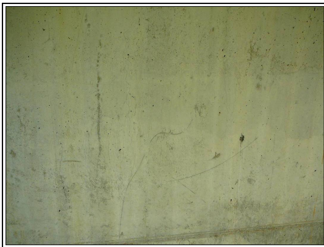
Fisura de retracción Pila 13.
