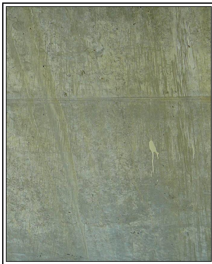
Fisura de retracción Pila 9.
