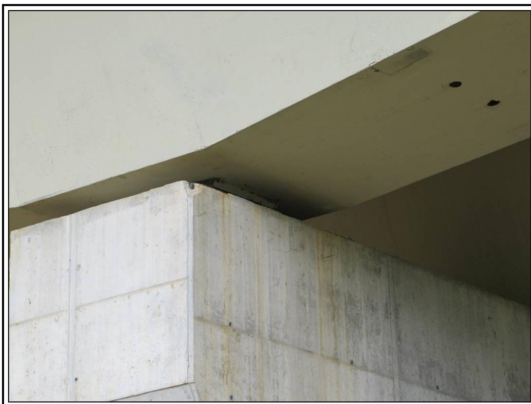
Desconchón por golpe con armadura implicada en Pila 1
