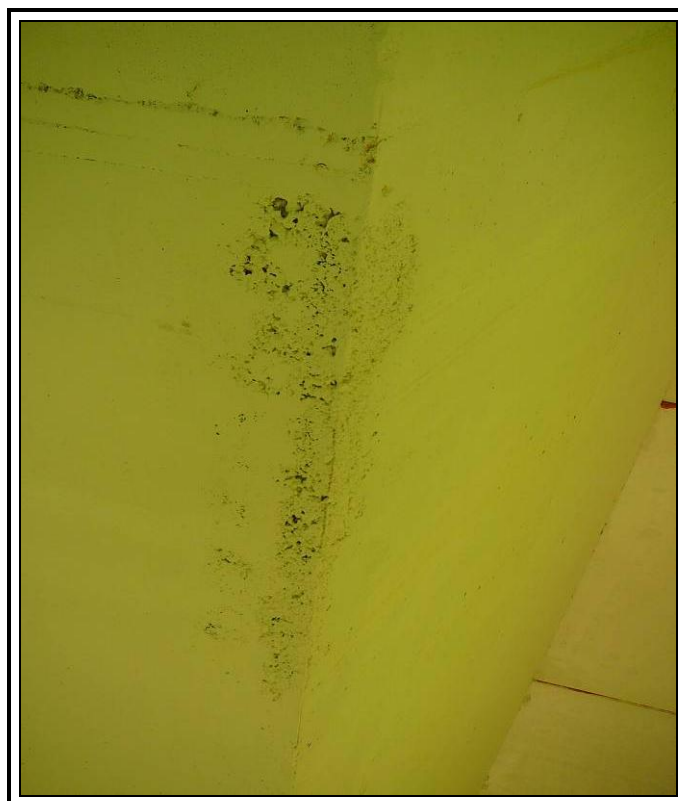
Nido de grava en vano 5 viga izquierda.
