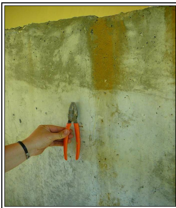
Fisura de retracción Pila 4.
