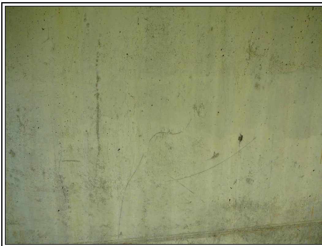
Fisura de retracción Pila 13.
