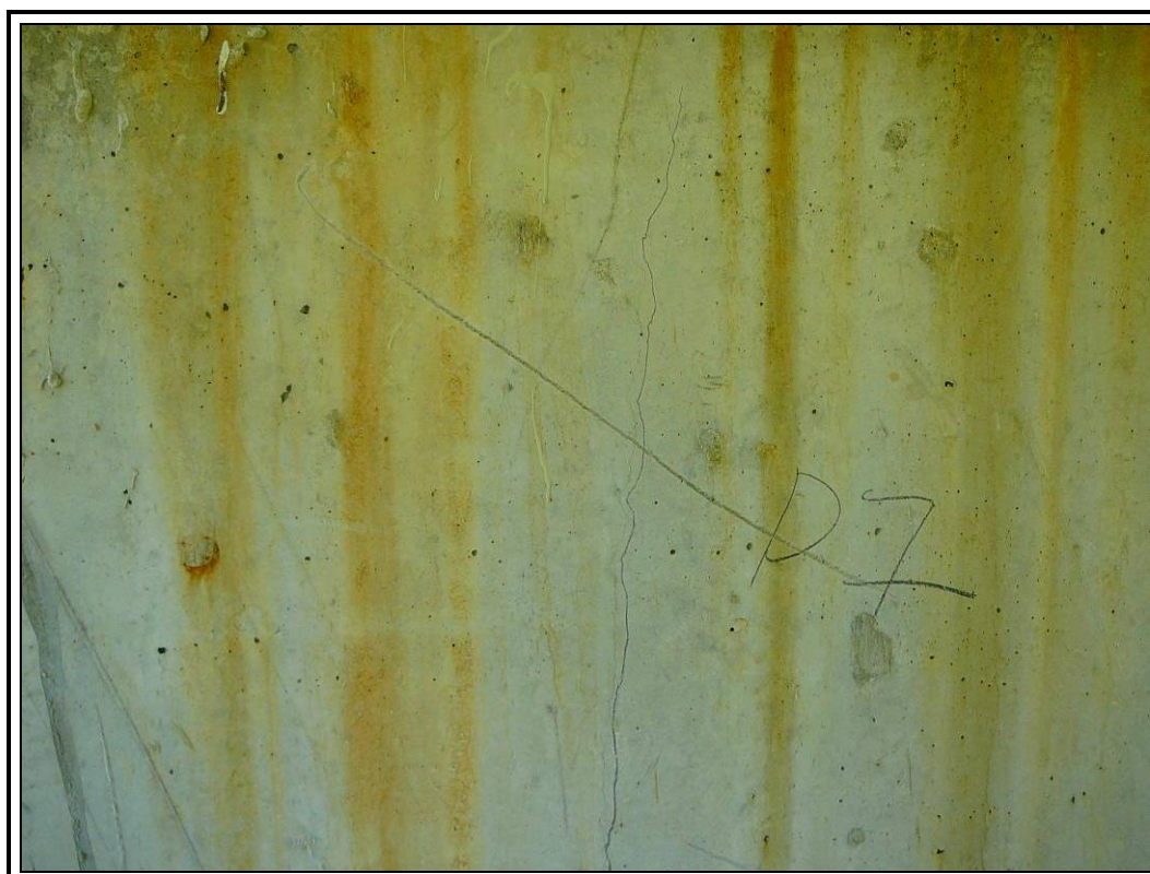
Fisura de retracción Pila 7.
