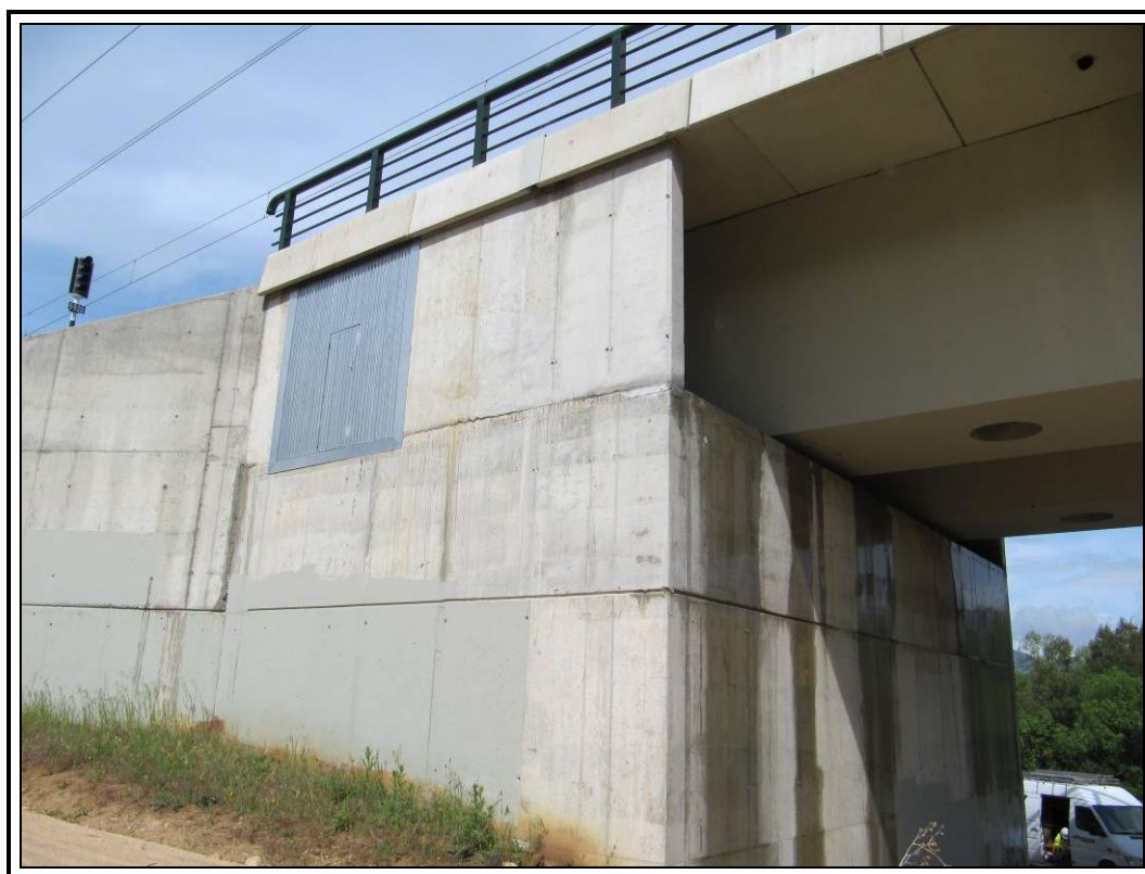
Filtraciones en estribo 1.
