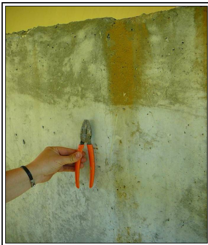
Fisura de retracción Pila 4.
