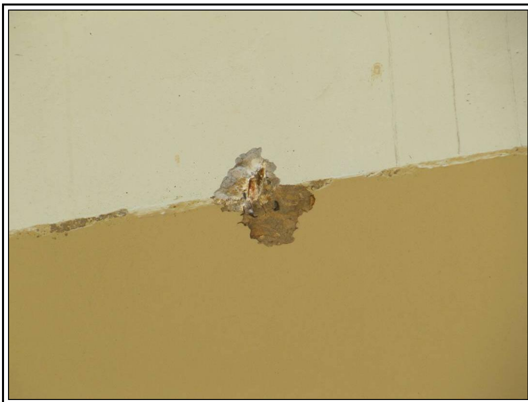
Desconchón por golpe en vano 1 viga derecha.
