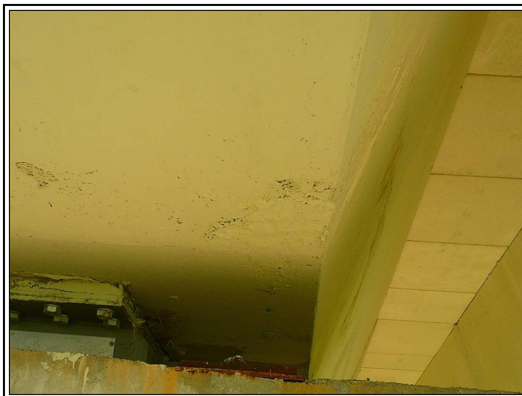
Nido de grava con reparación deficiente vano 11.
