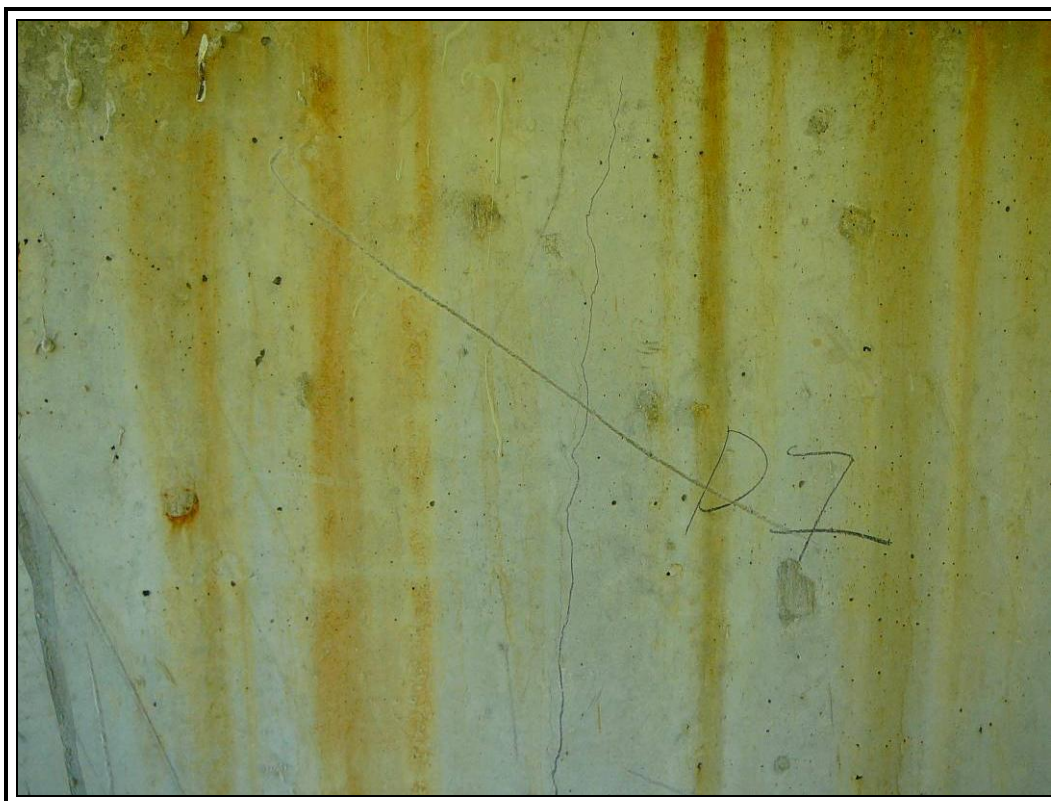
Fisura de retracción Pila 7.
