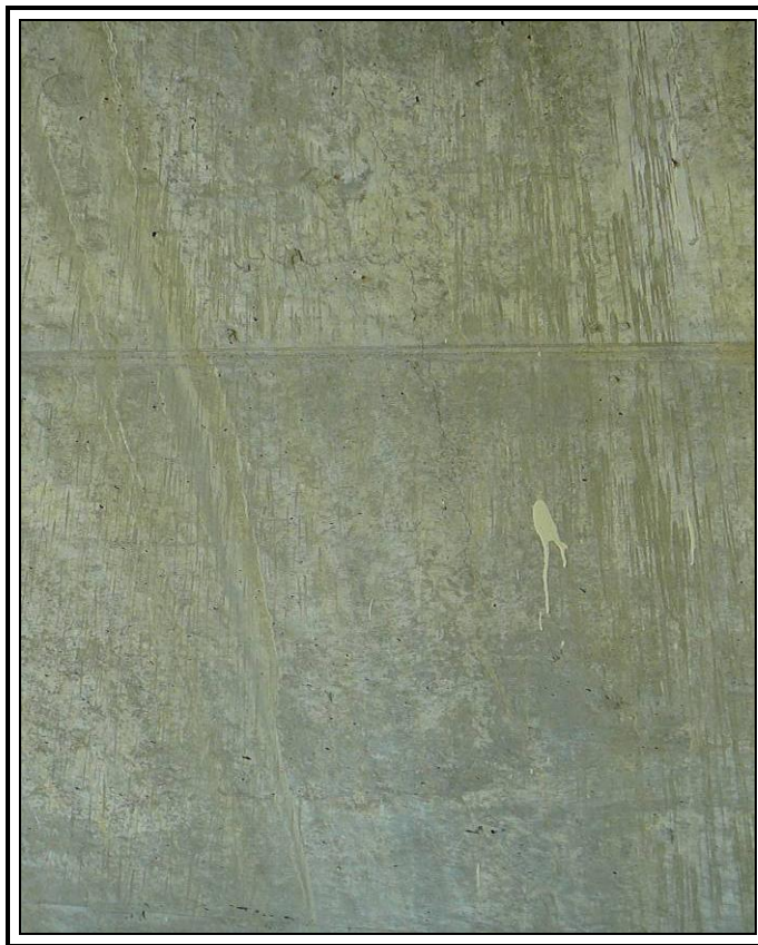
Fisura de retracción Pila 9.
