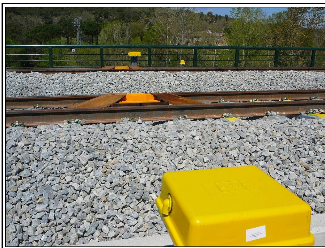
Material de vía (señalización)
