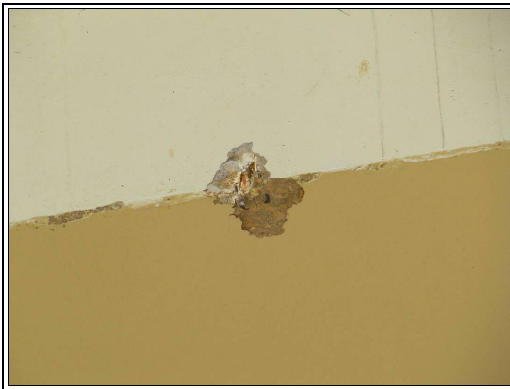
Desconchón por golpe en vano 1 viga derecha.
