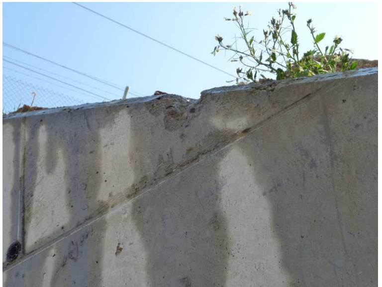
Fotografía N°13: Desconchón en la aleta izquierda del estribo de 1.
