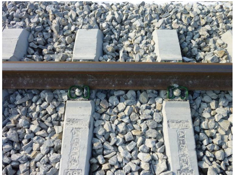
Fotografía N°10: Detalle sujeciones carril.
