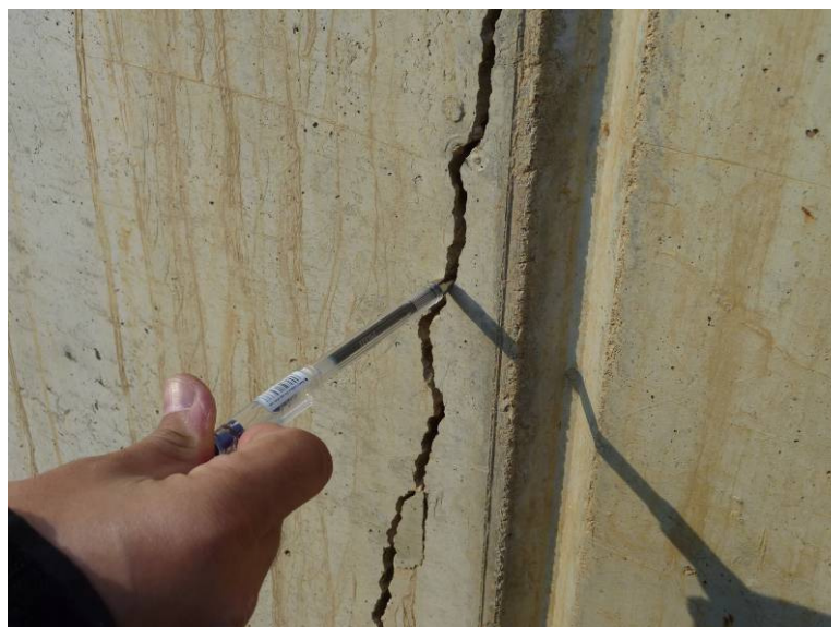
Fotografía N°12: Fisura vertical, junta en la aleta derecha del estribo 2.
