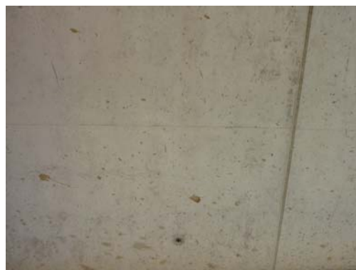
Fotografía nº 8. Fisura en el hastial de entrada
