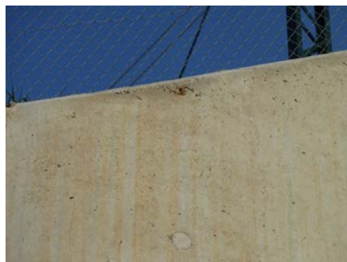
Fotografía nº 10. Nido de grava con armadura vista en la aleta izquierda del estribo de salida.
