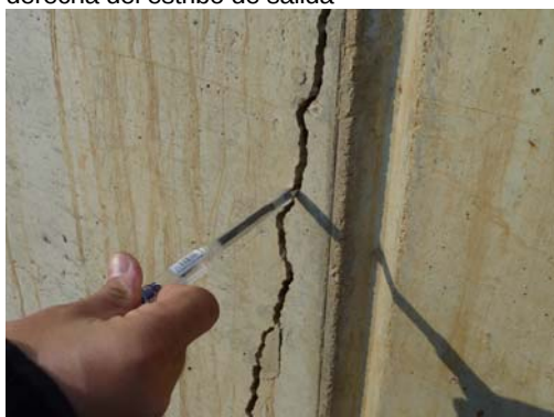
Fotografía nº 9. Fisuras en la aleta derecha del estribo de salida
