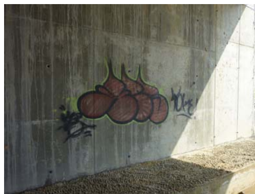
Fotografía nº 8. Pintadas en el hastial del estribo de salida
