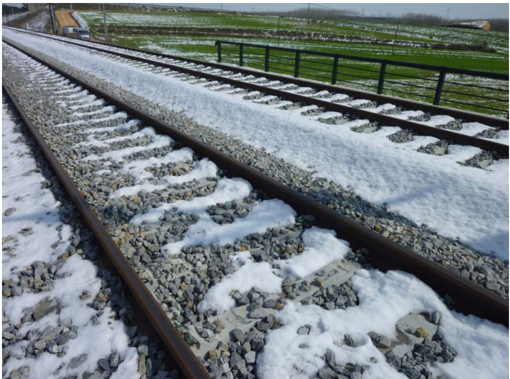
Fotografía 391: Material de vía
