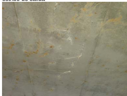
Fotografía nº 10. Fisuras y eflorescencias en el paramento inferior de la losa superior.
