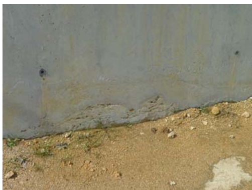
Fotografía nº 7. Nido de grava en la aleta derecha del estribo de entrada
