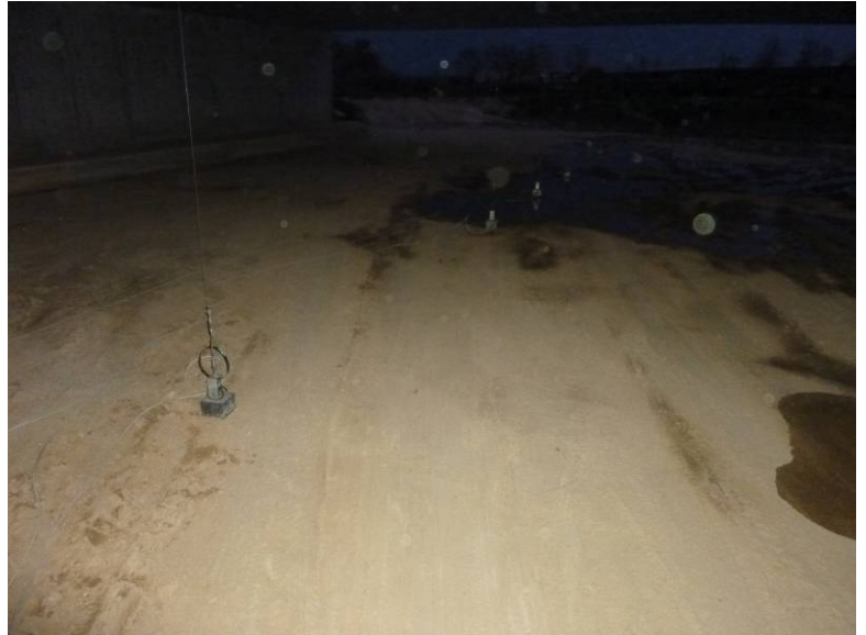
Fotografía N°1: Anillos en centro de vano.
