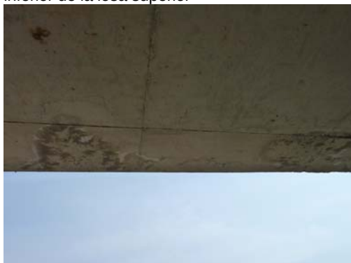
Fotografía nº 11. Nido de grava en el paramento inferior de la losa superior.
