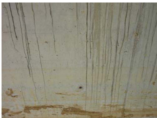
Fotografía nº 7. Fisuras en el hastial del estribo de entrada
