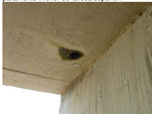
Fotografía nº 12. Humedades en torno al drenaje de la losa superior.
