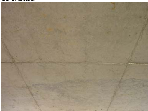
Fotografía nº 9. Fisuras en el paramento inferior de la losa superior
