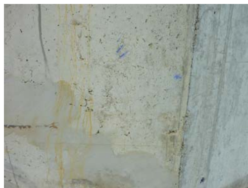
Fotografía nº 8. Nido de grava en el hastial del estribo de entrada
