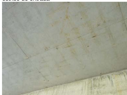
Fotografía nº 10. Armaduras expuestas en el paramento inferior de la losa superior
