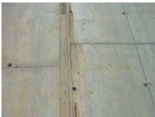
Fotografía nº 7. Fisuras en la aleta derecha del estribo de entrada
