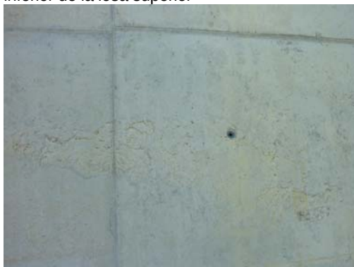
Fotografía nº 11. Nido de grava en la aleta izquierda del estribo de salida
