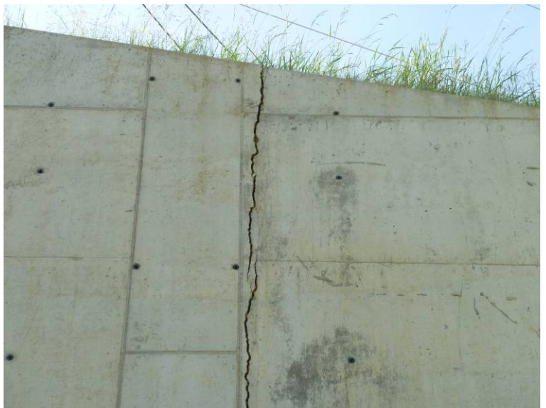
Fotografía N°12: Fisura vertical en la aleta derecha del estribo 2 (2).
