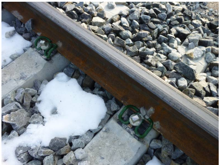
Fotografía N°9: Detalle sujeciones carril.
