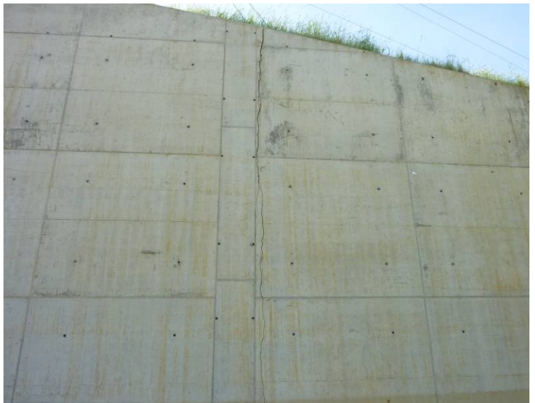
Fotografía N°11: Fisura vertical en la aleta derecha del estribo 2 (1).
