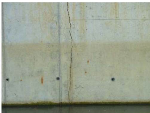
Fotografía nº 7. Fisuras en la aleta izquierda del estribo de entrada
