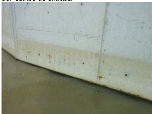
Fotografía nº 9. Armaduras vistas en la aleta izquierda del estribo de entrada
