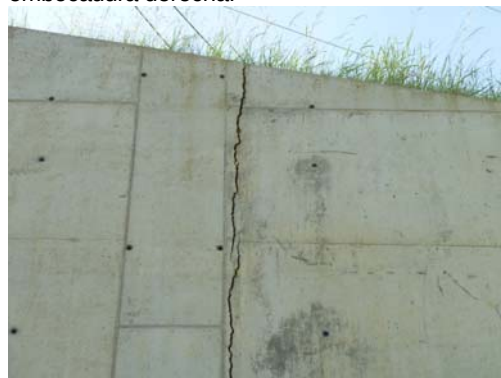
Fotografía nº 12. Fisura en la aleta izquierda del estribo de entrada
