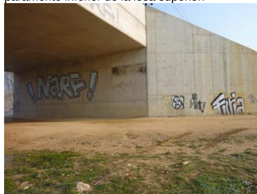
Fotografía nº 12. Pintadas en el estribo de salida
