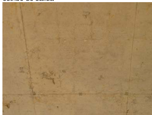
Fotografía nº 10. Fisuras en mapa en el paramento inferior de la losa superior.
