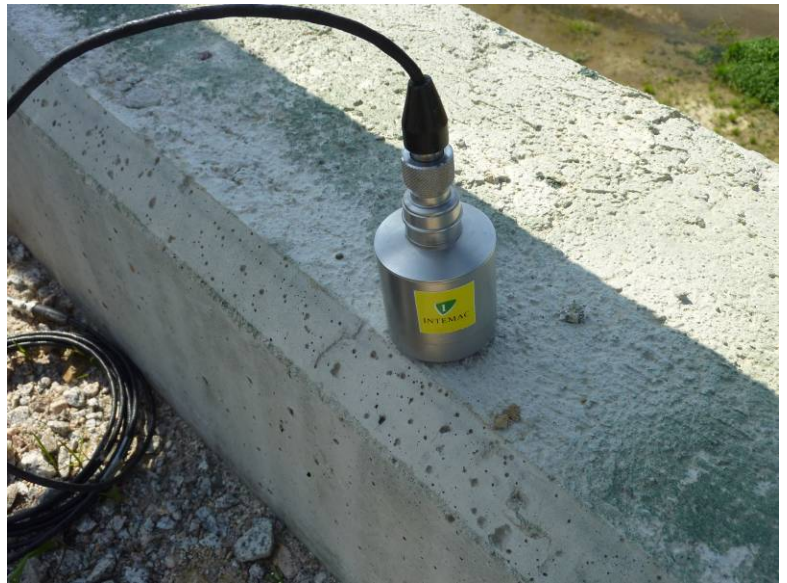
Fotografía N°4: Detalle del acelerómetro.
