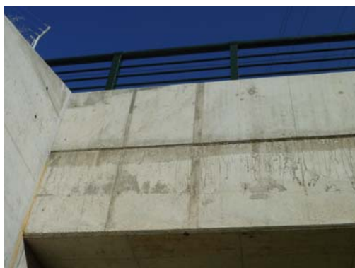
Fotografía nº 7. Fisuras en la embocadura derecha
