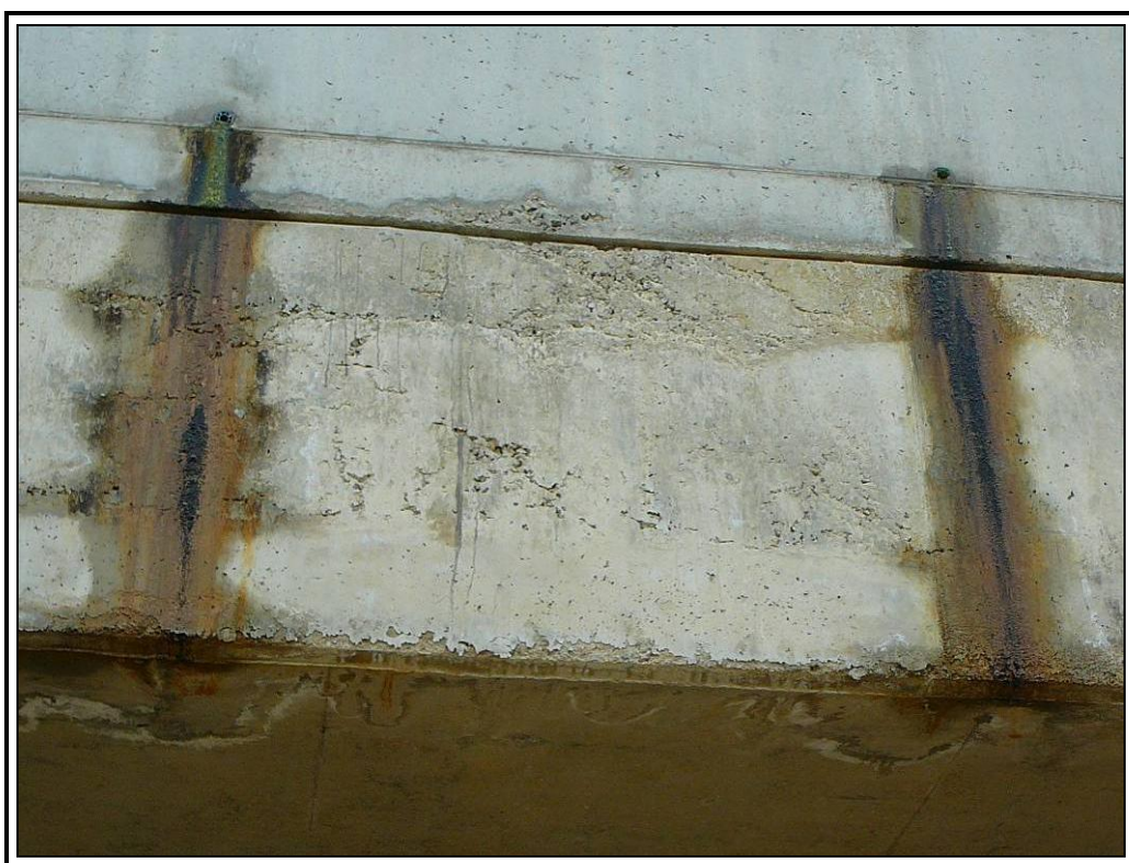
Nidos de grava y filtraciones en canto de dintel (acceso derecho)
