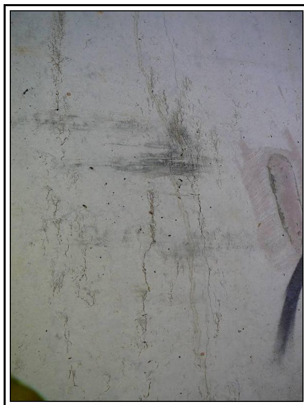
Fisuras verticales de retracción en hastial uno
