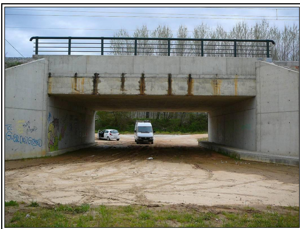
Vista general de las filtraciones (alzado derecho)
