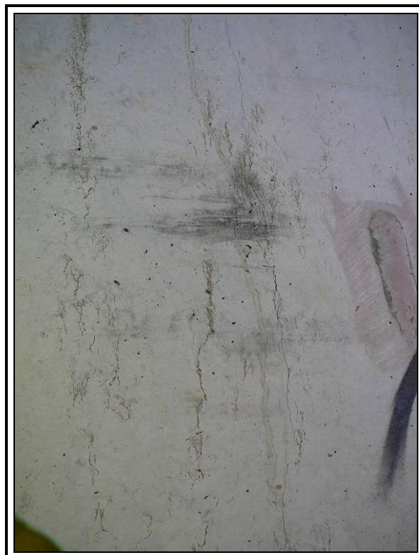
Fisuras verticales de retracción en hastial uno
