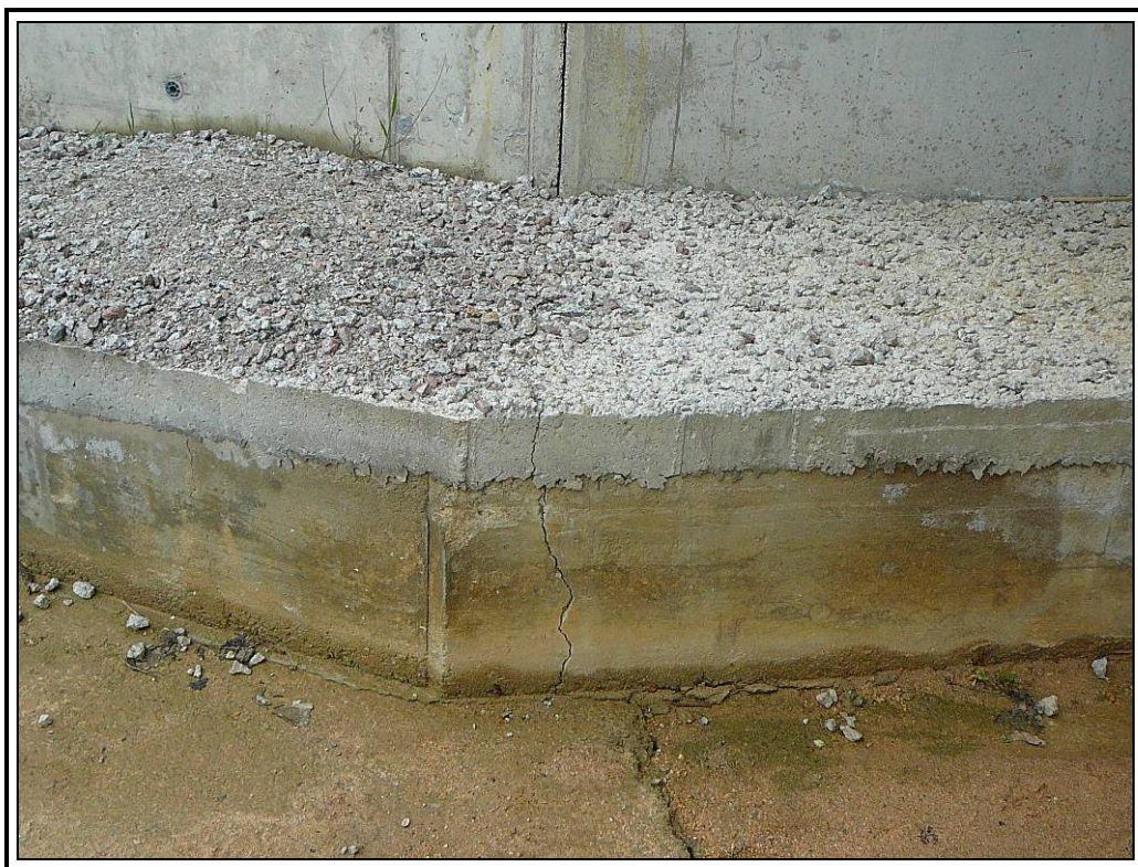
Fisura en “banda seca” coincidente con junta entre hastial dos y aleta izquierda
