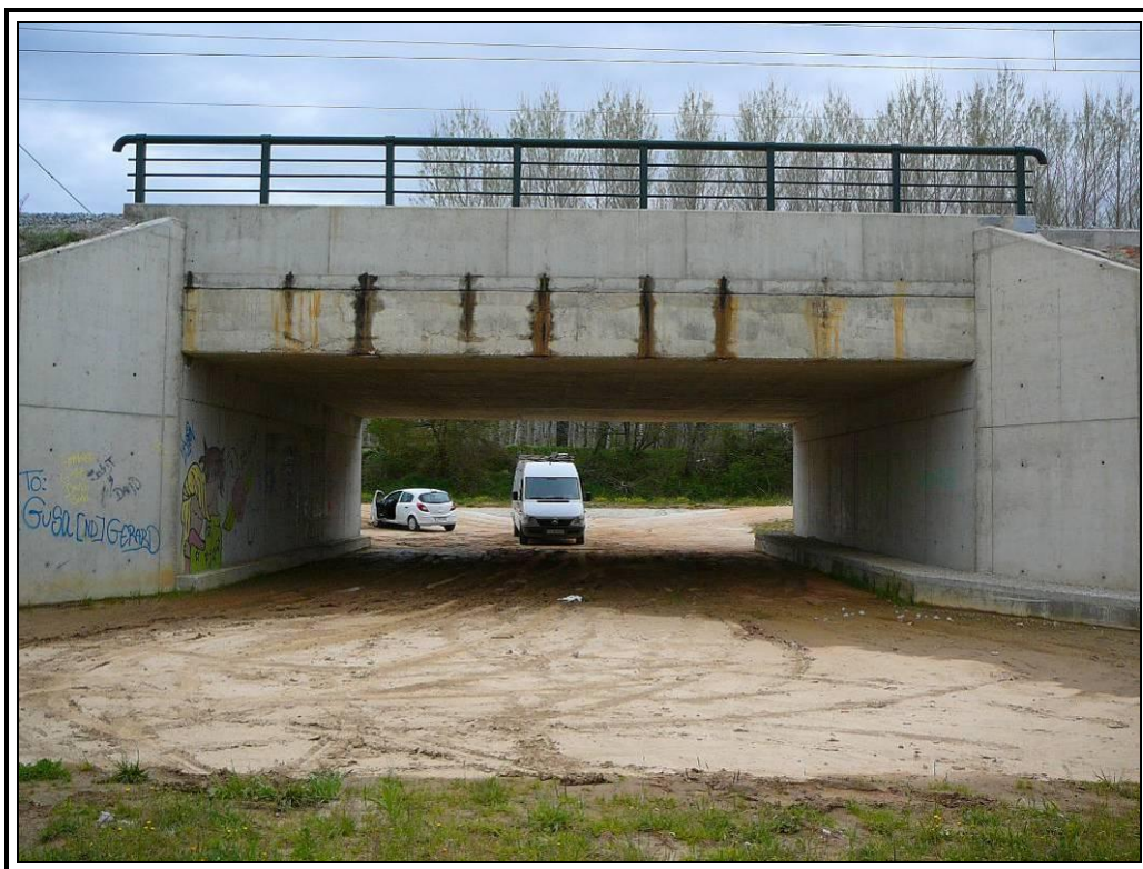
Vista general de las filtraciones (alzado derecho)
