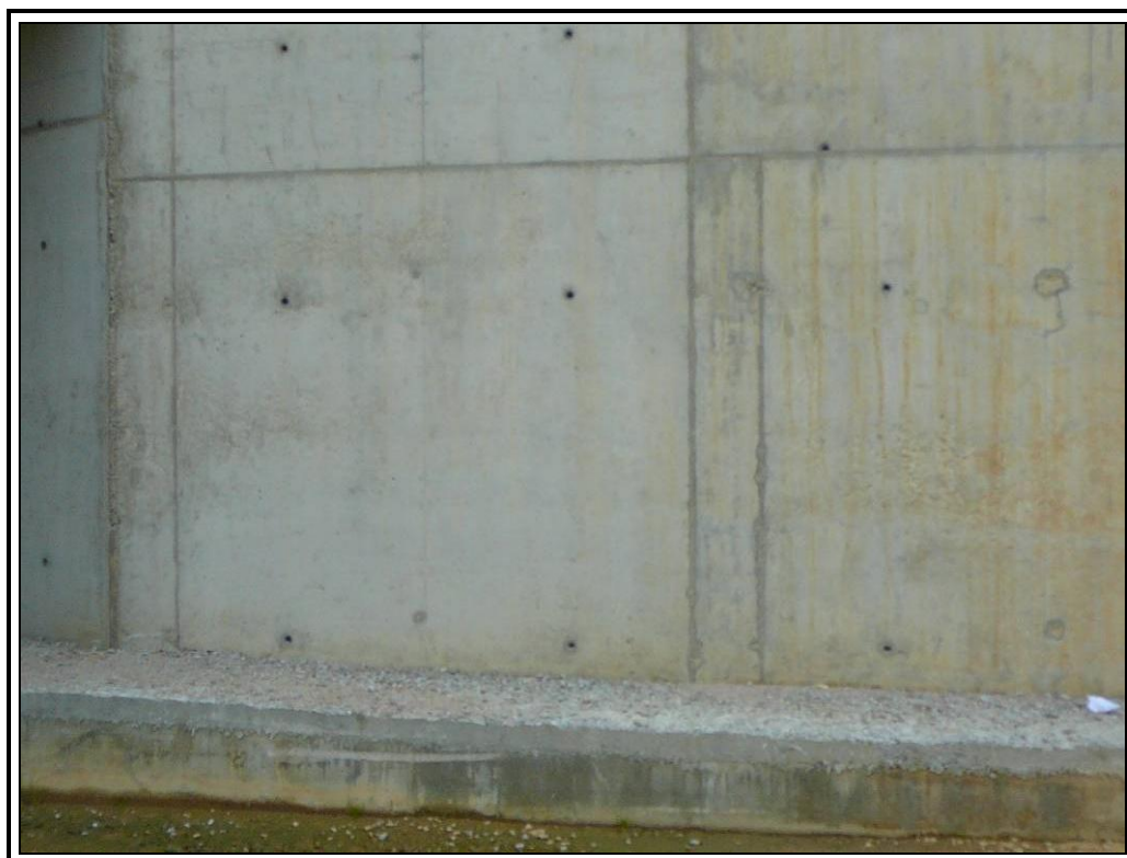
Degradación superficial de aleta derecha del hastial dos
