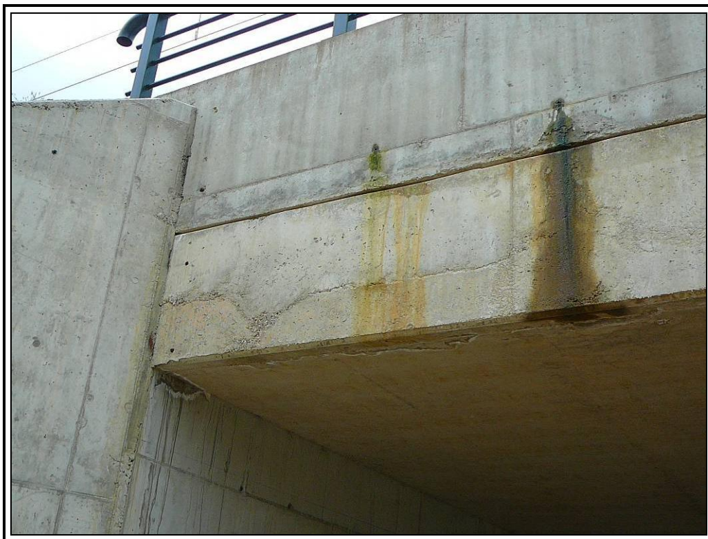
Nidos de grava y filtraciones en canto de dintel (acceso izquierdo)
