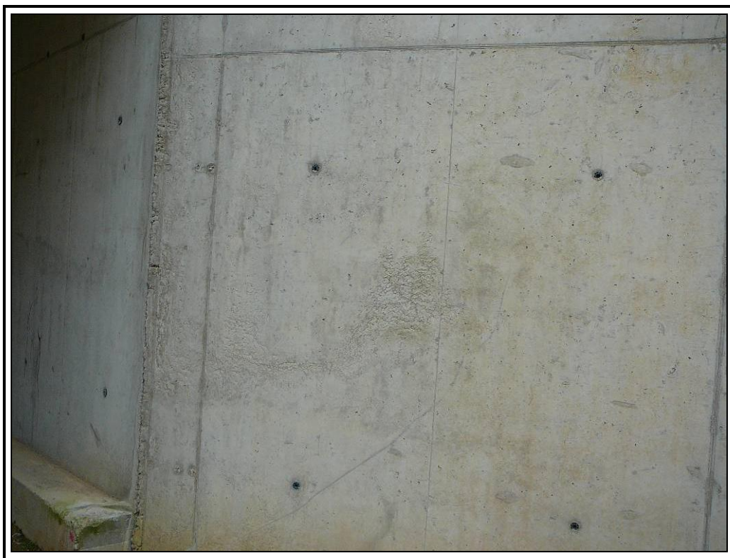
Degradación superficial en aleta derecha del hastial uno
