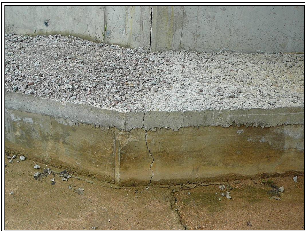
Fisura en "banda seca" coincidente con junta entre hastial dos y aleta izquierda
