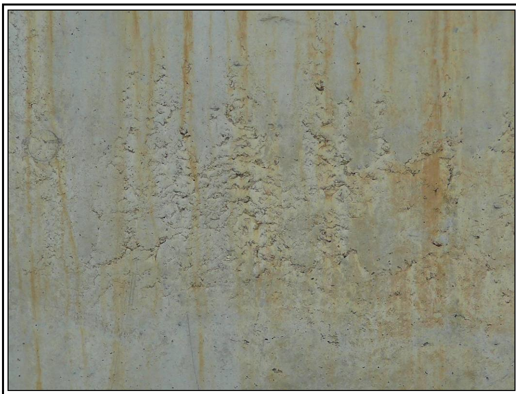
Detalle del deterioro anterior
