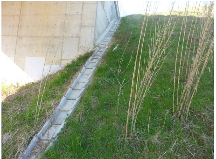
Fotografía N°20: Existencia de bajantes en ambos estribos.
