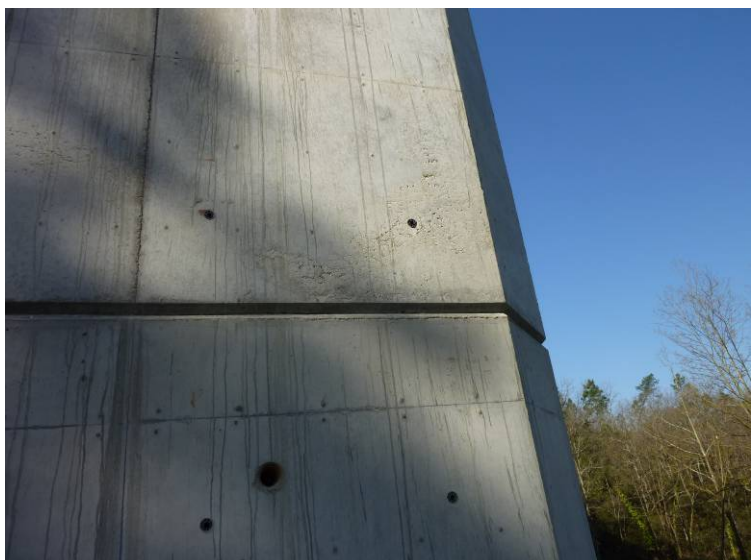
Fotografía N°27: Nidos de grava en pila 2.
