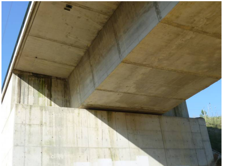
Fotografía N°17: Humedades por filtración.
