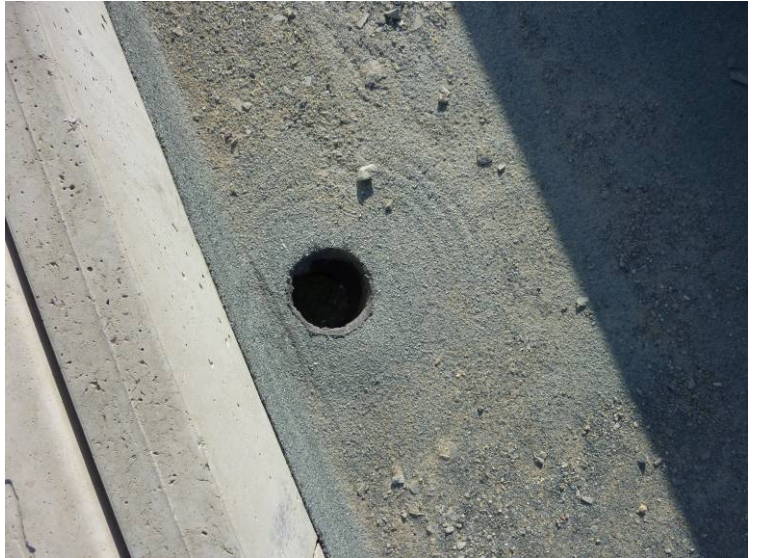
Fotografía N°13: Detalle de un imbornal sin rejilla.
