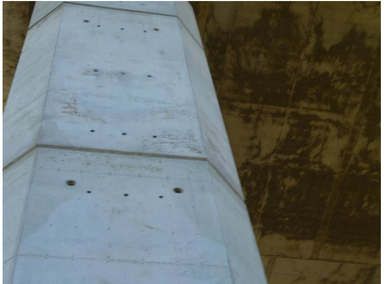
Fotografía N°25: Nidos de grava en pila 2.
