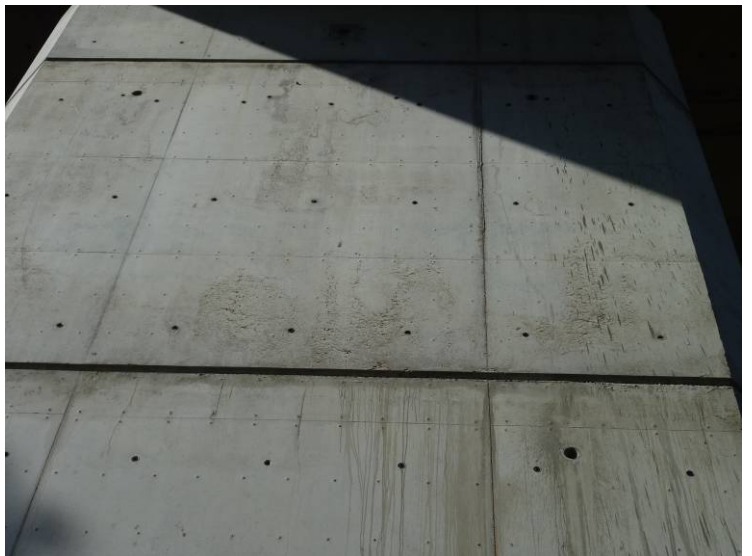
Fotografía N°26: Nidos de grava en pila 2.
