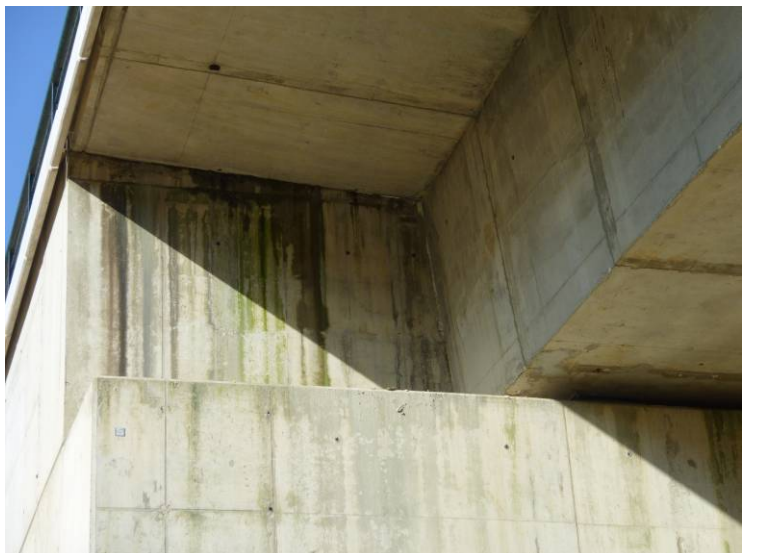
Fotografía N°18: Humedades por filtración.
