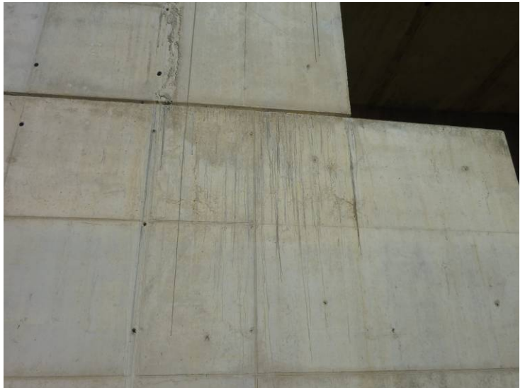
Fotografía N°19: Nido de grava en estribo 1.
