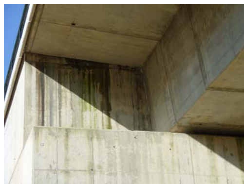
Fotografía nº 8. Humedades y eflorescencias en el estribo de entrada
