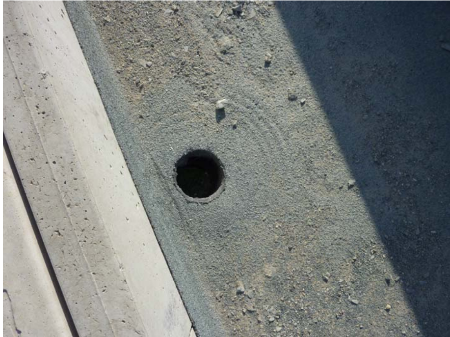
FOTOGRAFIA N° 13: Detalle de un imbornal sin rejilla
