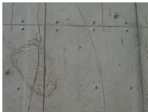
Fotografía nº 12. Nido de grava en la pila nº 6
