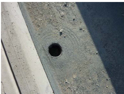
Fotografía nº 7. Imbornal sin rejilla de protección
