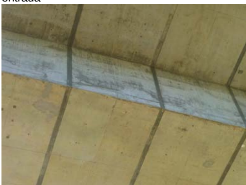
Fotografía nº 11. Nido de grava en el cajón del vano nº 7
