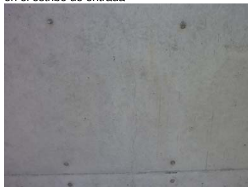
Fotografía nº 10. Fisura en la pila nº 1
