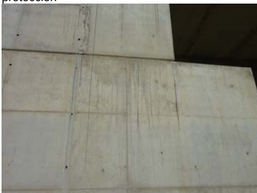
Fotografía nº 9. Nido de grava en el estribo de entrada
