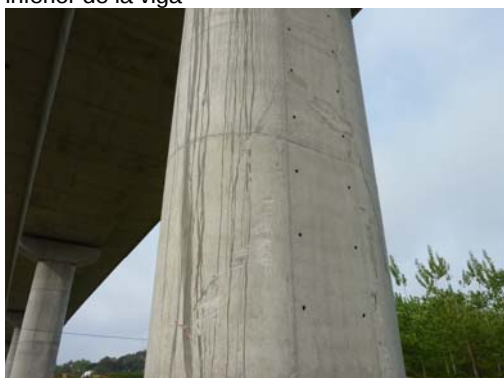
Fotografía nº 11. Desconchón en la cara lateral de la pila nº 11
