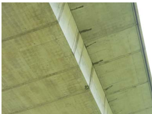
Fotografía nº 7. Insuficiente longitud del drenaje del tablero
