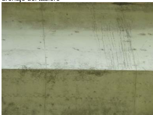
Fotografía nº 9. Nido de grava en la cara inferior de la viga
