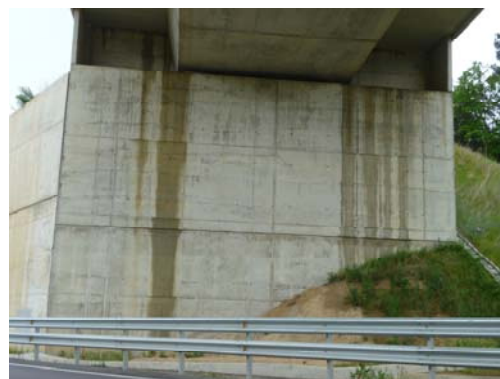
Fotografía nº 8. Humedades en el estribo de entrada
