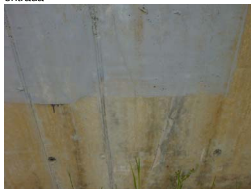
Fotografía nº 10. Fisura vertical en el estribo de entrada
