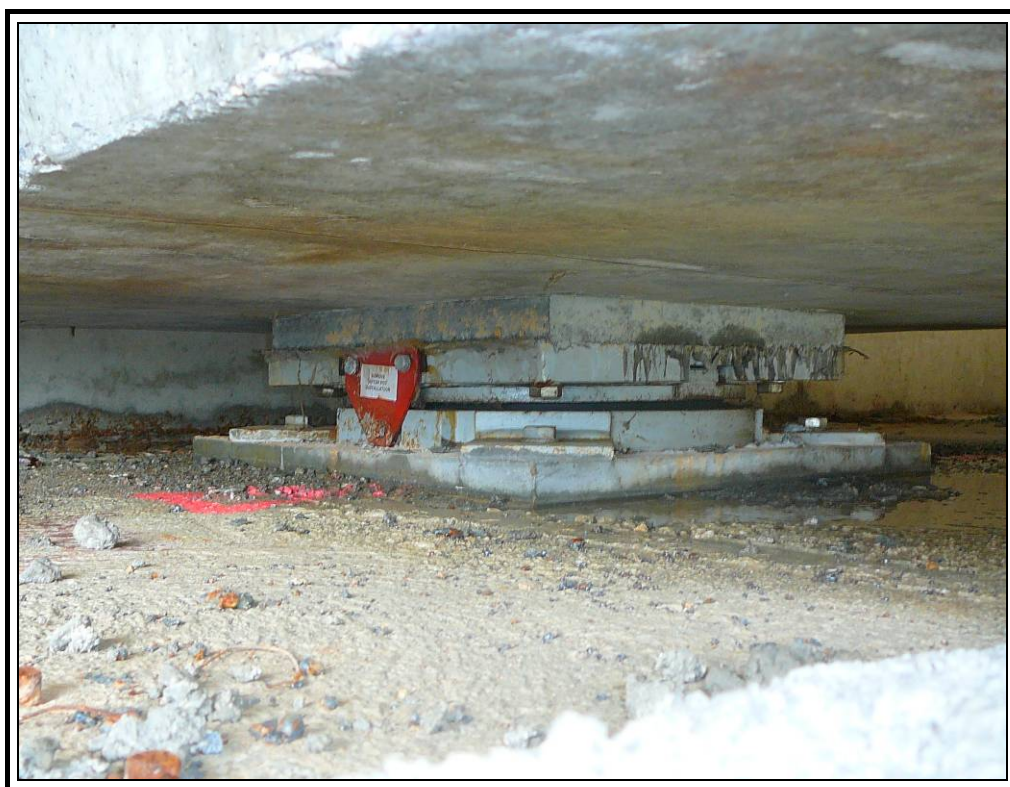
Placas de montaje de apoyos sin retirar
