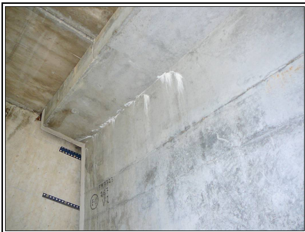
Fisuras con eflorescencias en el encuentro ala-alma de artesa izquierda, arranque de vano uno
