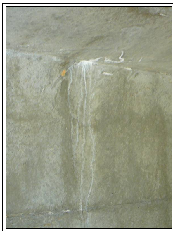
Fisuras con eflorescencias en el encuentro ala-alma de artesa derecha, arranque de vano uno
