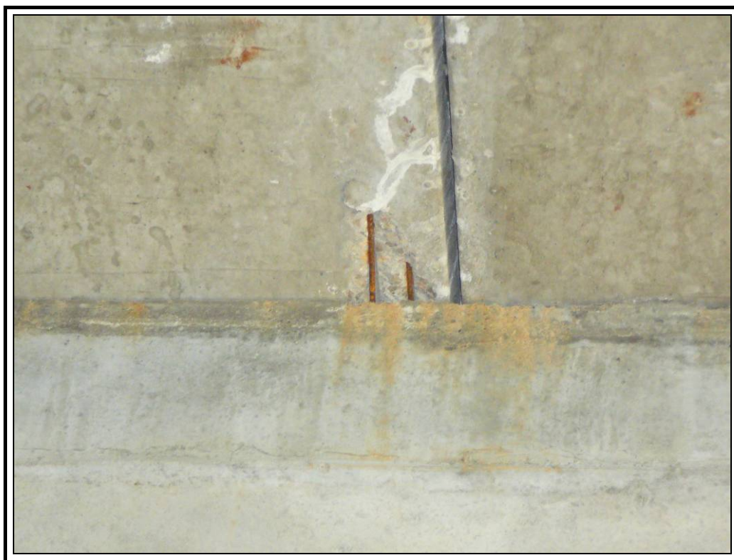
Desconchón con armadura vista en placa de encofrado colaborante, vano uno
