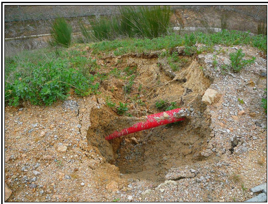
Cárcava en terraplén izquierdo de estribo uno
