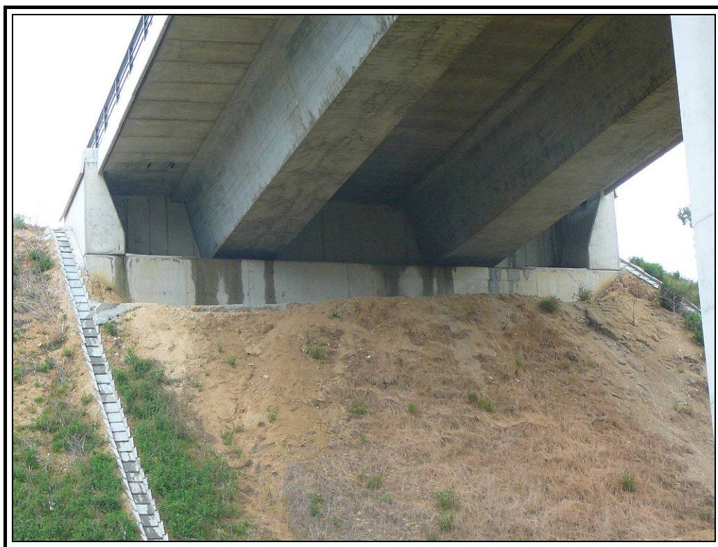
Filtraciones en estribo 2
