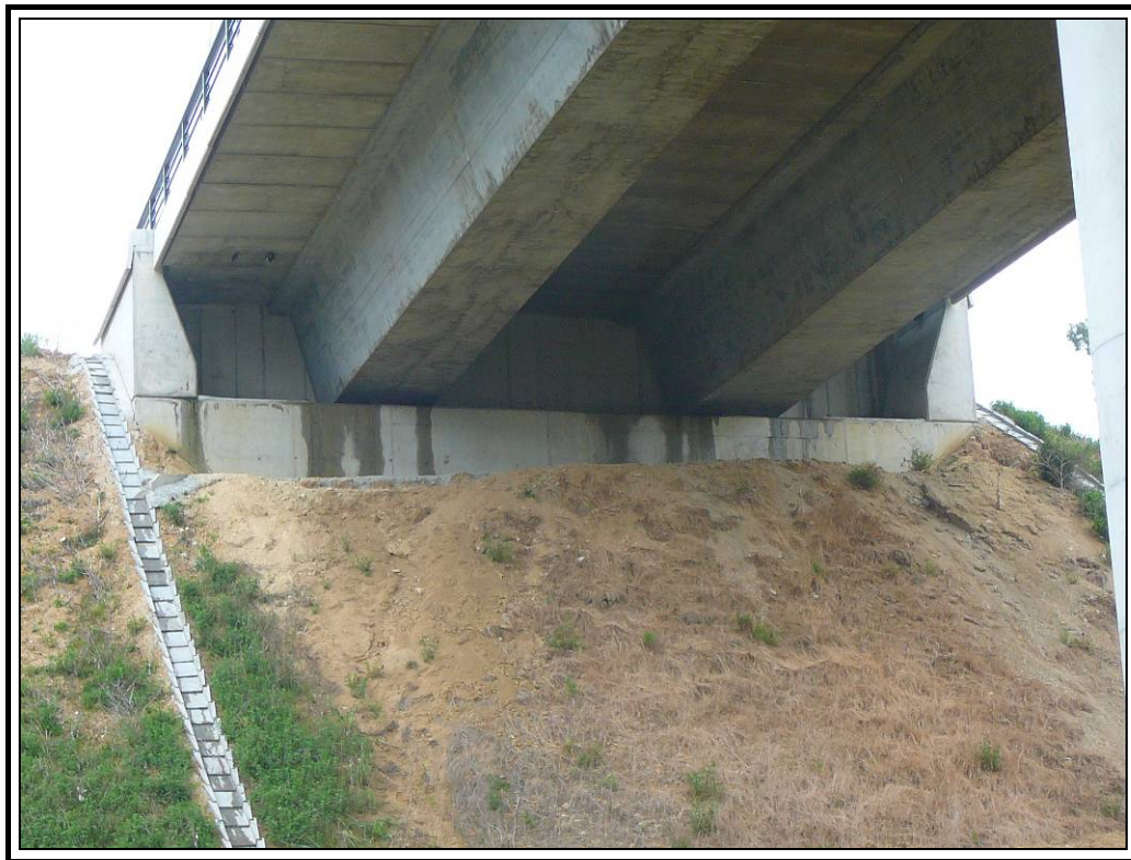
Filtraciones en estribo 2
