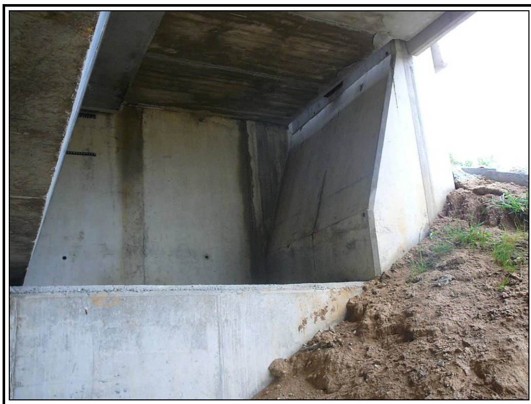
Filtraciones en estribo 1
