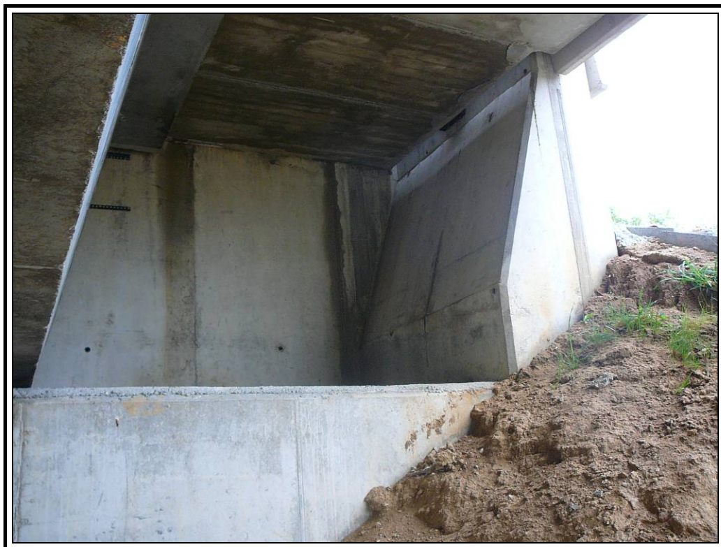
Filtraciones en estribo 1
