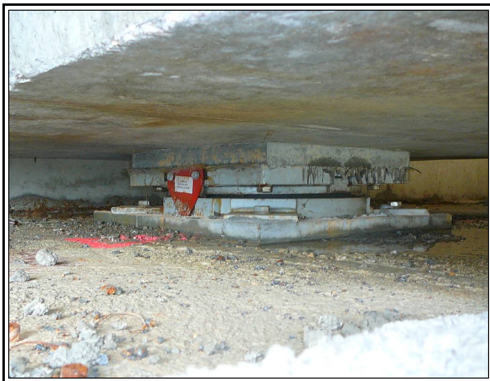
Placas de montaje de apoyos sin retirar
