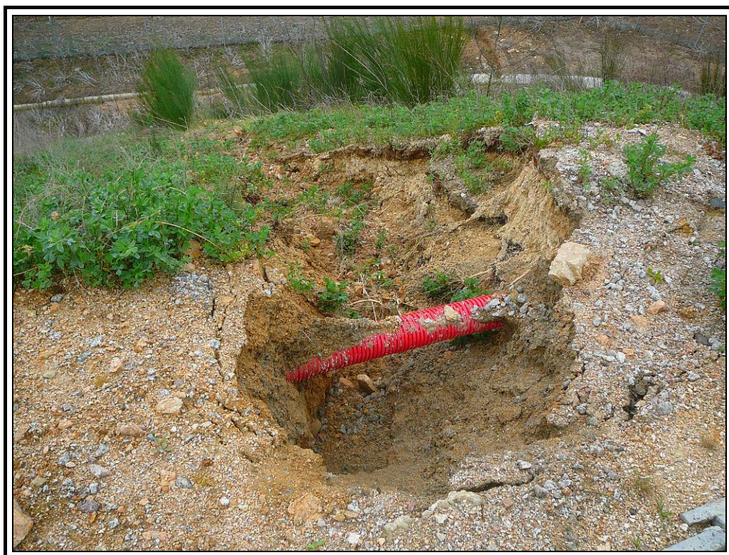
Cárcava en terraplén izquierdo de estribo uno
