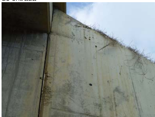
Fotografía nº 9. Nido de grava en la aleta derecha del estribo de salida
