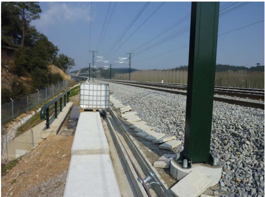
Fotografía 506: Vista del lado izquierdo de la plataforma
