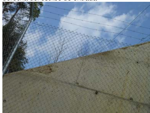
Fotografía nº 12. Nido de grava en la aleta izquierda del estribo de salida
