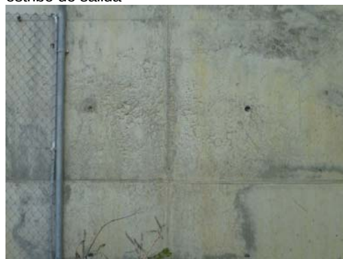
Fotografía nº 10. Nido de grava en la aleta derecha del estribo de entrada
