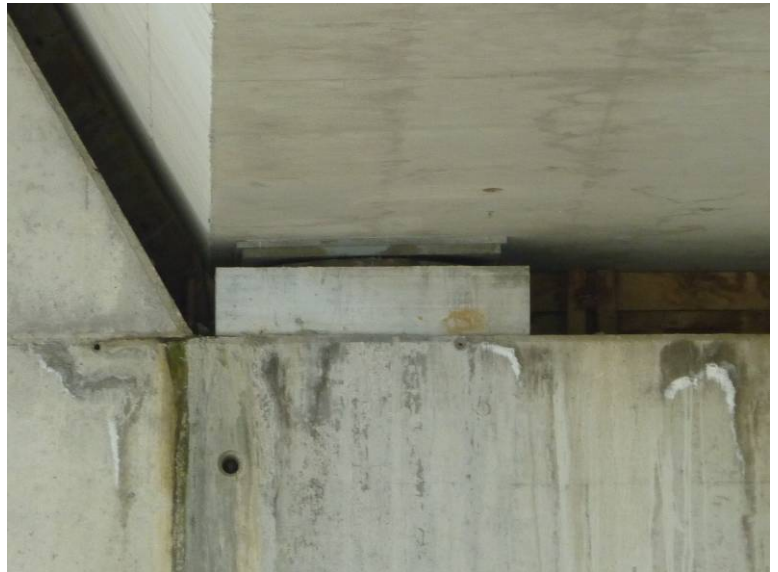
Fotografía N°7: Detalle apoyo tipo Pot en estribo.
