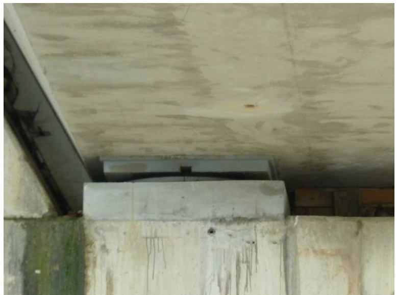
Fotografía N°8: Detalle apoyo tipo Pot en estribo.
