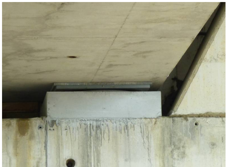
Fotografía N°9: Detalle apoyo tipo Pot en estribo.
