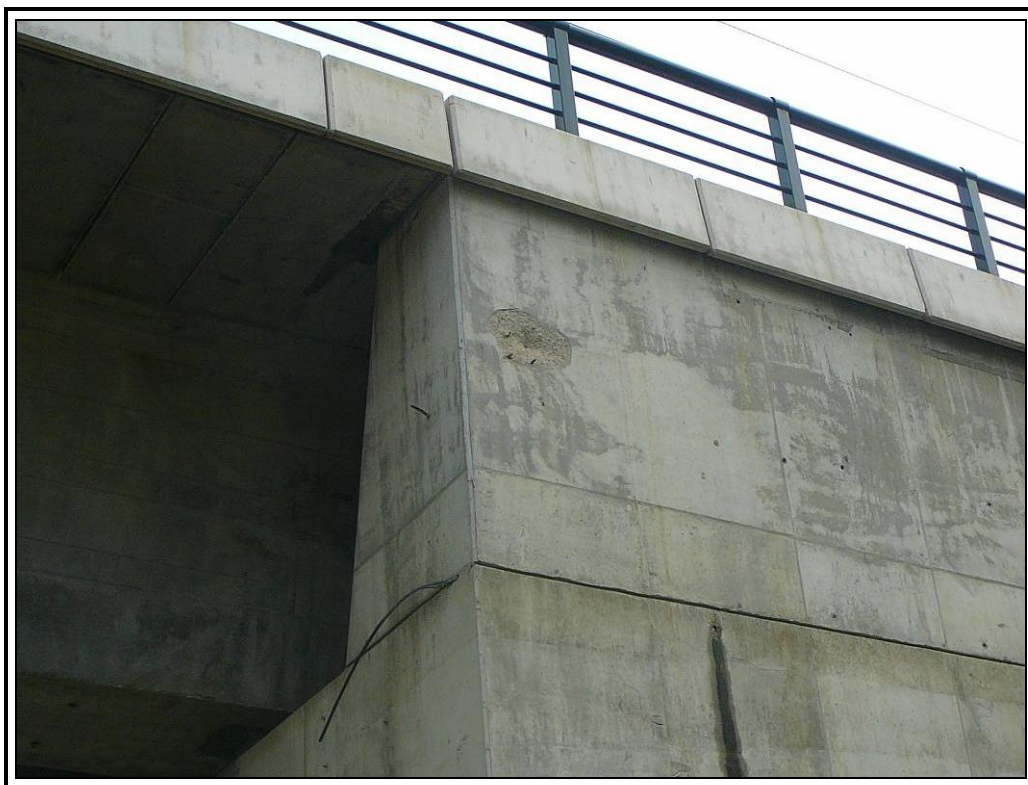
Desconchón en vértice superior izquierdo de muro lateral izquierdo
