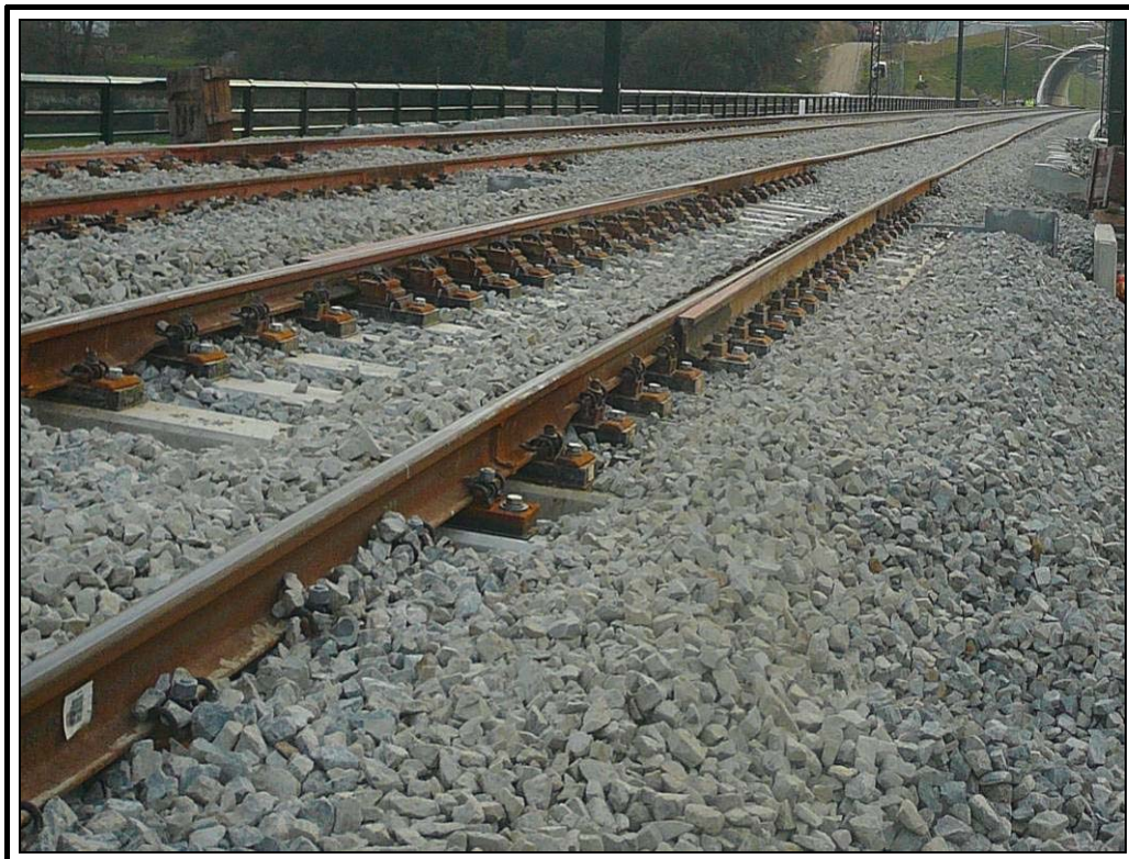
Material de vía (aparato de dilatación, estribo de salida)
