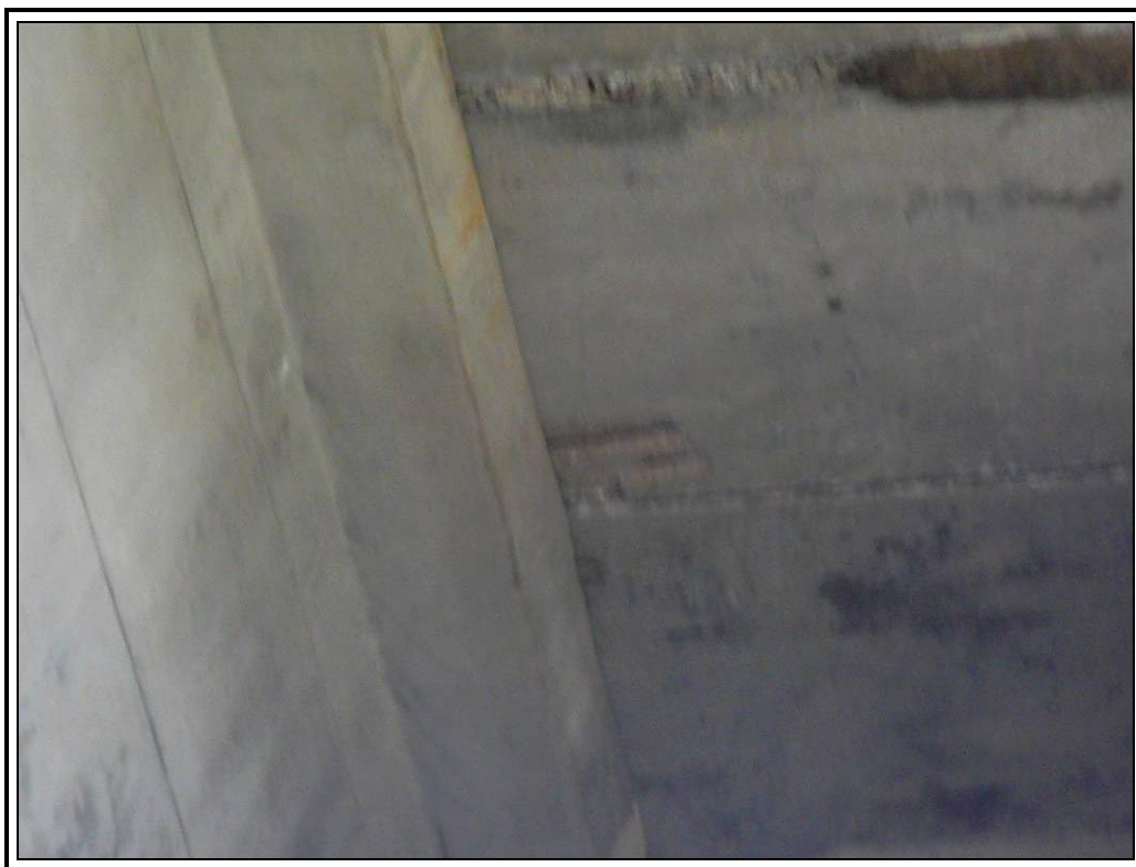
Desconchón con armadura vista en vano cuatro, cerca de estribo dos
