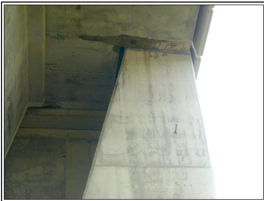
Humedades en estribo uno
