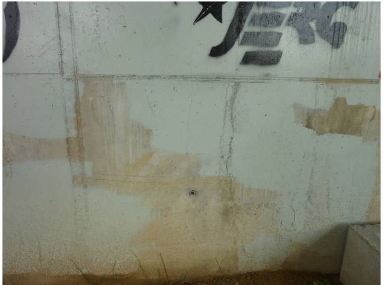
Fotografía N°16: Fisuras en el hastial de salida.
