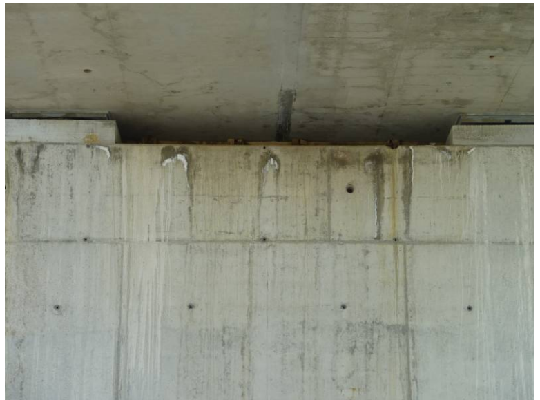
Fotografía N°11: Eflorescencias en estribo.
