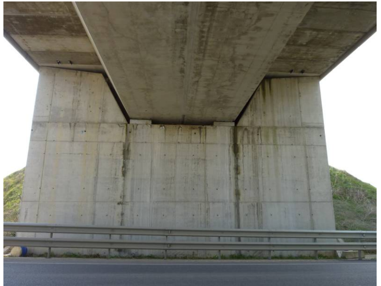
Fotografía N°10: Detalle humedades por filtra- ción en estribo.
