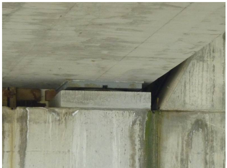
Fotografía N°6: Detalle apoyo tipo Pot en estribo.
