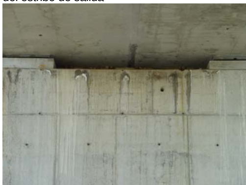
Fotografía nº 9. Eflorescencias en el muro de frente del estribo de entrada
