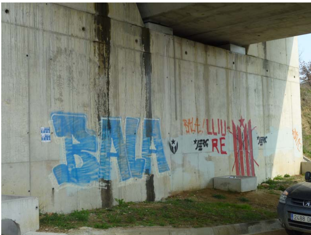
Pintadas en el estribo de salida
