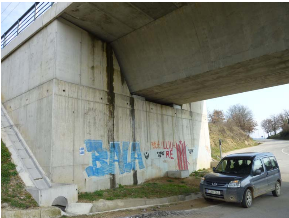
Humedades y pintadas en el estribo de salida
