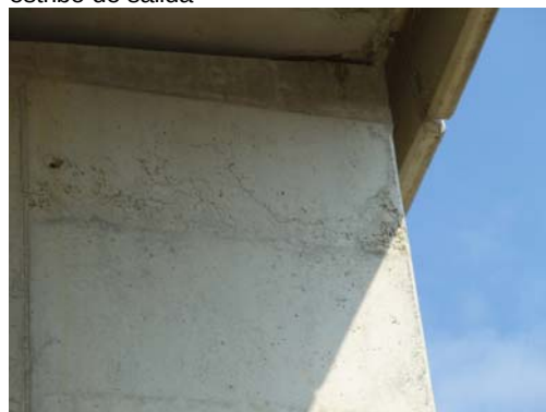
Fotografía nº 10. Nido de grava en el muro de frente del estribo de salida.
