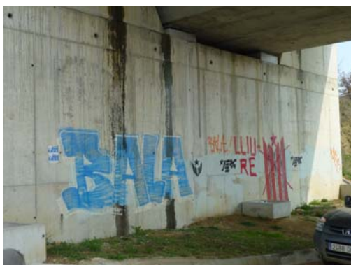
Fotografía nº 7. Pintadas en el muro de frente del estribo de salida
