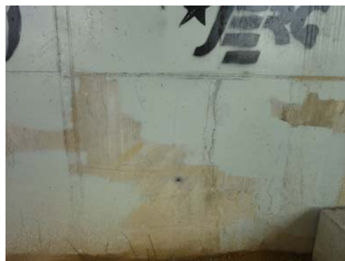
Fotografía nº 8. Nido de grava en el hastial del estribo de salida
