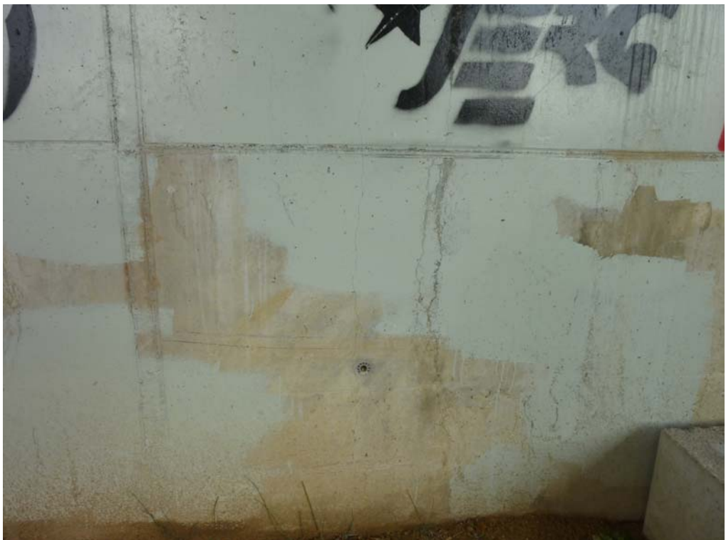
Fisuras en el hastial de salida
