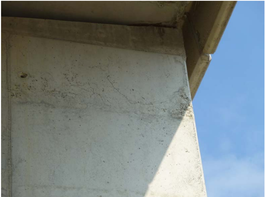
Nidos de grava en el estribo de salida
