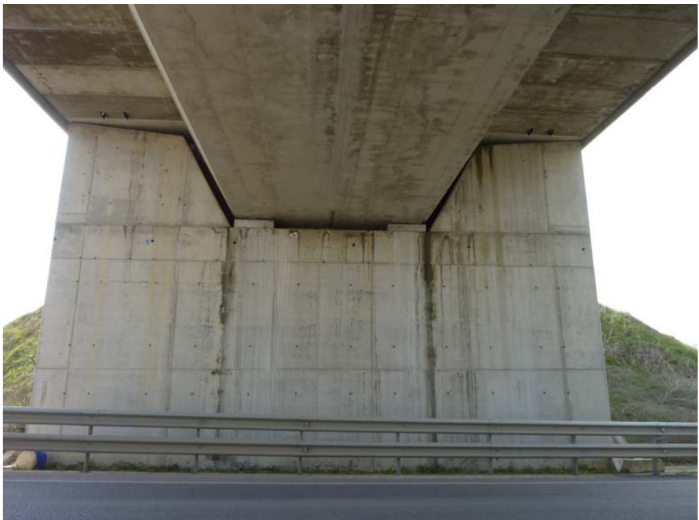
Humedades por filtración
