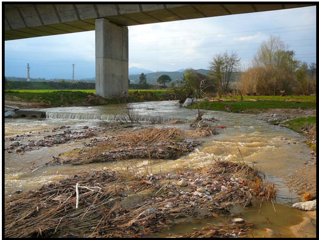
20. Erosión en la margen izquierda de aguas abajo, tras la crecida del río.
