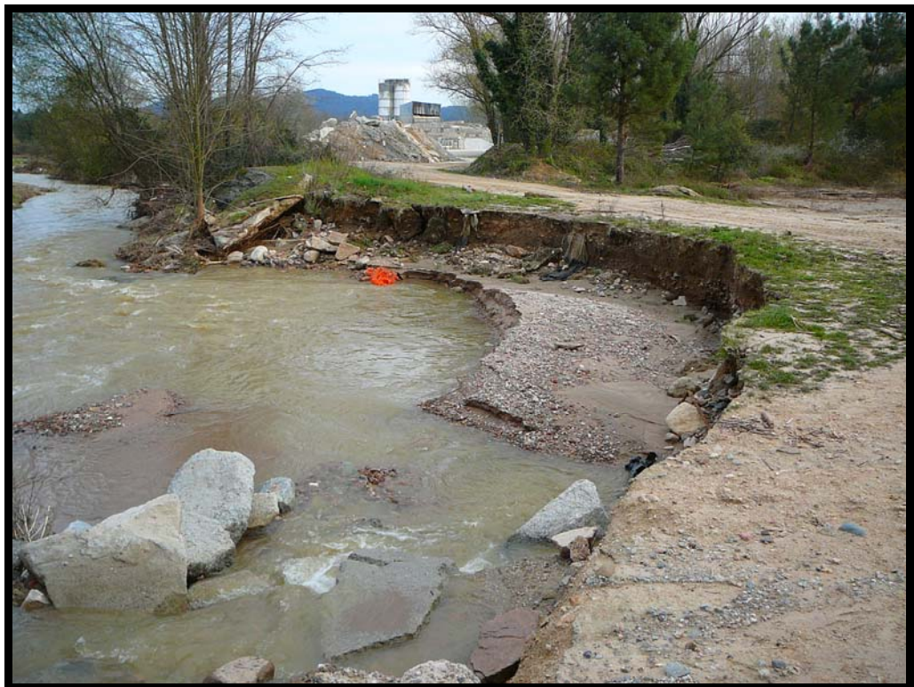
18. Erosión en margen derecha de aguas abajo, tras a la crecida del río.
