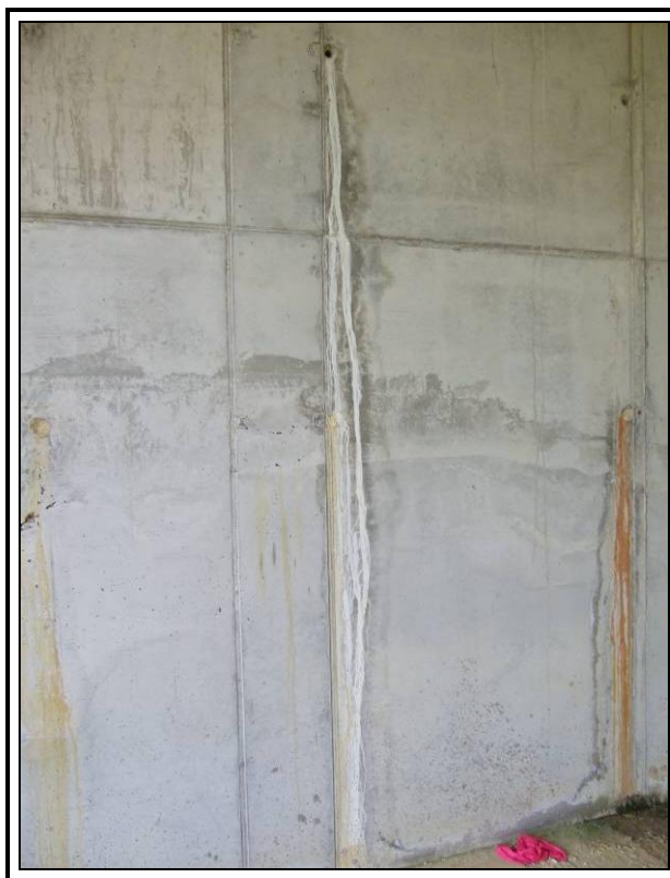
Filtración con eflorescencia en hastial 2.
