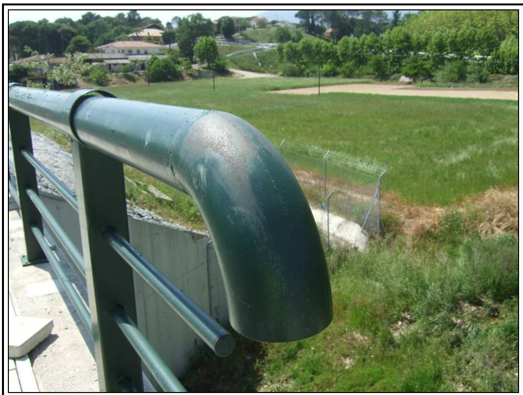
Oxido en barandilla.
