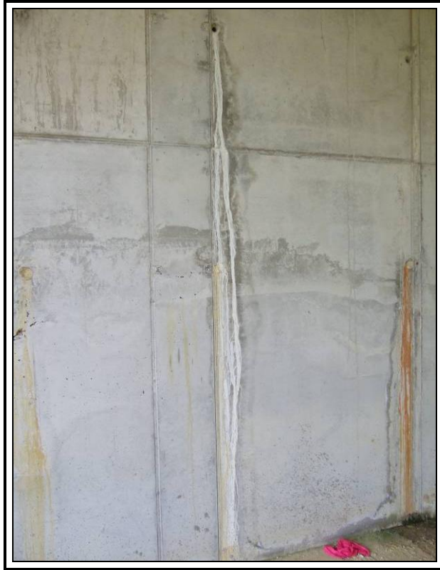
Filtración con eflorescencia en hastial 2.
