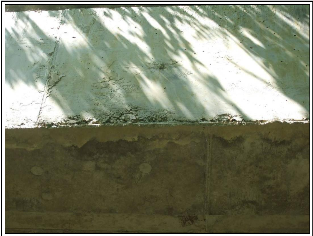
Nido de grava en dintel de losa lado derecho.
