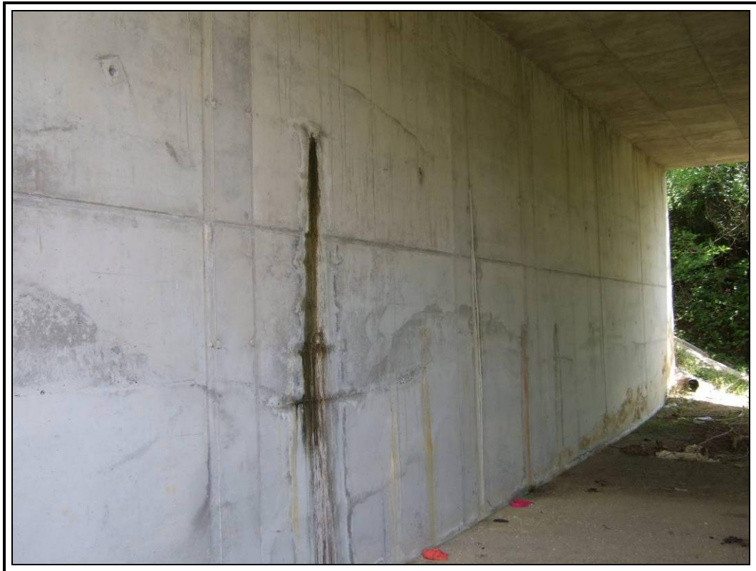
Filtración en hastial 2.
