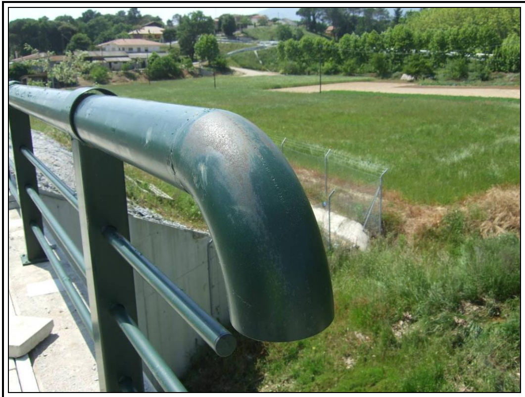
Oxido en barandilla.
