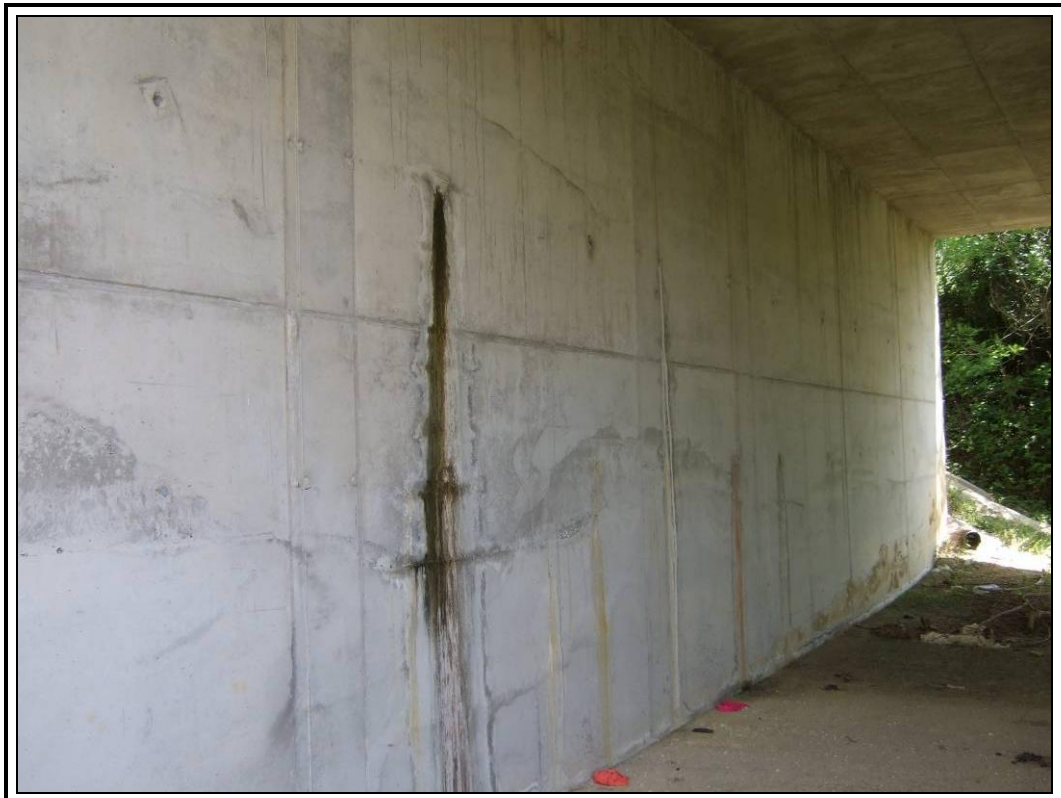
Filtración en hastial 2.
