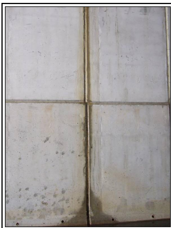
Filtraciones entre elementos de hastial dos
