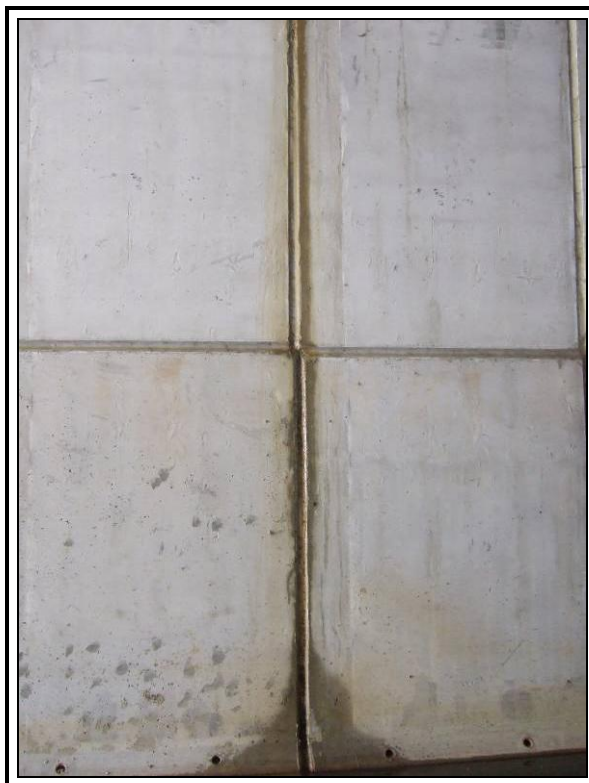
Filtraciones entre elementos de hastial dos
