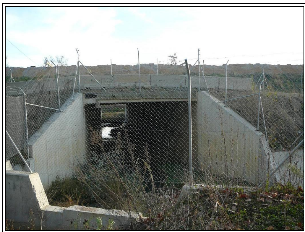
Acumulación de vegetación en embocadura izquierda
