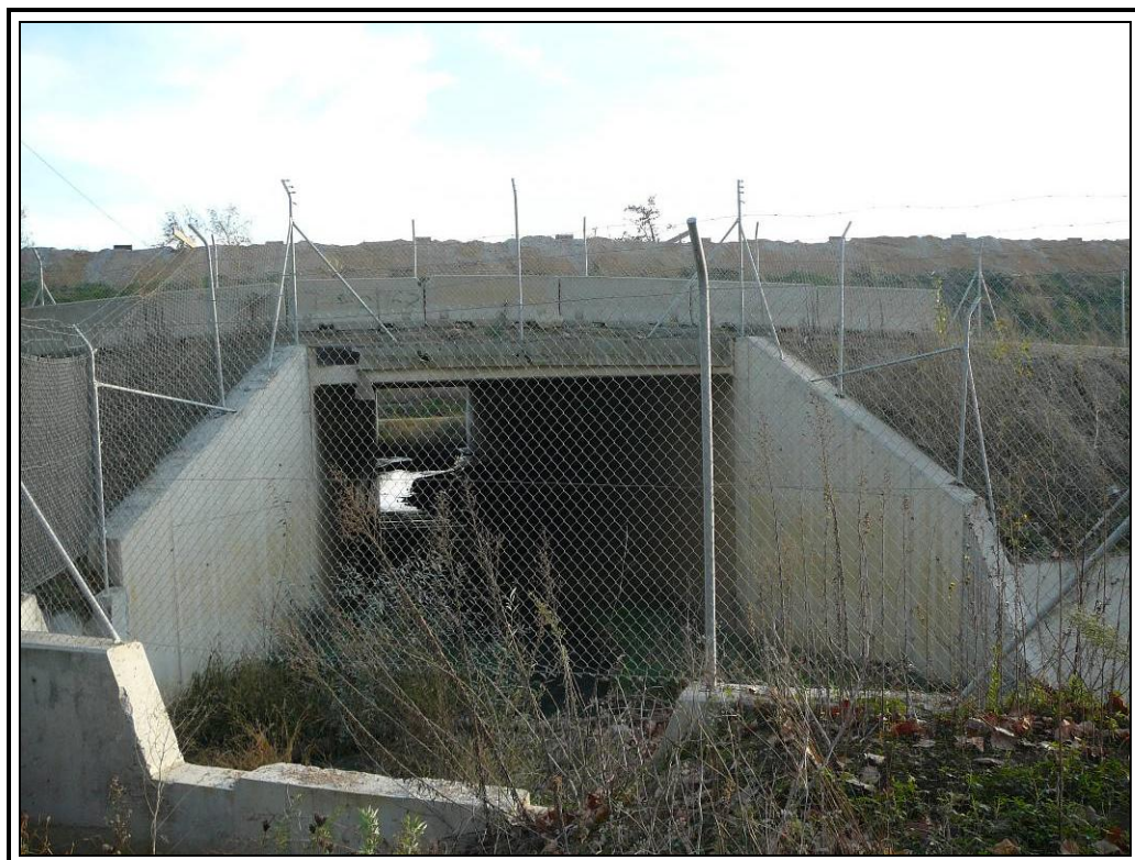
Acumulación de vegetación en embocadura izquierda
