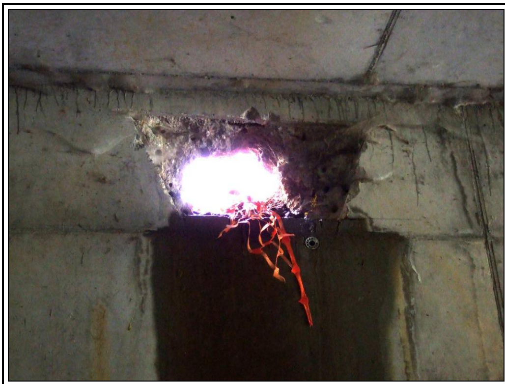
Orificio en paramento de hastial dos.
