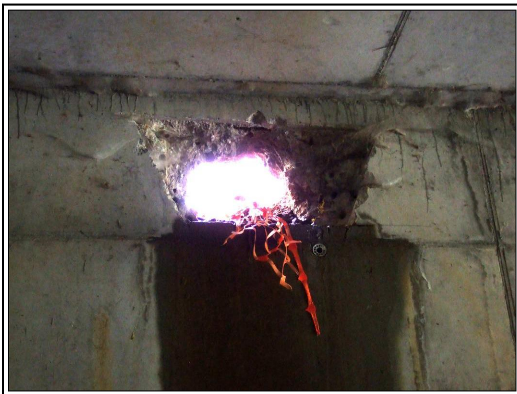
Orificio en paramento de hastial dos.
