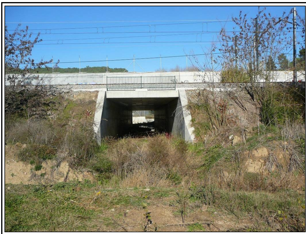
Acumulación de vegetación a la salida de la obra de drenaje
