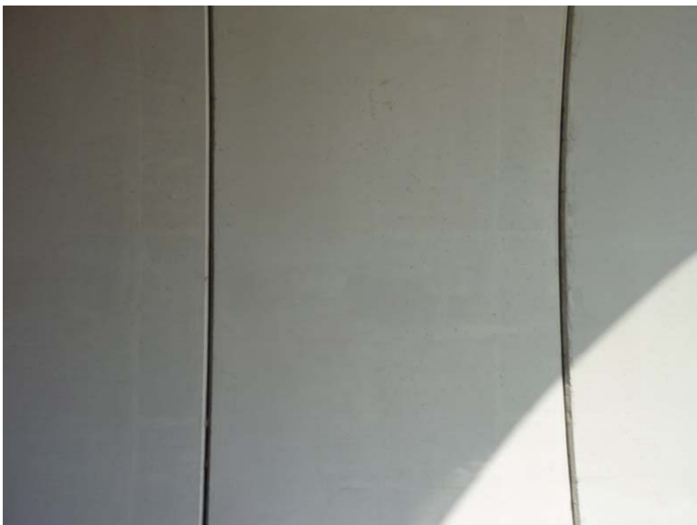
Fisura de retracción
