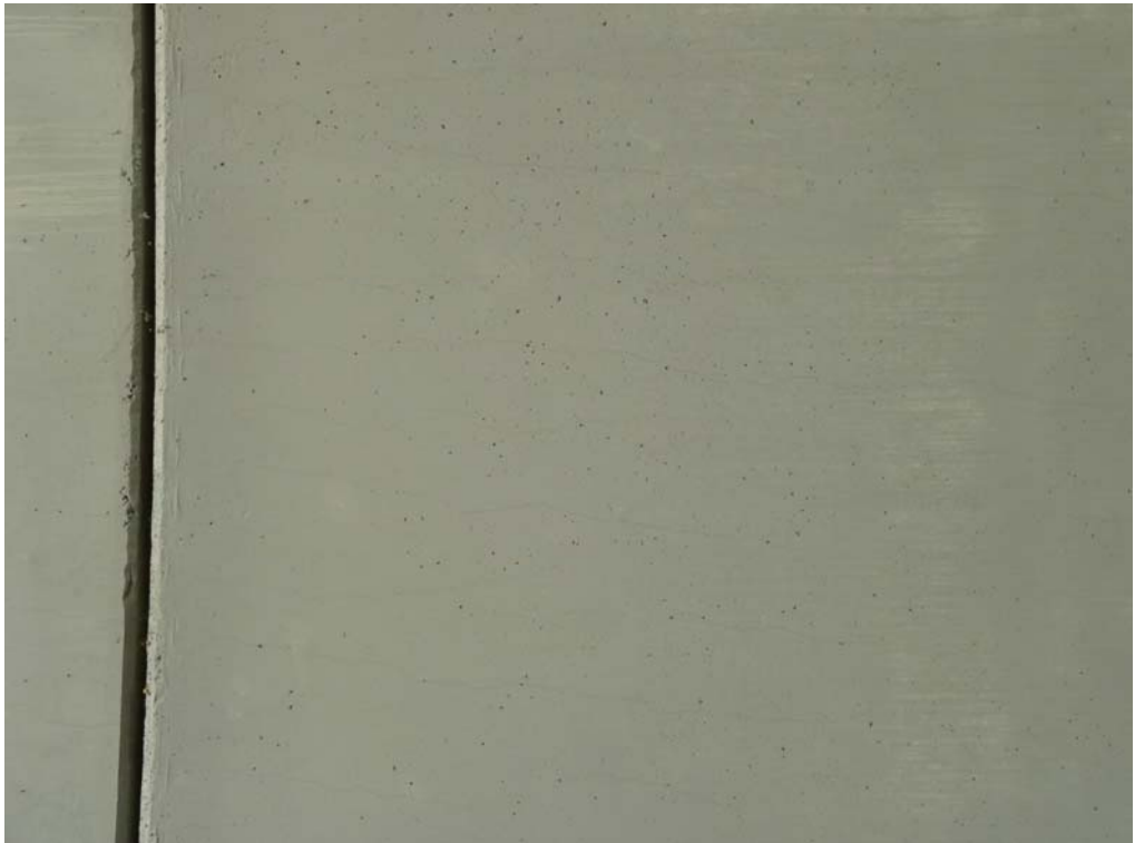
Fisura de retracción
