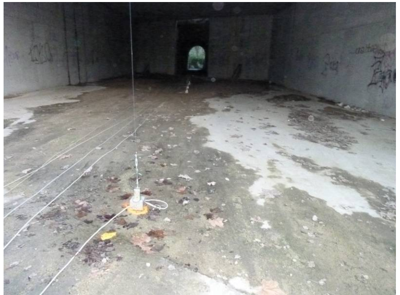
Fotografía N°1: Anillos en centro de vano.
