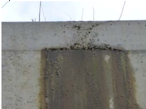
Fotografía nº 11. Nido de grava en la cara lateral izquierda de la losa superior.
