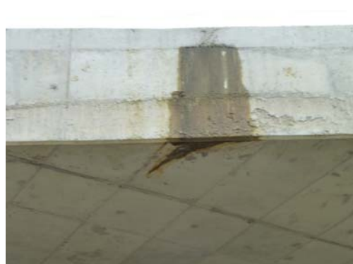
Fotografía nº 12. Humedades en la cara lateral derecha de la losa superior.
