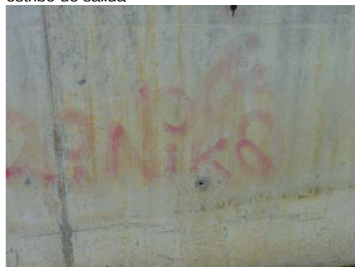
Fotografía nº 10. Fisura en la aleta izquierda del estribo de entrada
