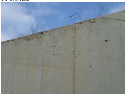
Fotografía nº 9. Nido de grava en la aleta izquierda del estribo de salida
