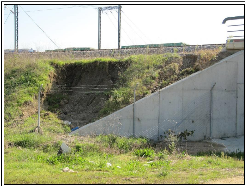
Erosión excesiva en terraplén tras aleta izquierda hastial 2.
