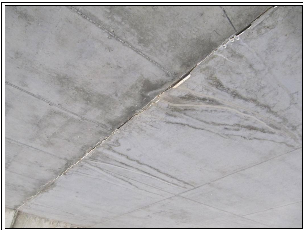
Filtraciones por la junta entre elementos del dintel
