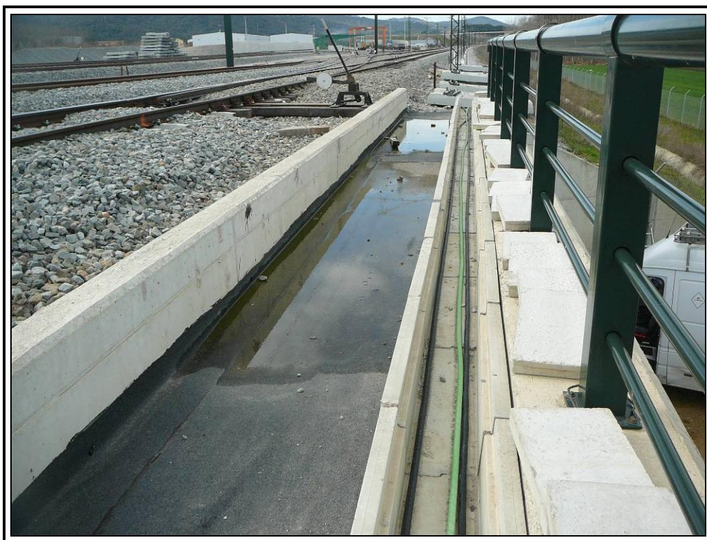
Acumulación de agua en paseos de servicio.
