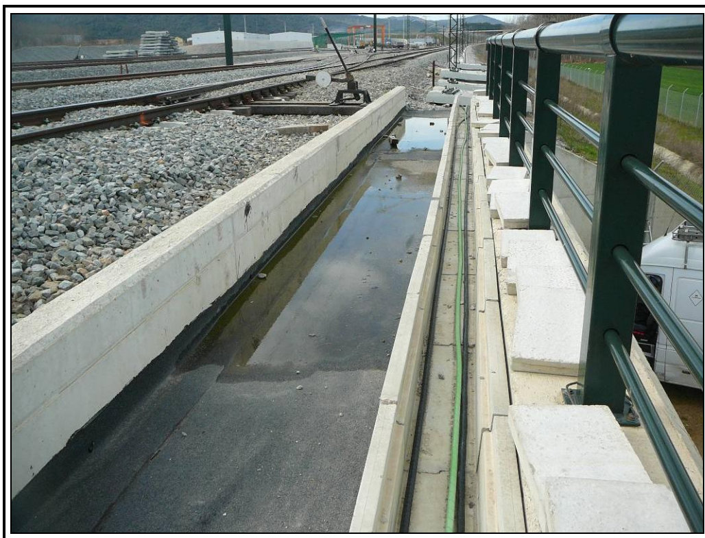
Acumulación de agua en paseos de servicio.
