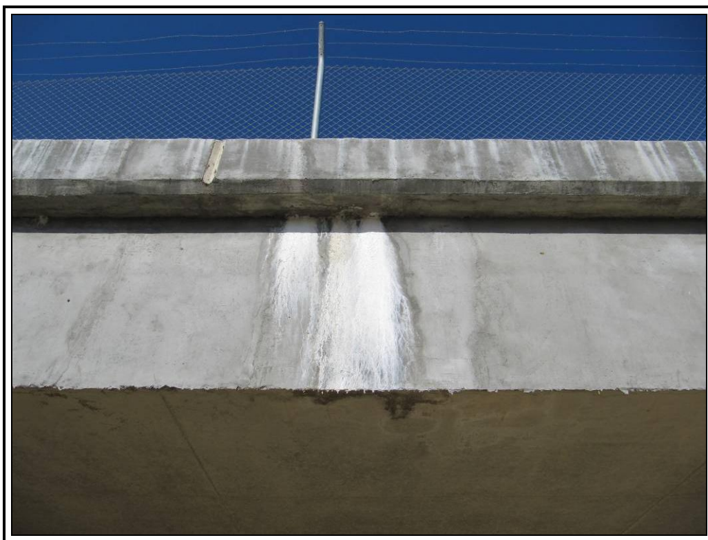
Filtraciones con efflorescencias bajo la imposta.
