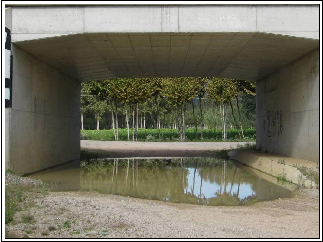
Acumulación de agua bajo la estructura.
