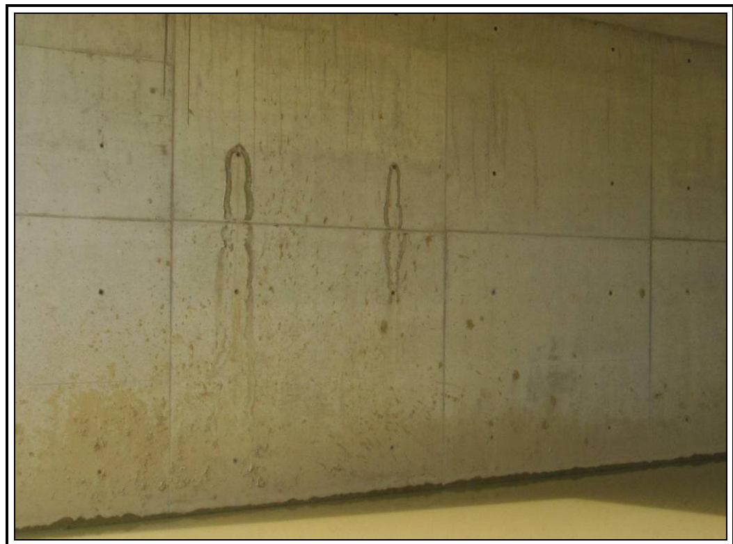
Filtraciones en estribo uno.
