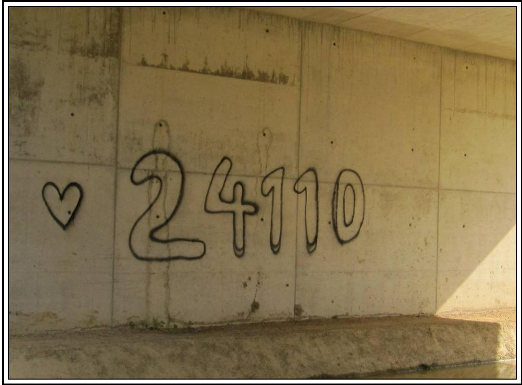
Filtraciones en estribo dos.
