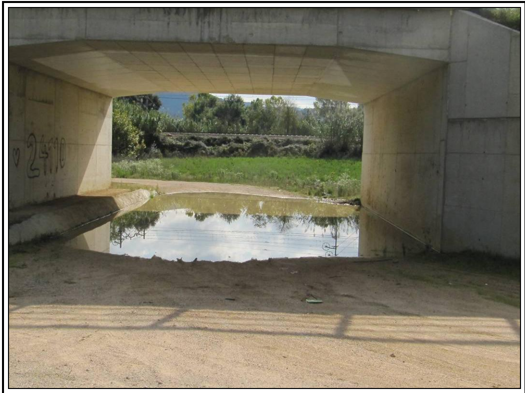
Acumulación de agua bajo la estructura.
