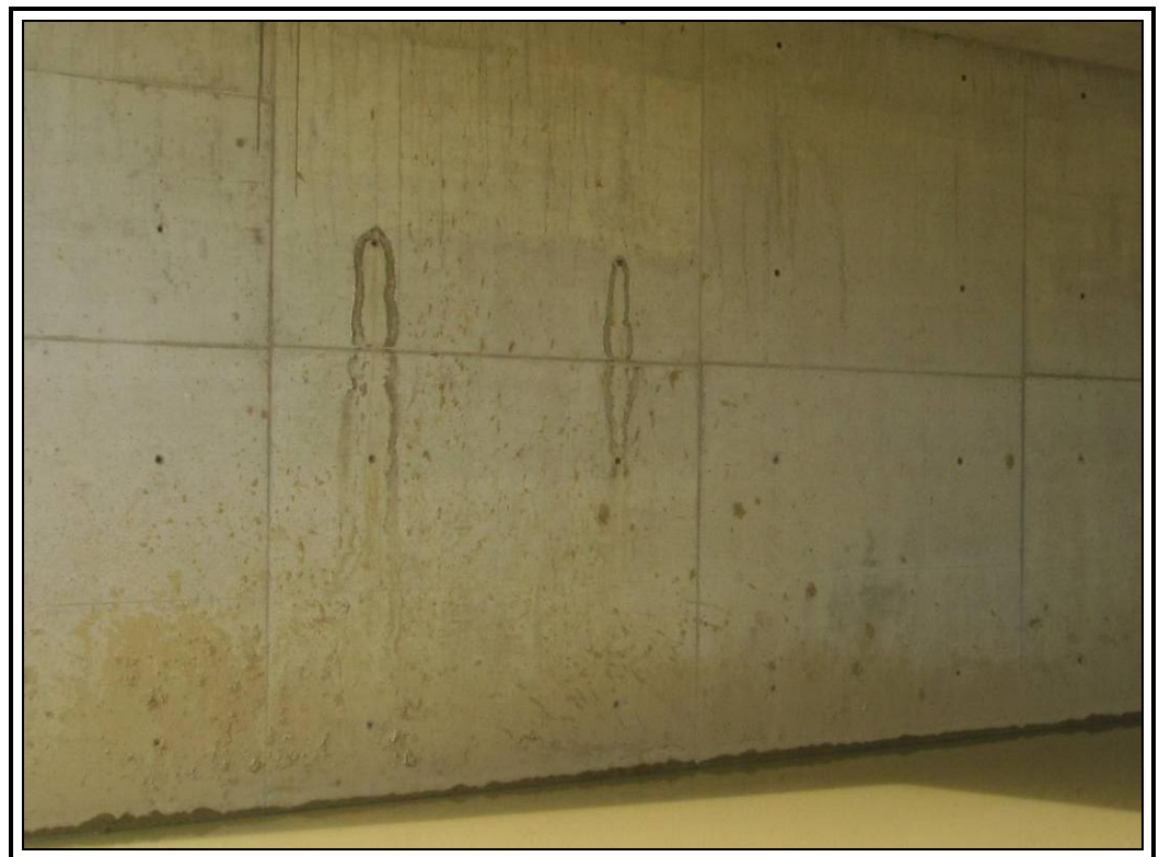
Filtraciones en estribo uno.
