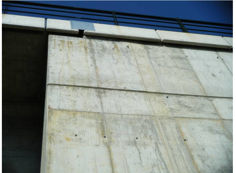
Fotografía N°28: Nido de grava en la aleta derecha del estribo 2
