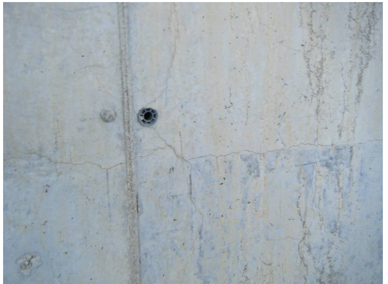
Fotografía N°20: Detalle de fisuras en mapa en el estribo 1
