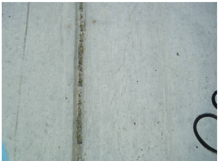
Fotografía N°21: Fisura en la pila 2 sobre la cara del vano 3
