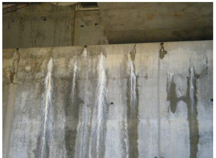
Fotografía N°15: Eflorescencias en el estribo 1
