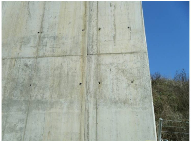
Fotografía N°26: Nido de grava en el estribo 2
