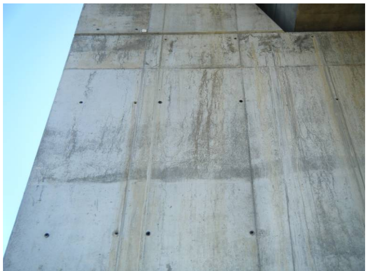
Fotografía N°27: Nido de grava en el estribo 2
