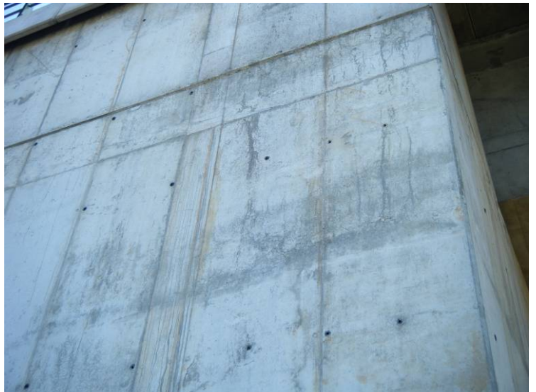
Fotografía N°29: Nido de grava en la aleta izquierda del estribo 2
