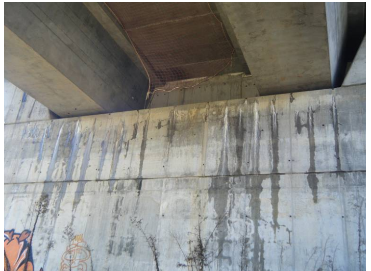
Fotografía N°14: Humedades y eflorescencias en el estribo 1
