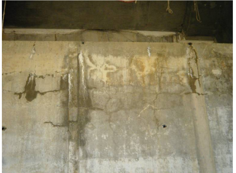
Fotografía N°19: Detalle de fisuras en mapa en el estribo 1
