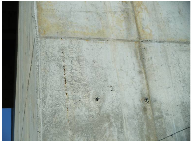
Fotografía N°17: Armadura vista en la aleta de- recha del estribo 2
