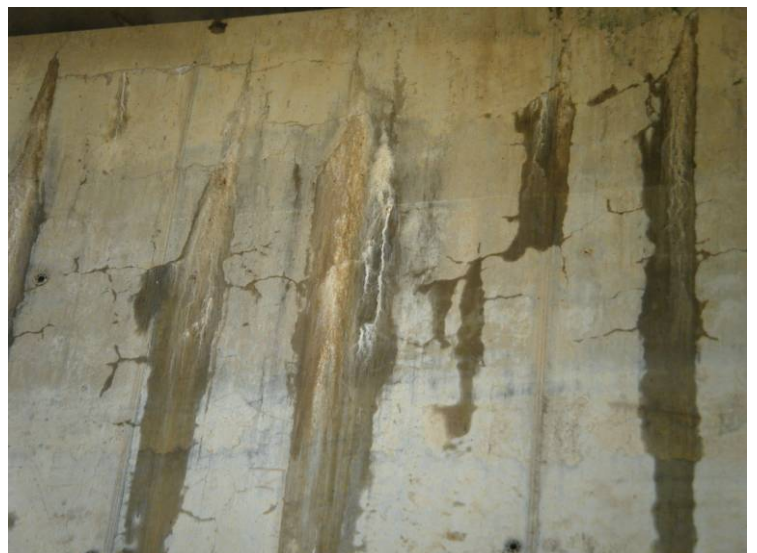
Fotografía N°18: Fisuras en mapa en el estribo 1
