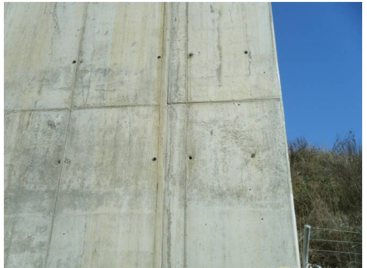
Fotografía N°26: Nido de grava en el estribo 2
