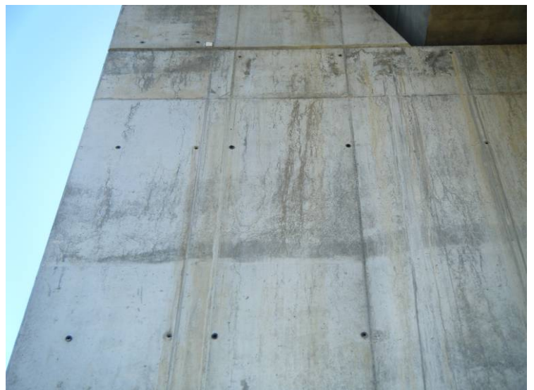
Fotografía N°27: Nido de grava en el estribo 2
