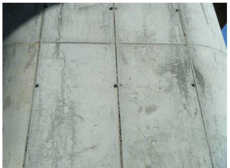
Fotografía N°24: Nido de grava en la pila 2 sobre la cara del vano 2
