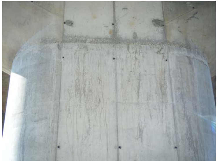
Fotografía N°25: Nido de grava en la pila 2 sobre la cara del vano 3
