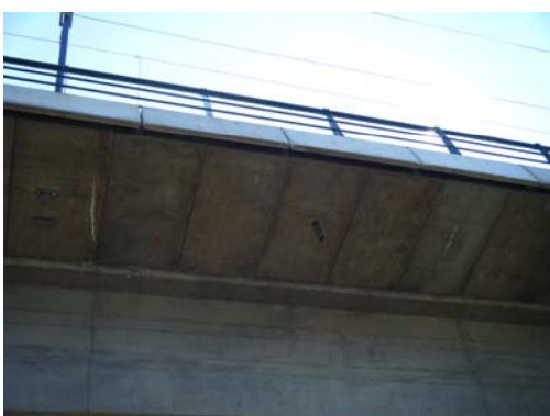
Fotografía nº 9. Eflorescencias en el voladizo de l vano 2
