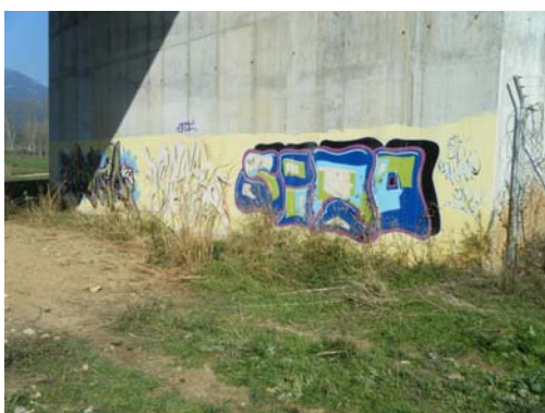
Fotografía nº 7. Pintadas en el estribo de salida
