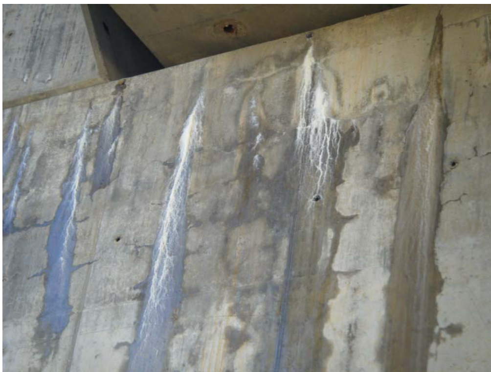
Fisuras en mapa E-1 (II)
