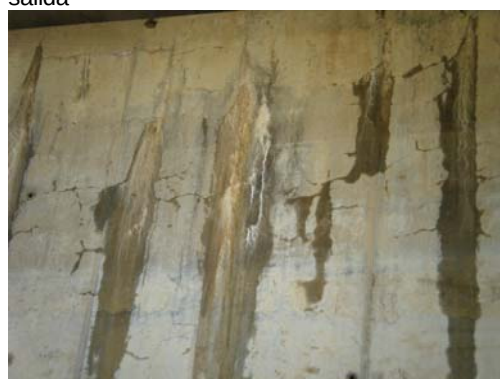
Fotografía nº 10. Fisuras en mapa, eflorescencias y humedades en el estribo 1
