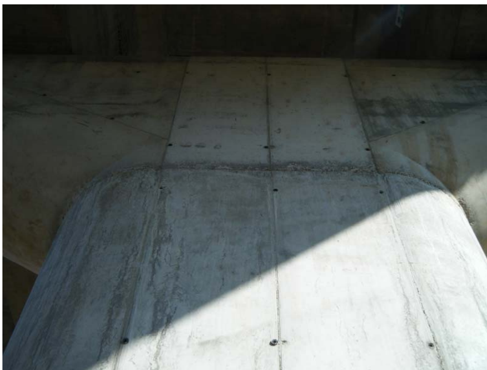
Nido de grava en la pila nº 2 cara vano nº 2
