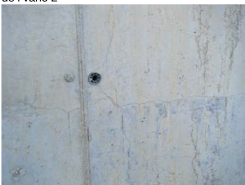
Fotografía nº 8. Fisura vertical en el estribo E-1
