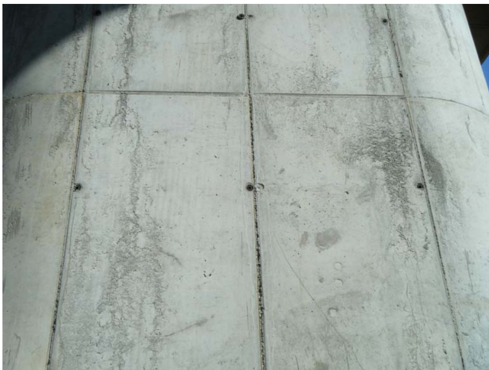
Nido de grava pila nº 2 cara vano nº 2
