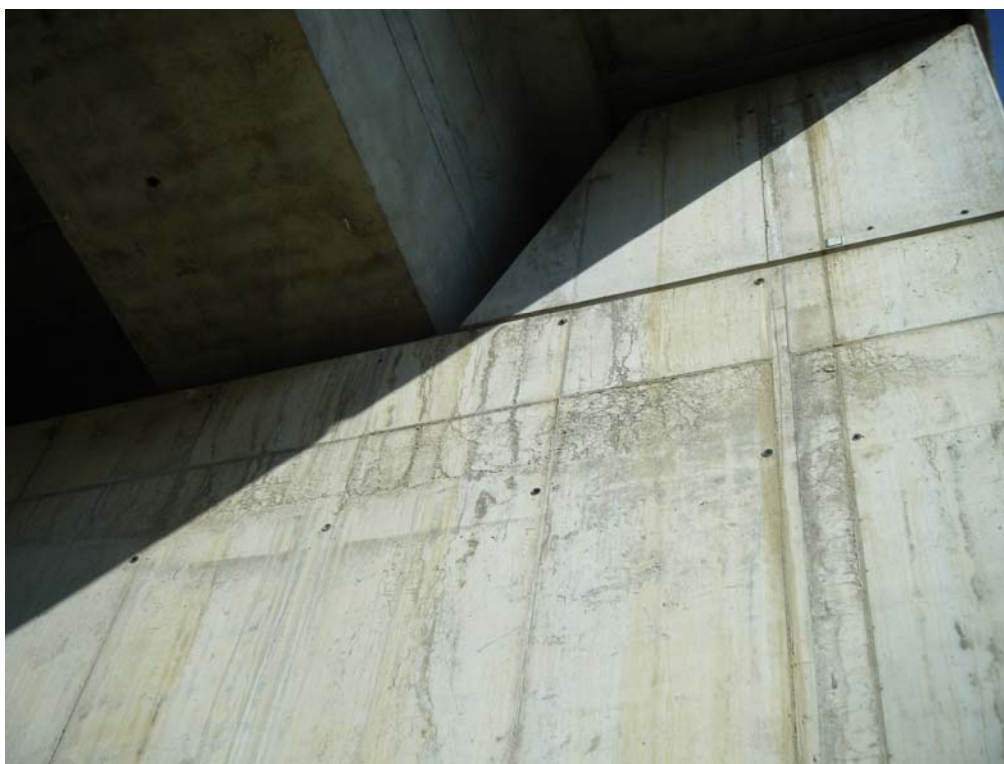
Nido de grava en el estribo E-2
