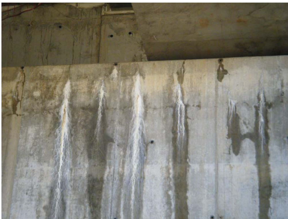
Eflorescencias en el estribo de entrada
