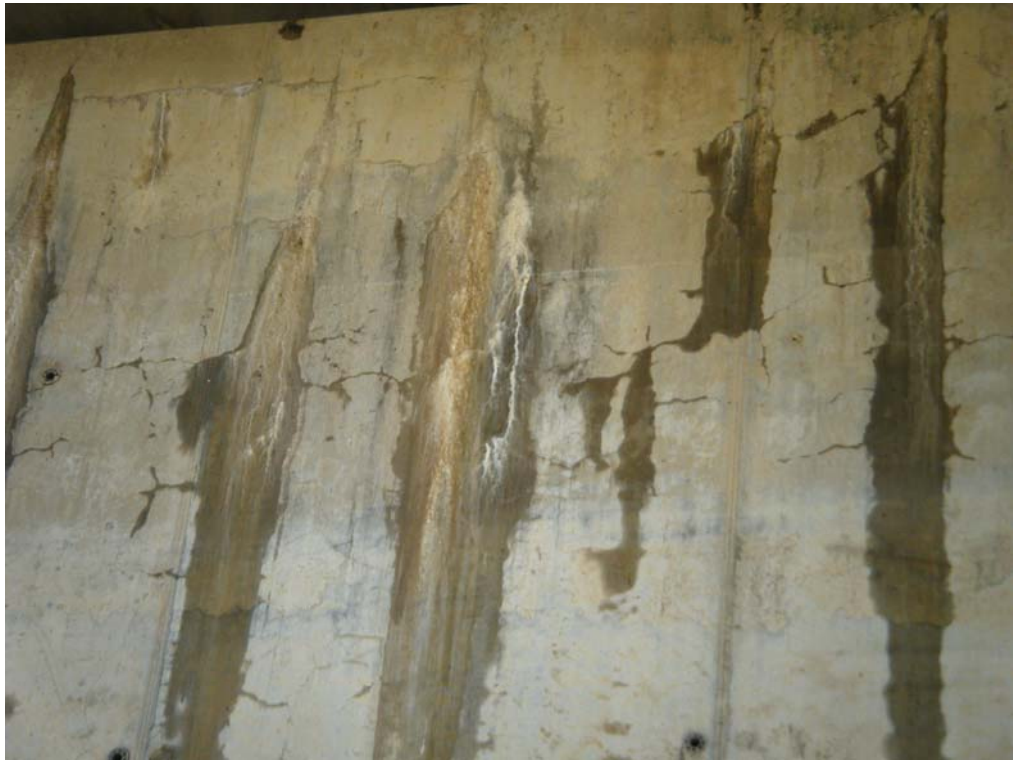
Fisuras en mapa en el estribo de entrada
