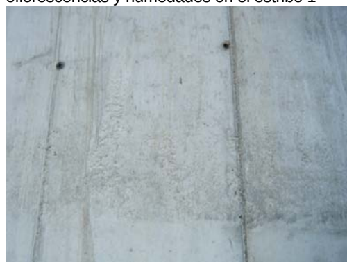
Fotografía nº 8. Nido de grava en la pila 1
