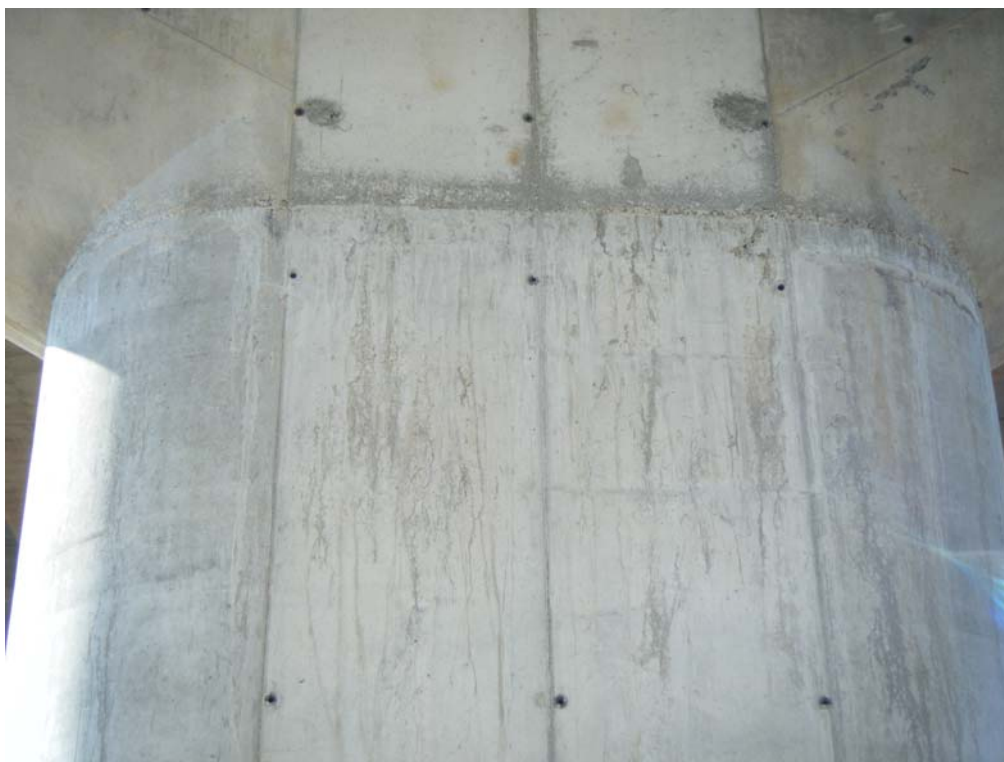
Nido de grava P-2 lado vano 3
