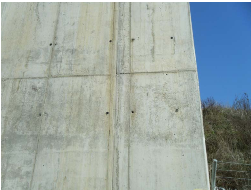
Nido de grava en el estribo E-2
