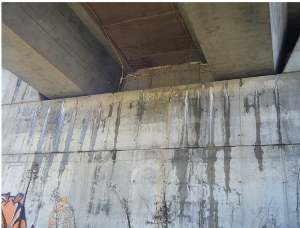
Humedades y eflorescencias en el estribo de entrada
