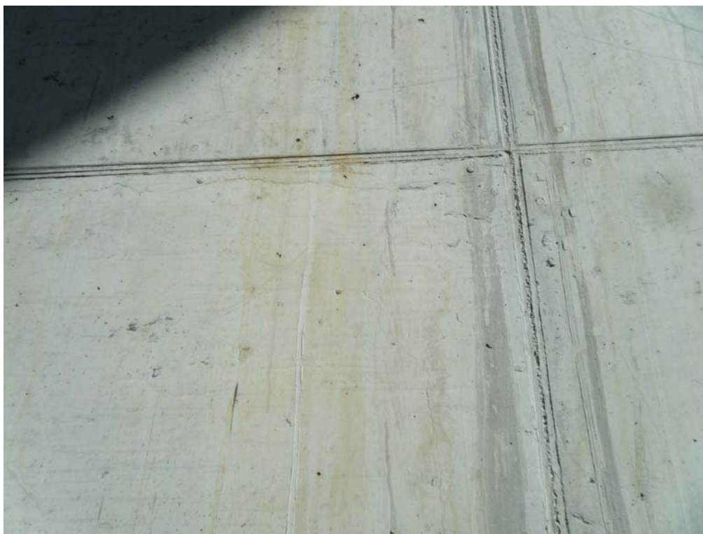
Fisuras en mapa en la pila nº 1 lado vano nº 1
