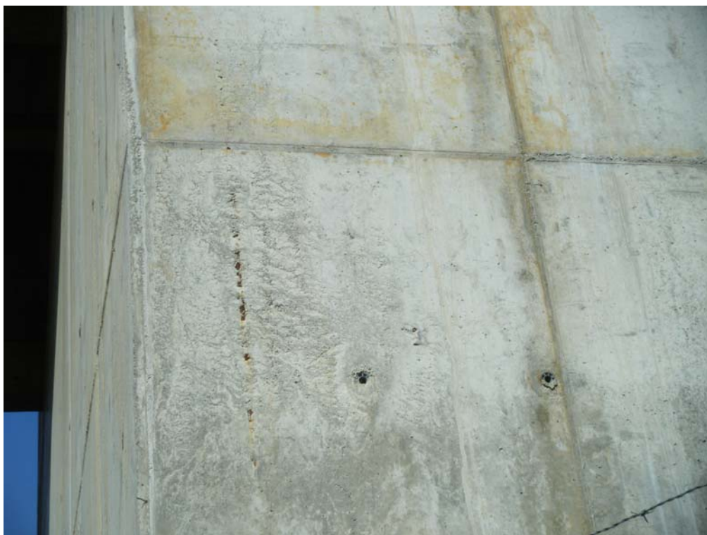
Armadura vista en la aleta derecha de E2
