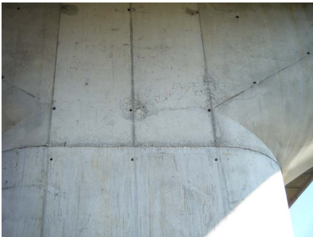
Nido de grava en la pila nº 1 lado vano nº 1
