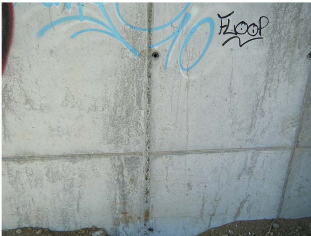
Nido de grava en la pila nº 2 cara vano nº 3 (I)
