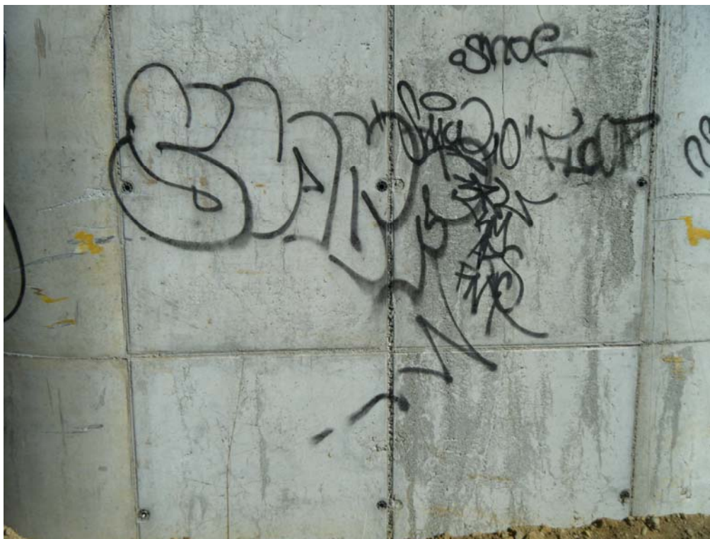
Pintadas en la pila nº 2 cara vano nº 2
