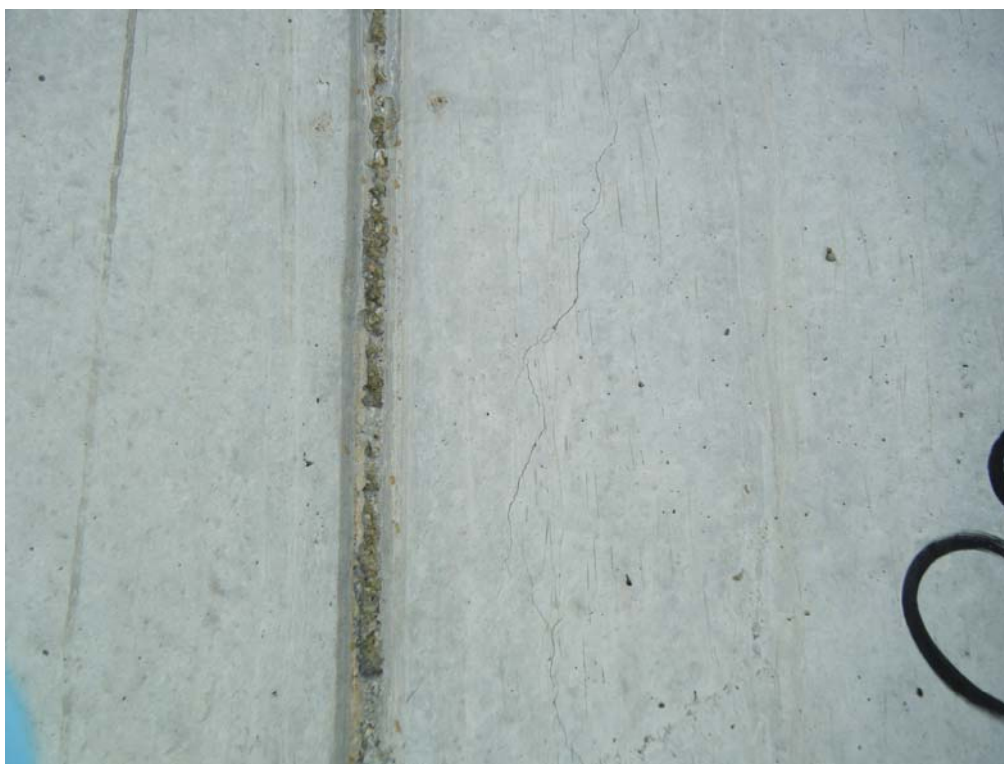
Fisura en la pila nº 2 cara Vano nº 3
