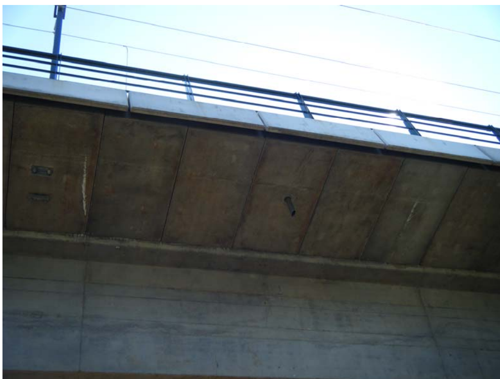
Eflorescencia en el voladizo izquierdo del vano n° 2
