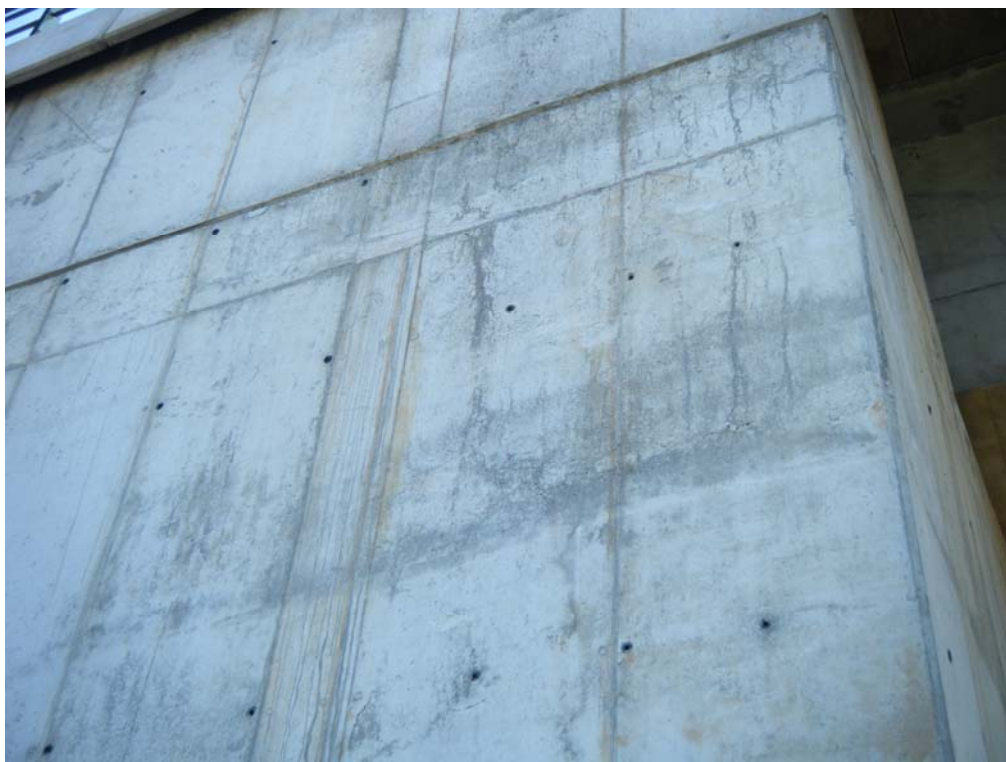
Nido de grava en la aleta izquierda del estribo de salida
