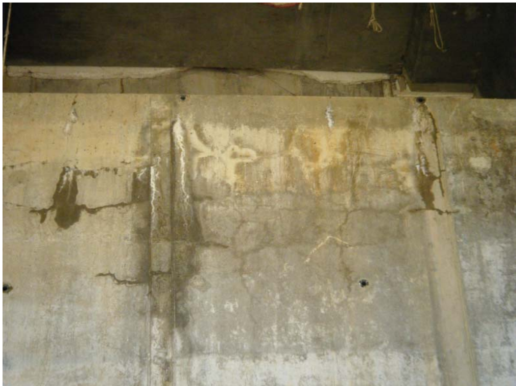
Fisuras en mapa en el estribo nº 1 (I)
