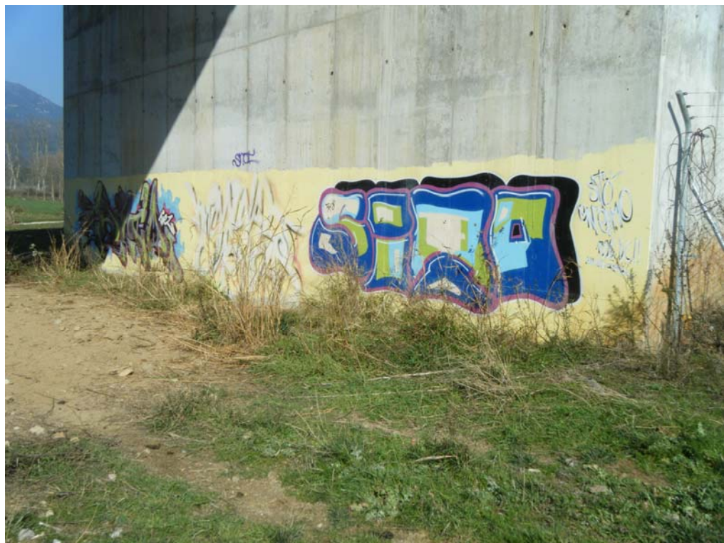
Pintadas en el estribo de salida
