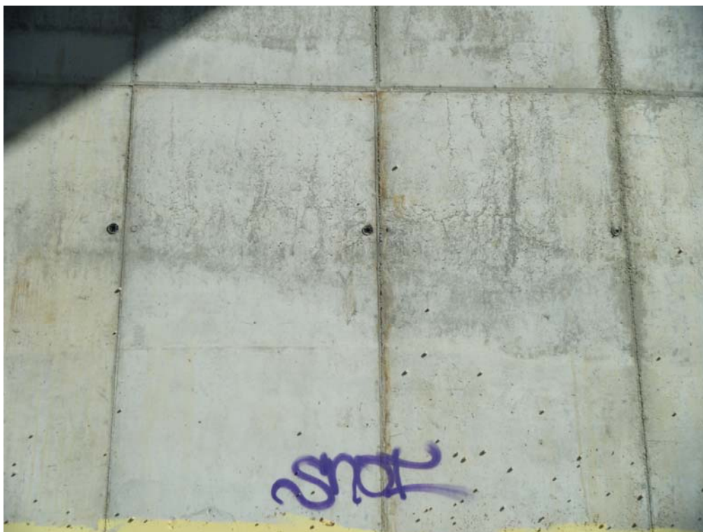
Nido de grava en el estribo E-2
