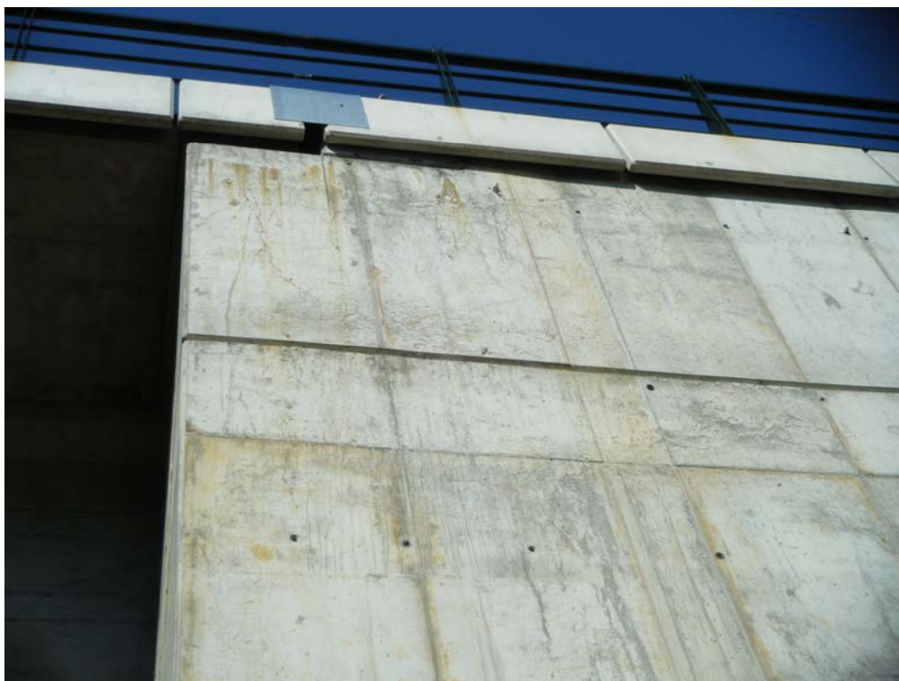
Nido de grava en la aleta derecha del estribo de salida
