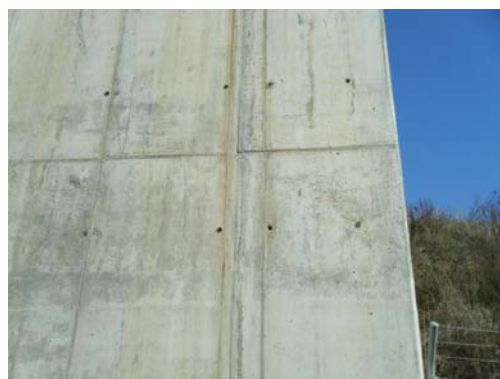
Fotografía nº 8. Nidos de grava en estribo de salida
