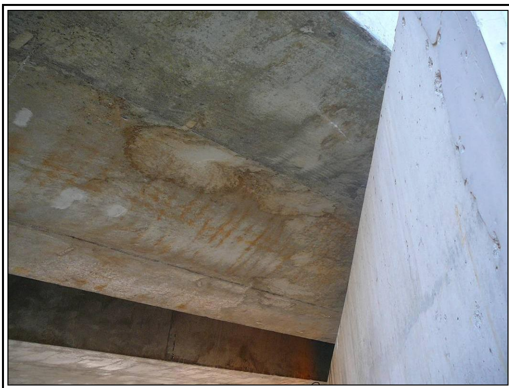
Degradación superficial en la parte inferior de la viga de borde izquierda
