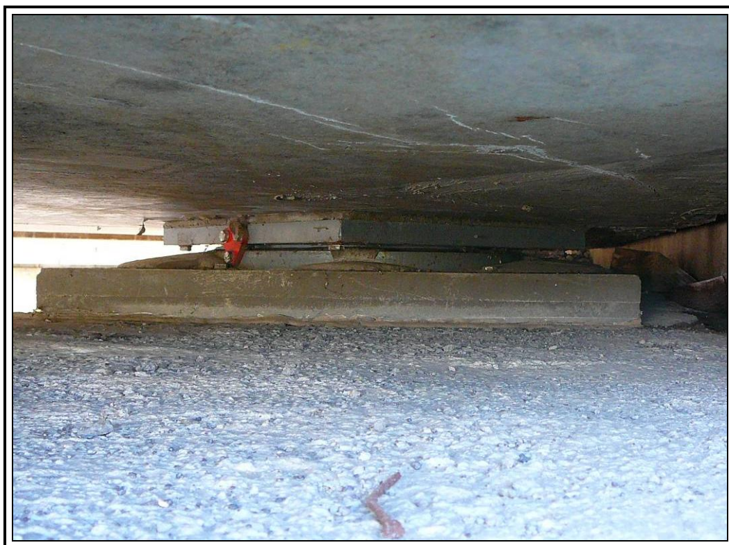
Placas de montaje de apoyos sin retirar
