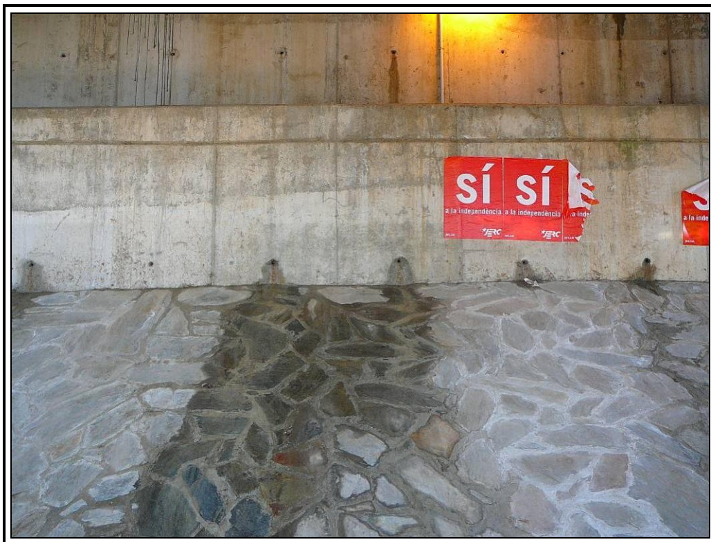
Filtraciones a través del muro frontal de estribo uno
