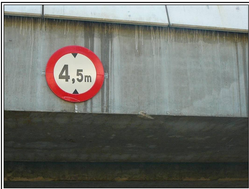
Desconchón por impacto en viga de borde izquierda
