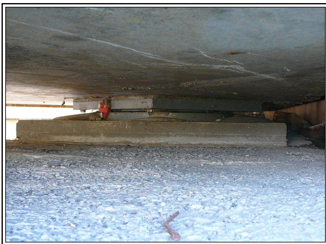
Placas de montaje de apoyos sin retirar
