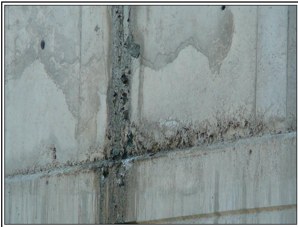
Filtraciones en muro lateral izquierdo de estribo dos
