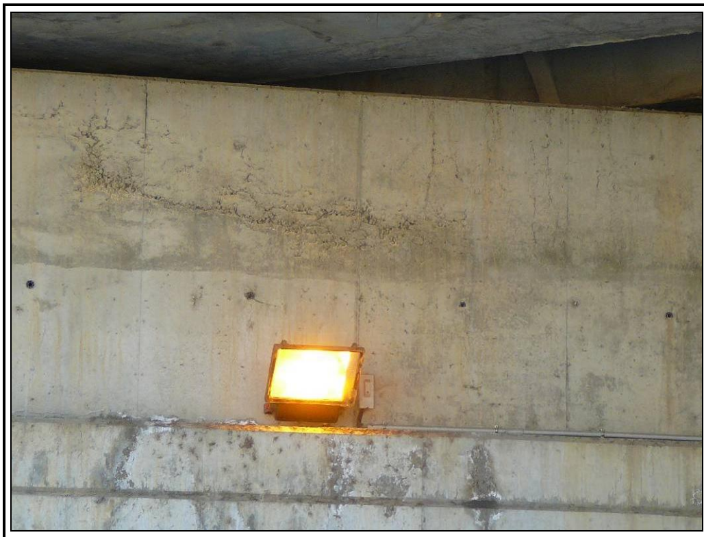
Nido de grava en muro frontal de estribo dos
