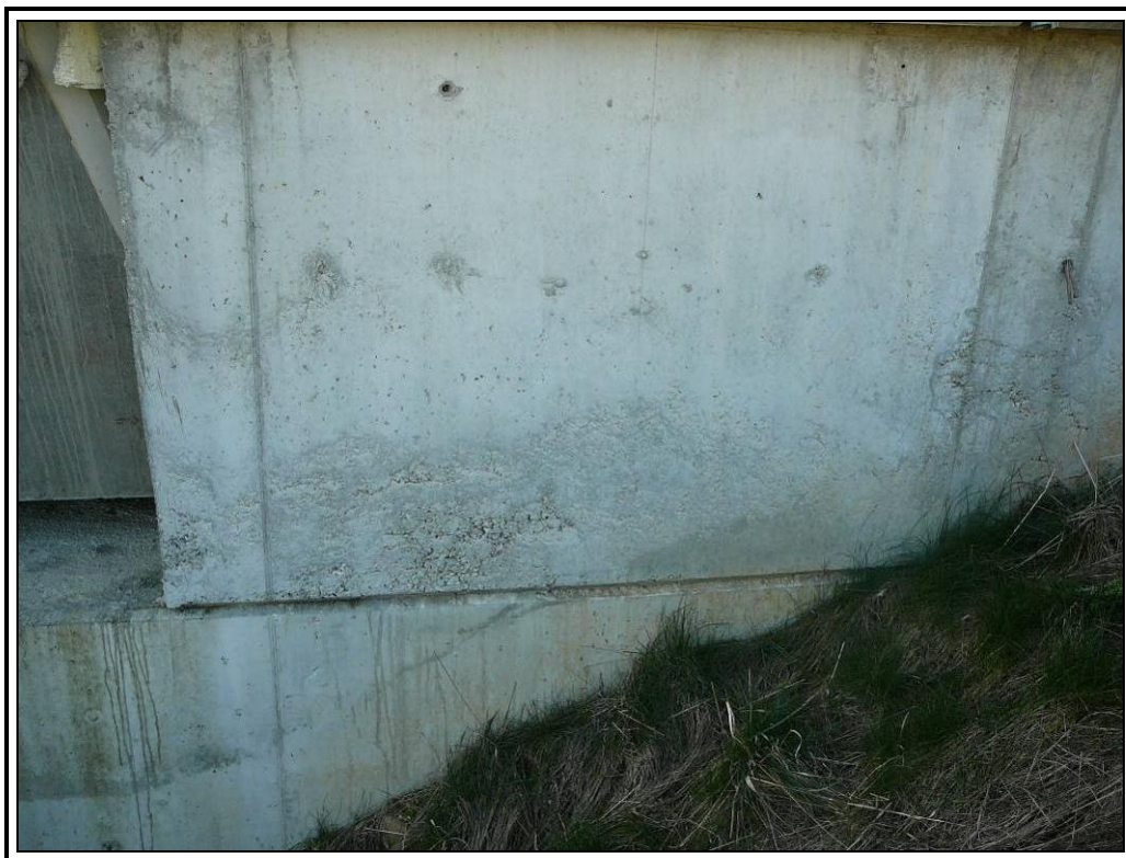
Nido de grava en muro lateral izquierdo de estribo uno
