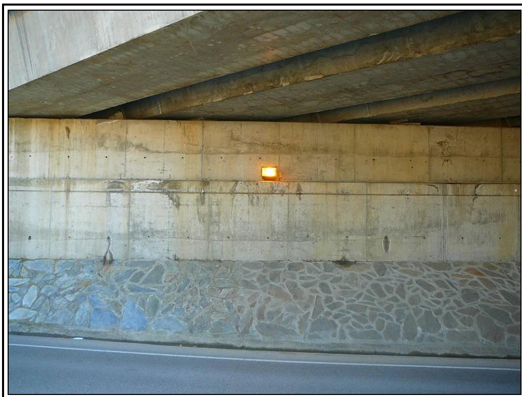
Filtraciones a través del muro frontal de estribo dos
