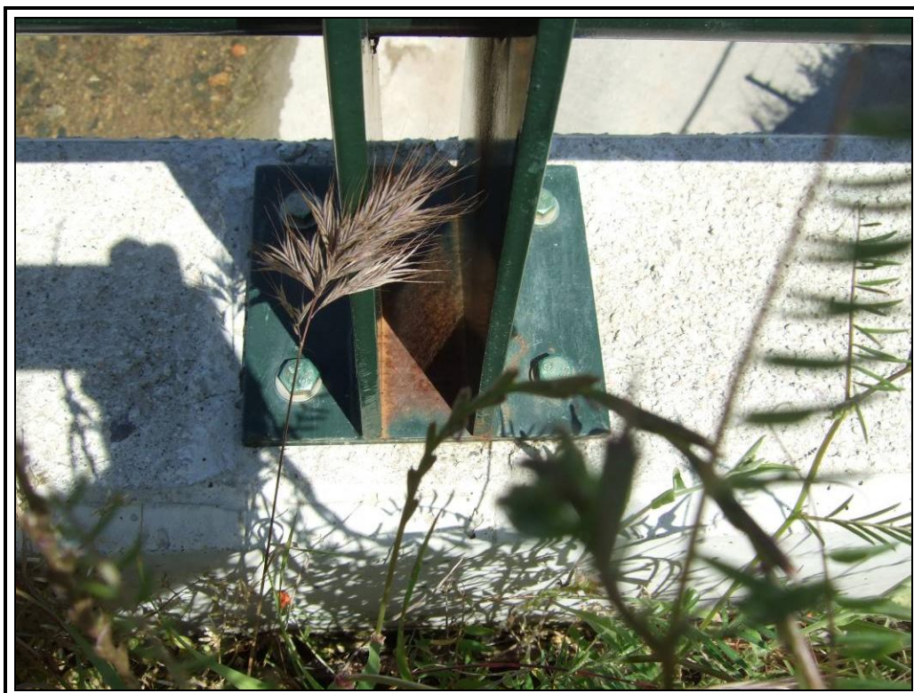
Corrosión e soporte de barandilla
