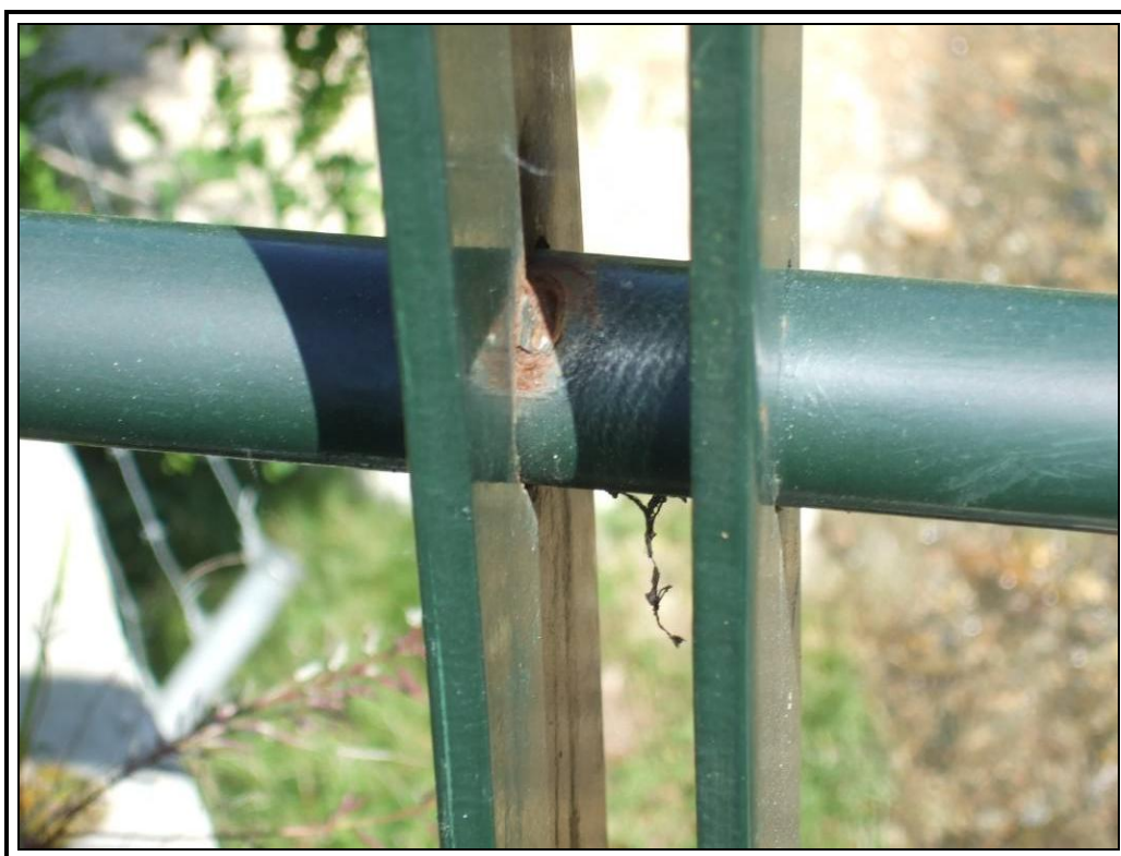
Corrosión en barandilla
