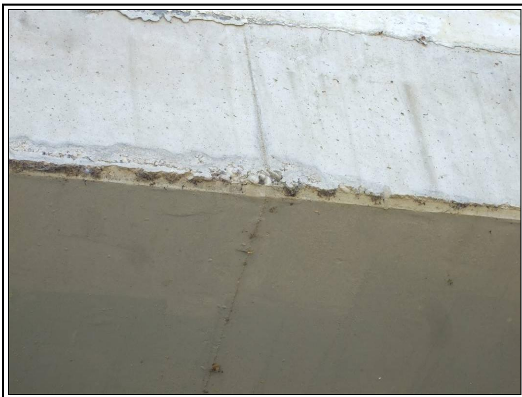
Nidos de grava en borde de losa superior
