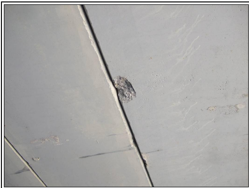
Desconchón en elemento prefabricado de losa superior
