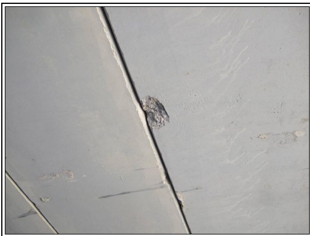
Desconchón en elemento prefabricado de losa superior
