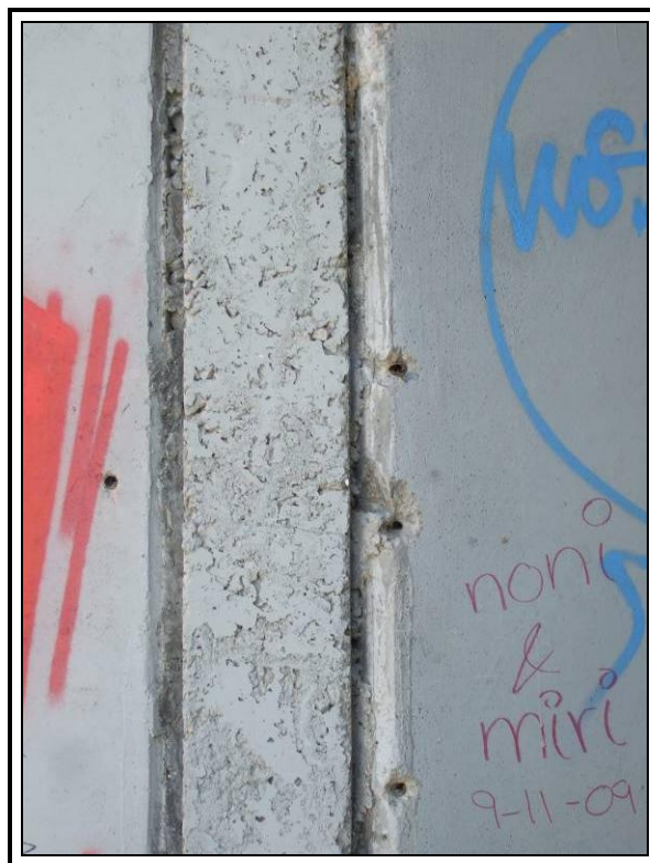
Nidos de grava en unión entre muro frontal hastial dos y aleta izquierda
