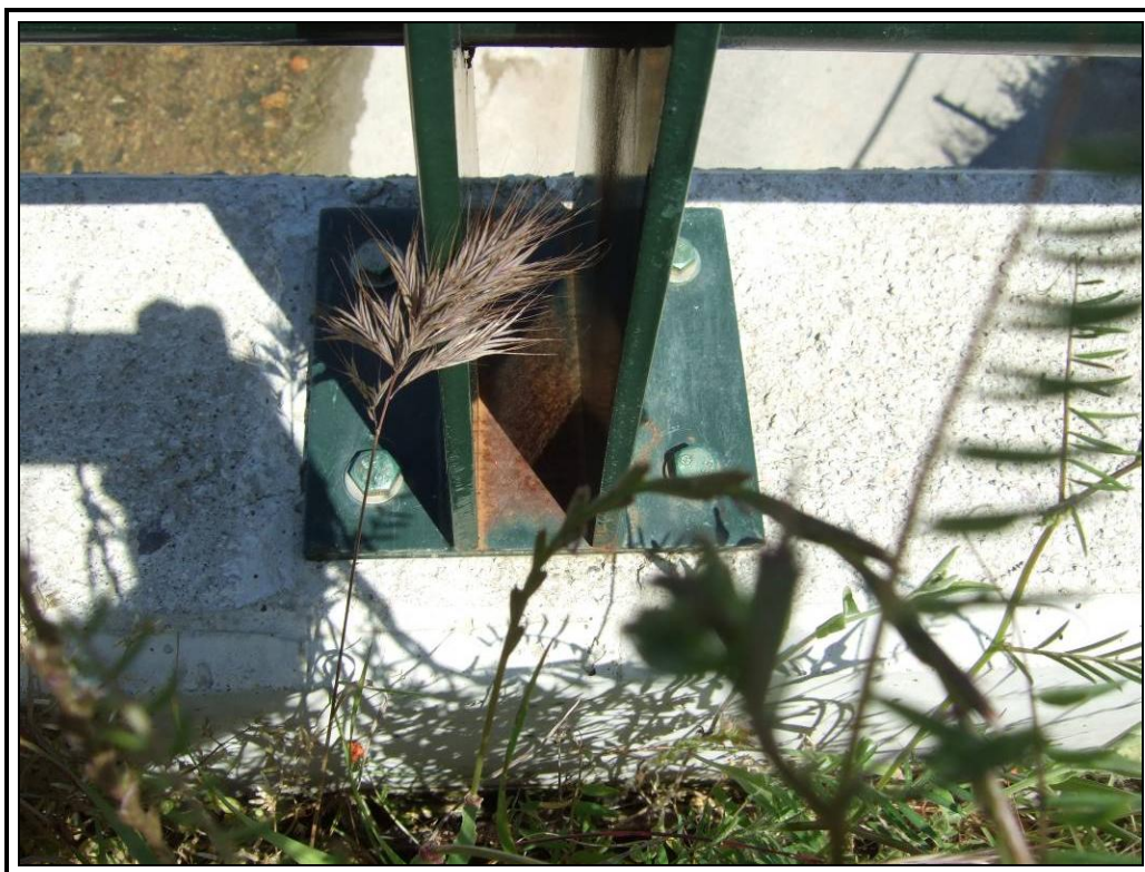
Corrosión e soporte de barandilla
