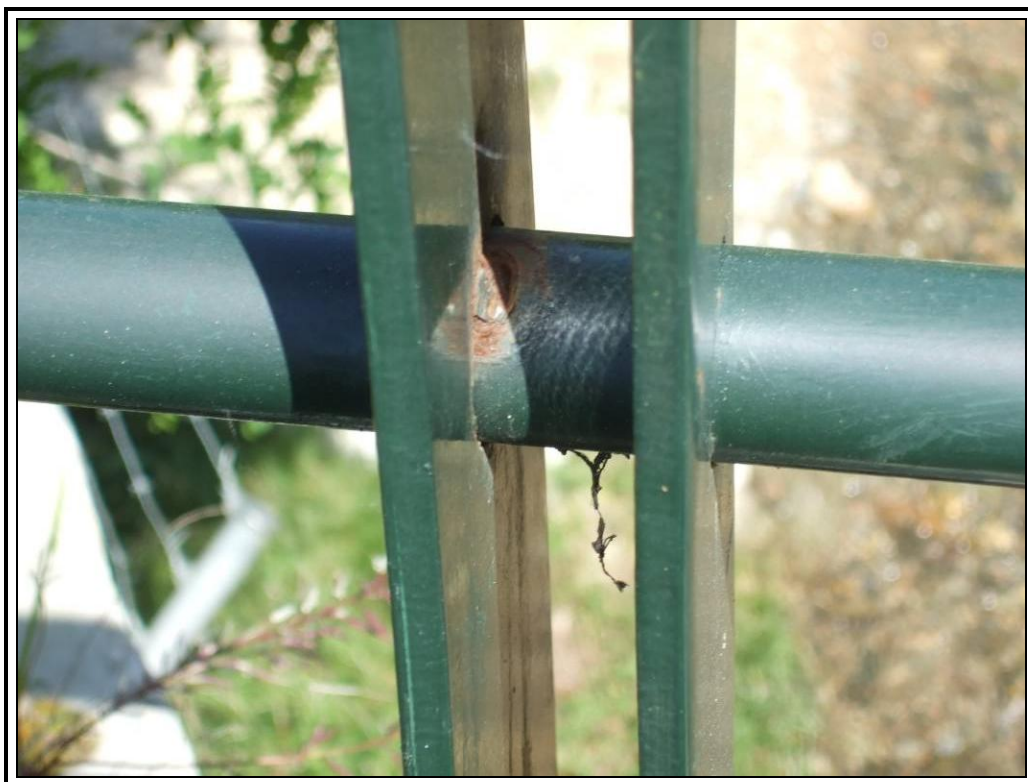
Corrosión en barandilla
