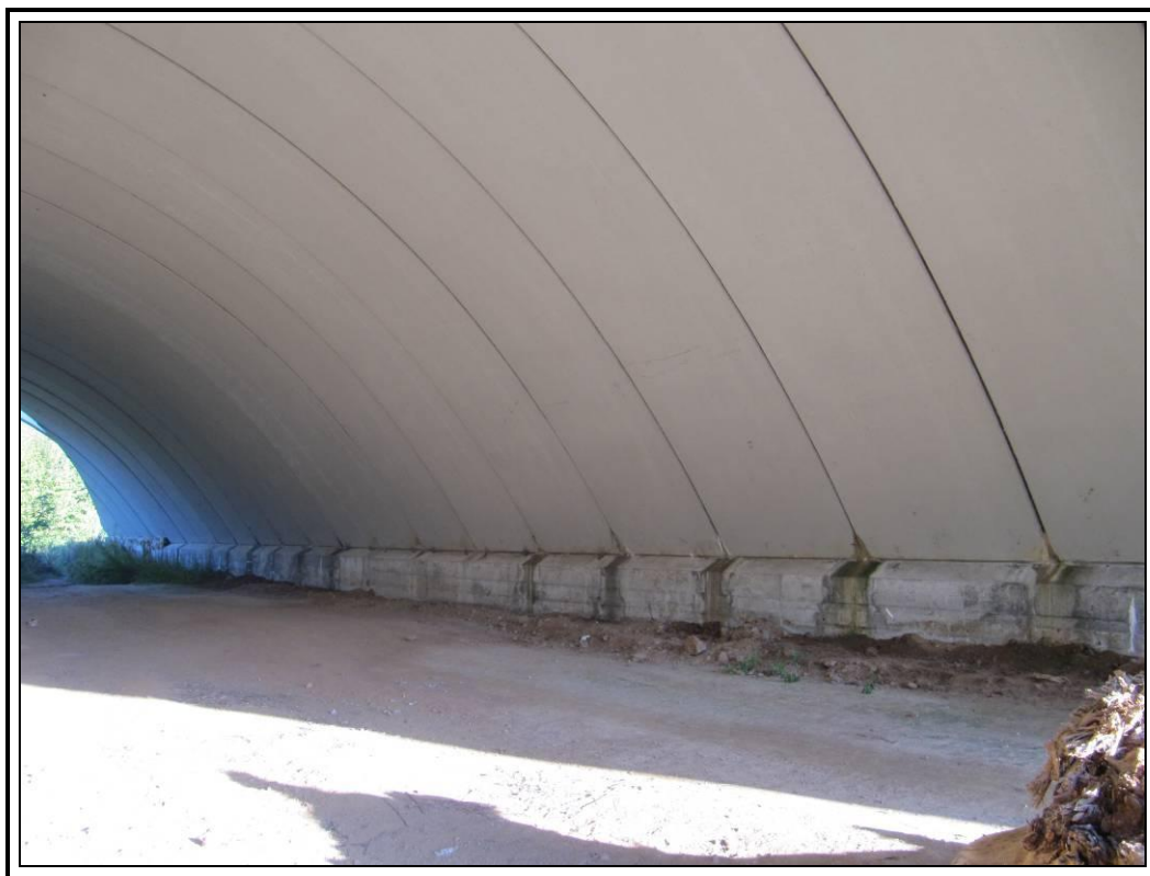
Filtraciones por fallo en la impermeabilización.
