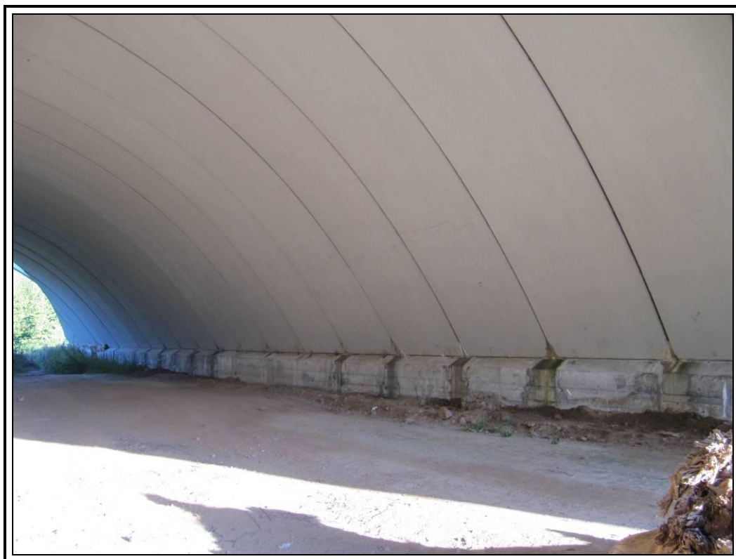
Filtraciones por fallo en la impermeabilización.
