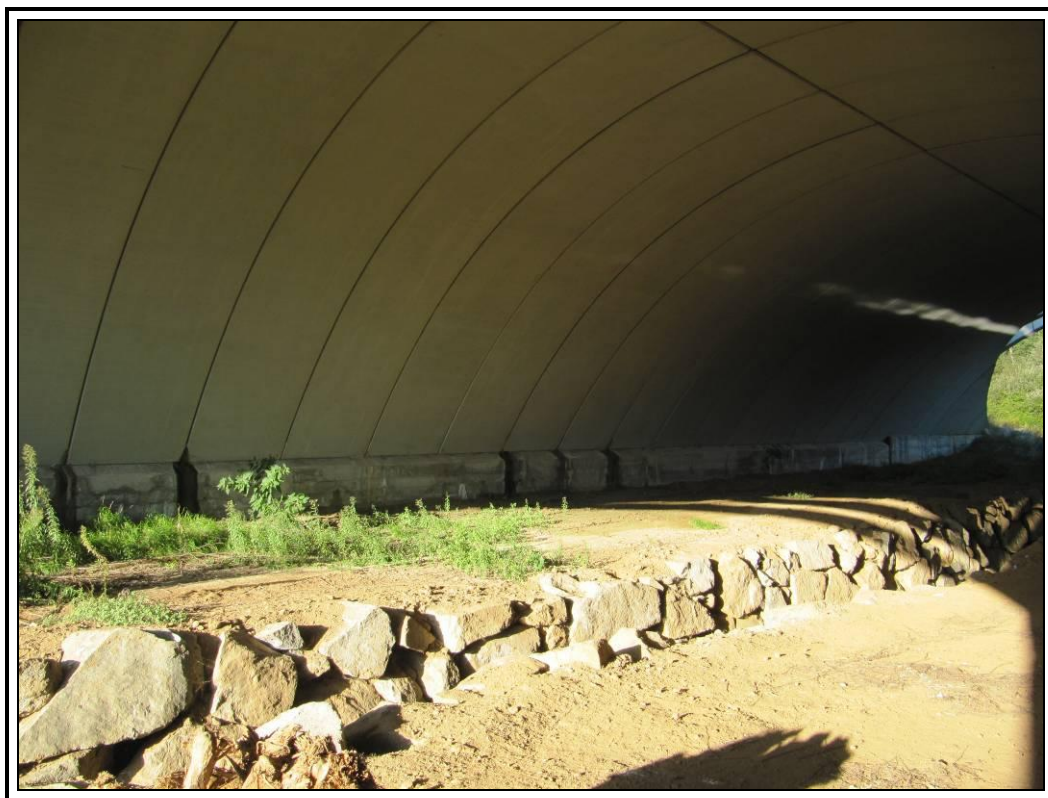
Filtraciones por fallo en la impermeabilización.
