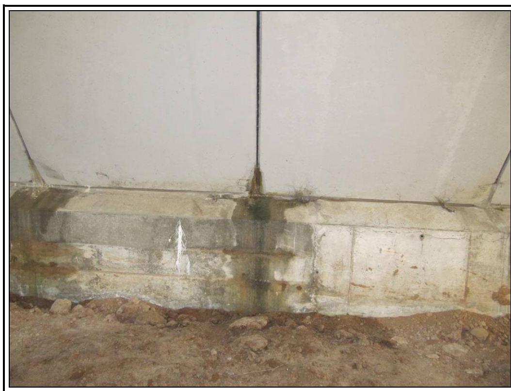
Fisuras de retracción con eflorescencias.
