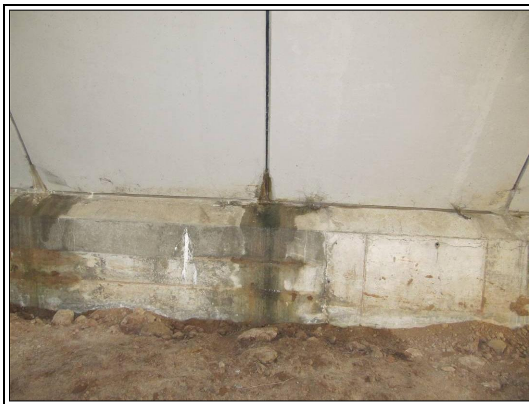
Fisuras de retracción con eflorescencias.
