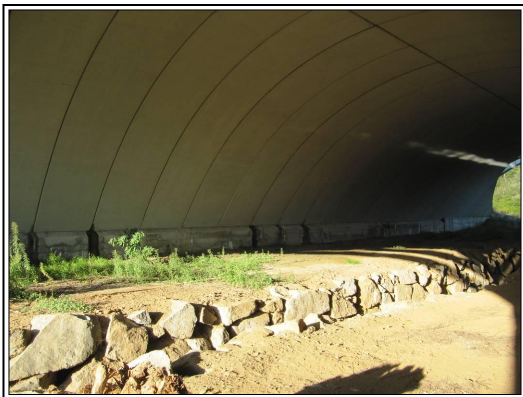
Filtraciones por fallo en la impermeabilización.
