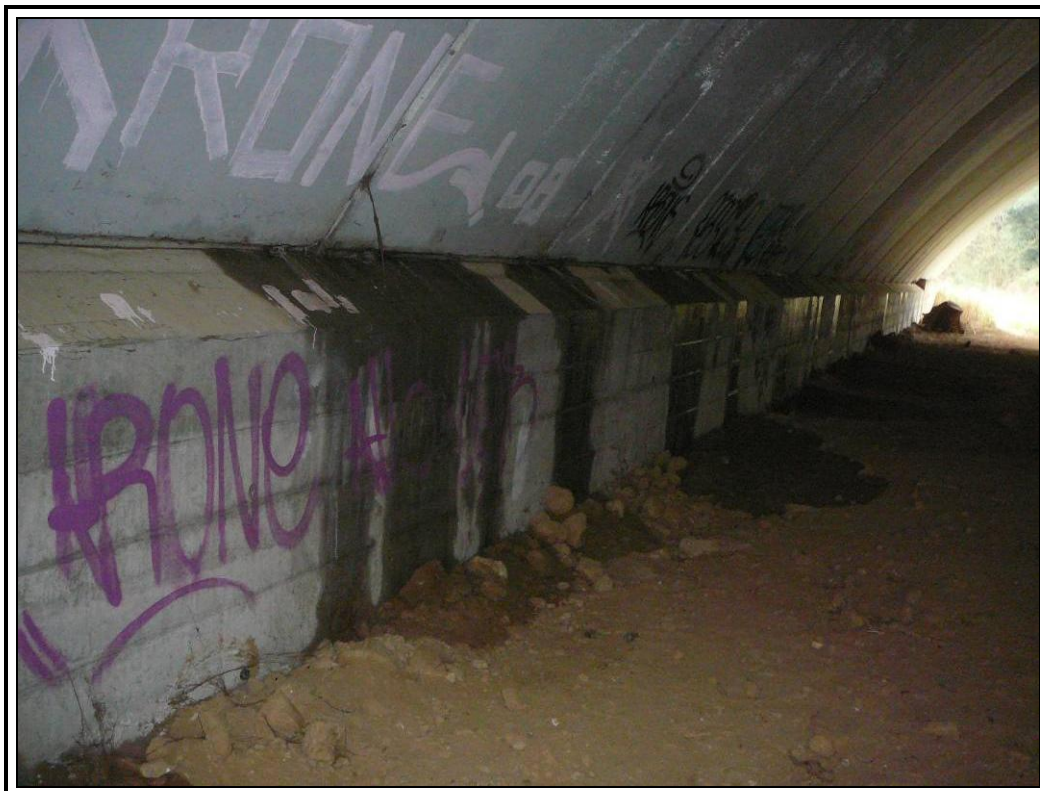
Filtraciones por fallo del drenaje.
