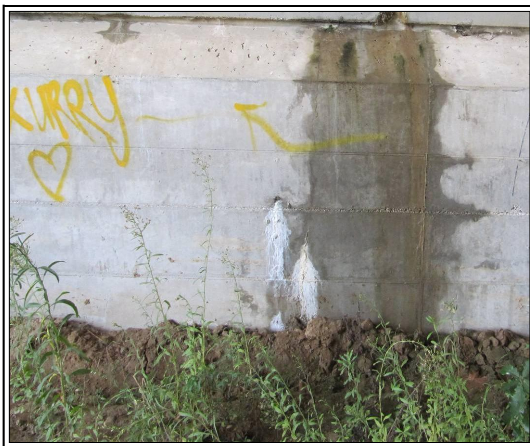
Fisuras de retracción con eflorescencias.
