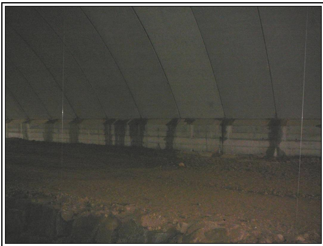
Filtraciones por fallo del drenaje.
