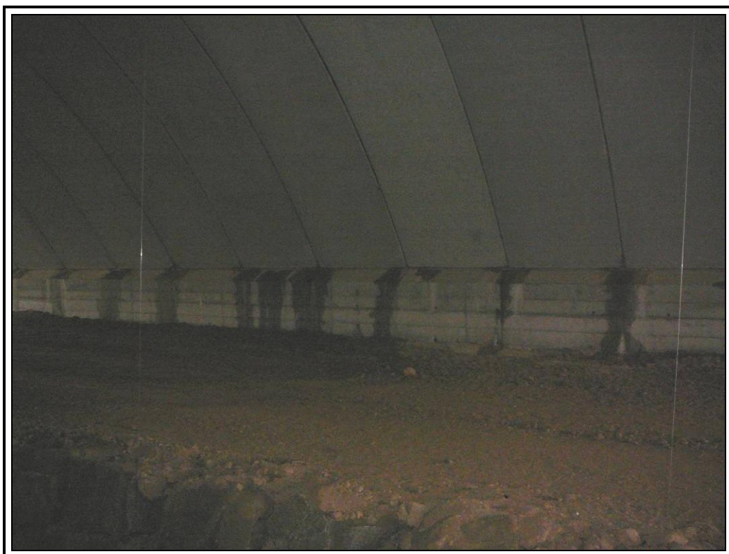
Filtraciones por fallo del drenaje.
