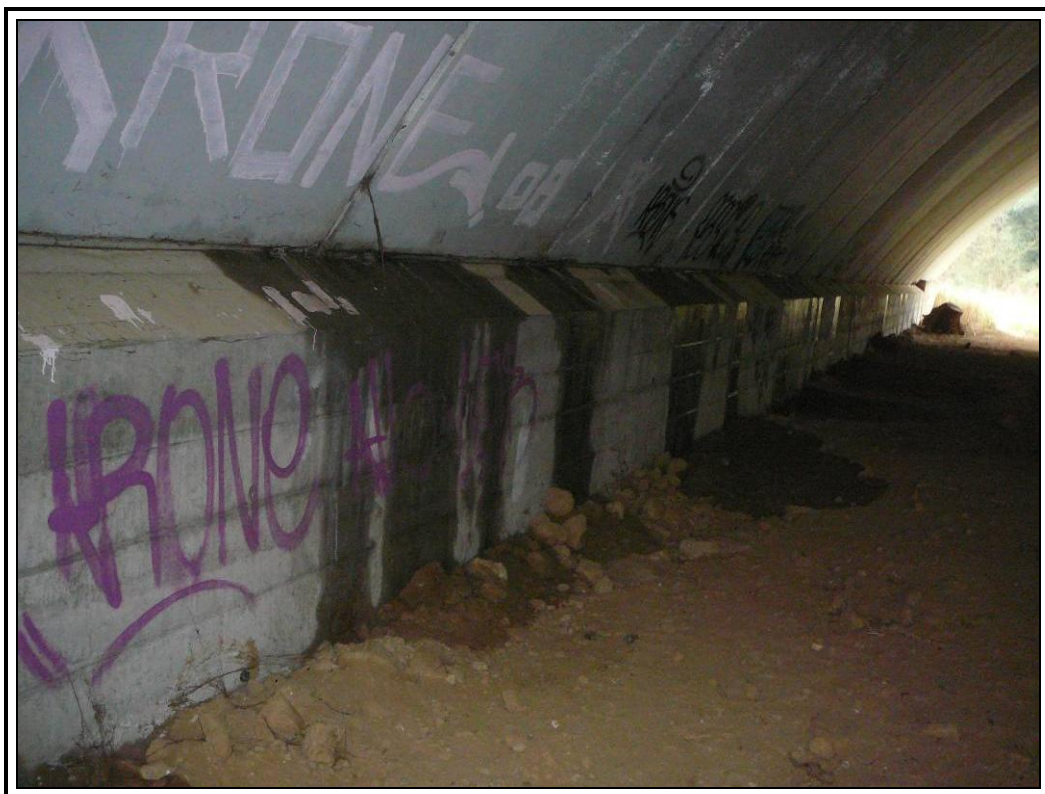
Filtraciones por fallo del drenaje.
