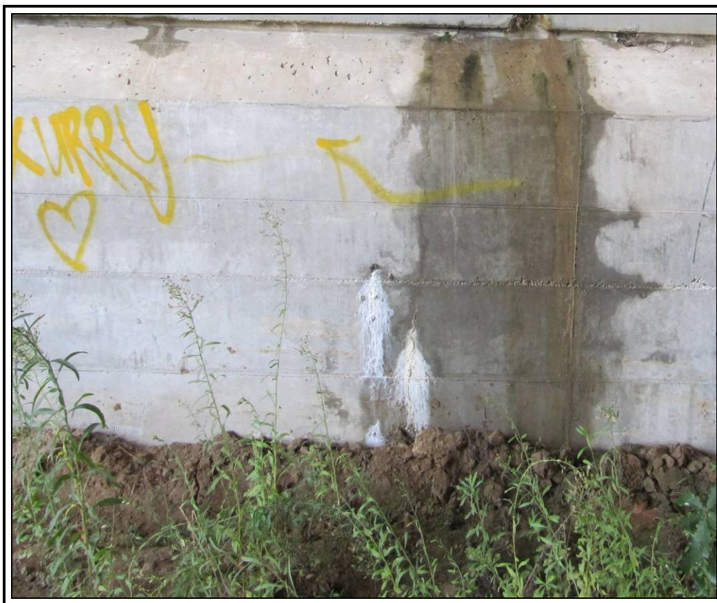
Fisuras de retracción con eflorescencias.
