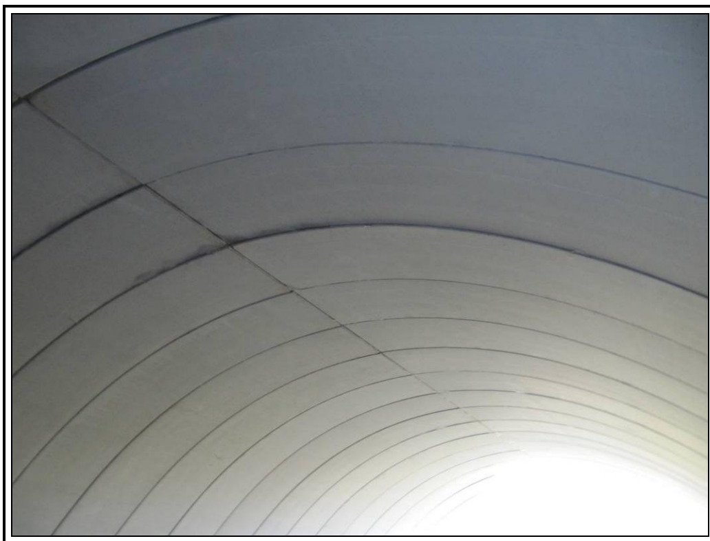
Desplazamiento de dovela en anillo número 34.
