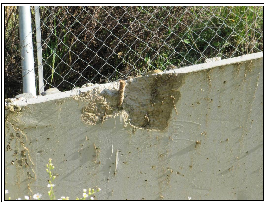
Desconchón con armadura implicada.
