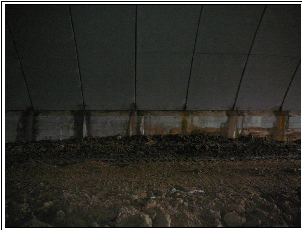
Filtraciones por fallo del drenaje.
