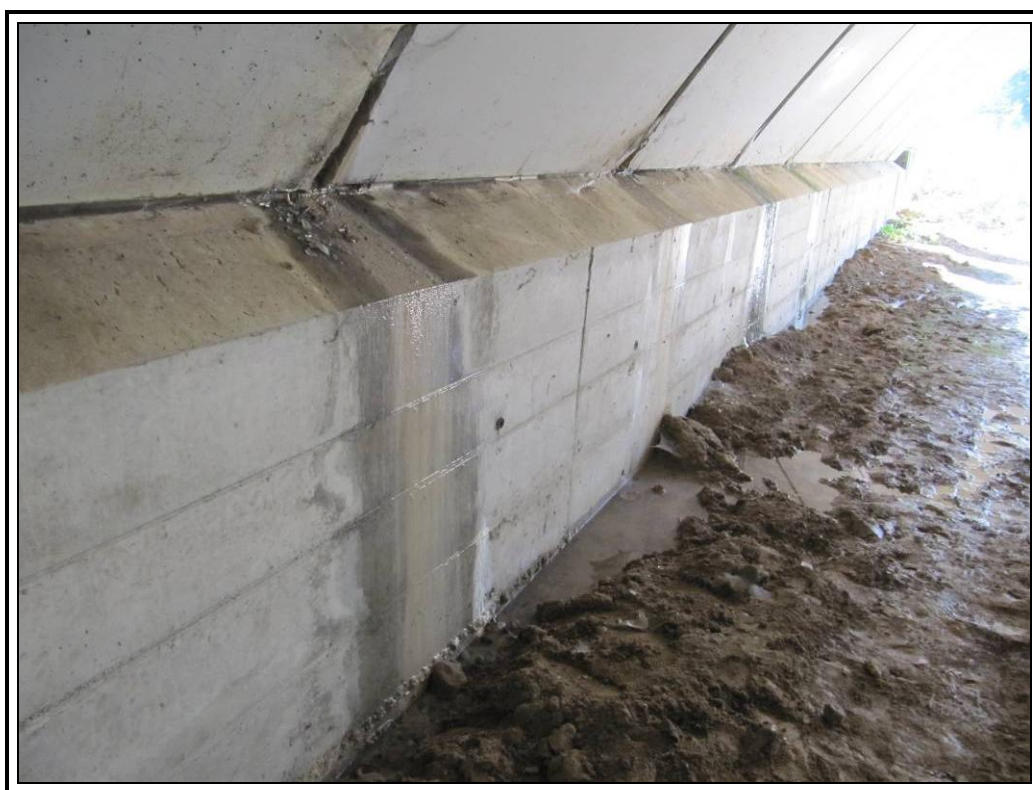
Filtraciones por fallo del drenaje.
