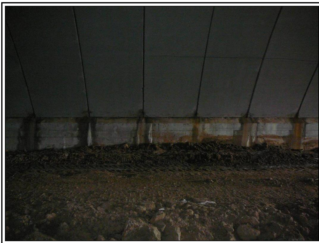
Filtraciones por fallo del drenaje.
