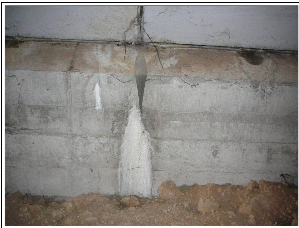
Fisuras de retracción con eflorescencias.
