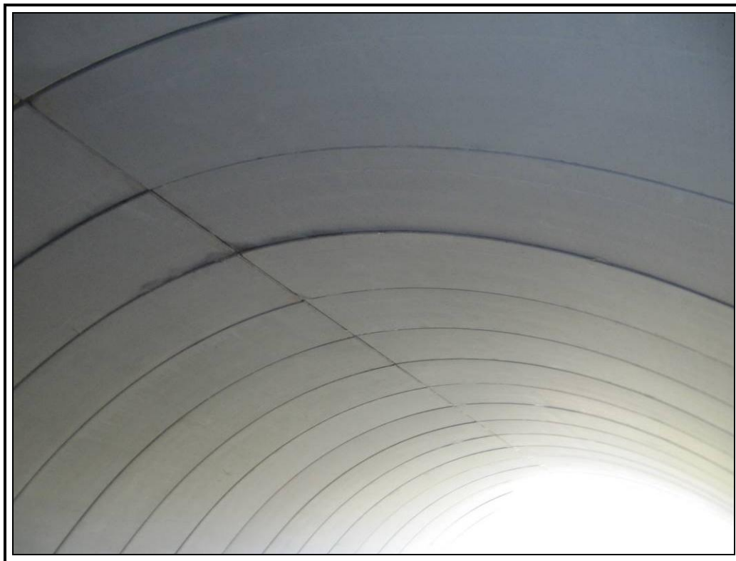
Desplazamiento de dovela en anillo número 34.
