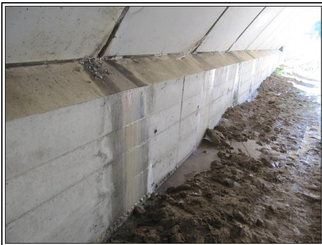
Filtraciones por fallo del drenaje.
