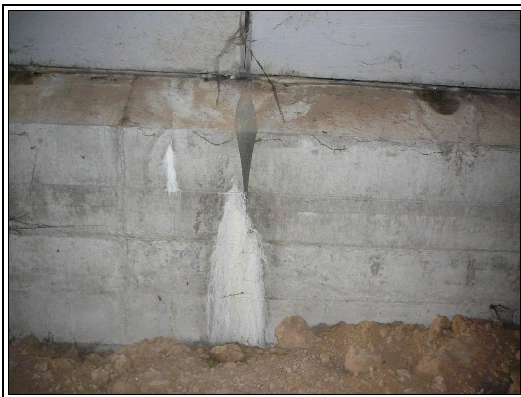
Fisuras de retracción con eflorescencias.
