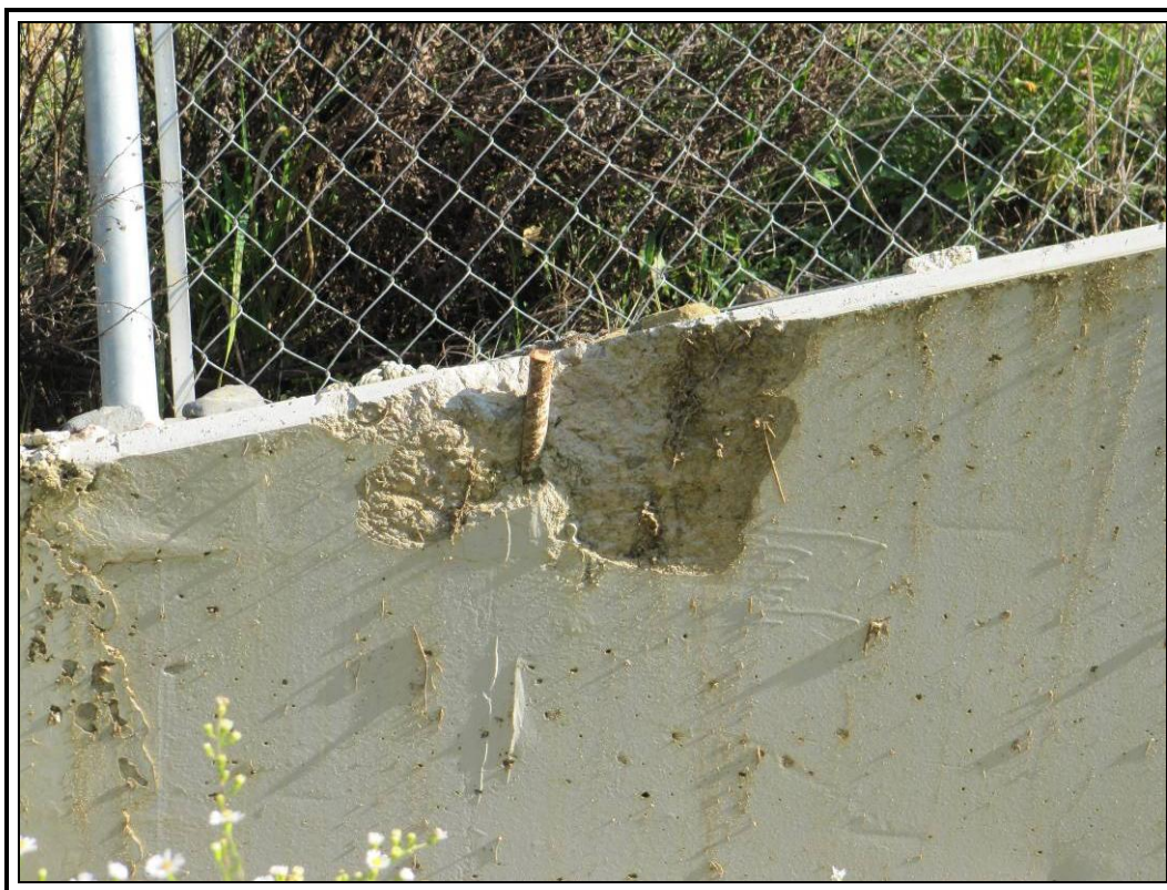
Desconchón con armadura implicada.
