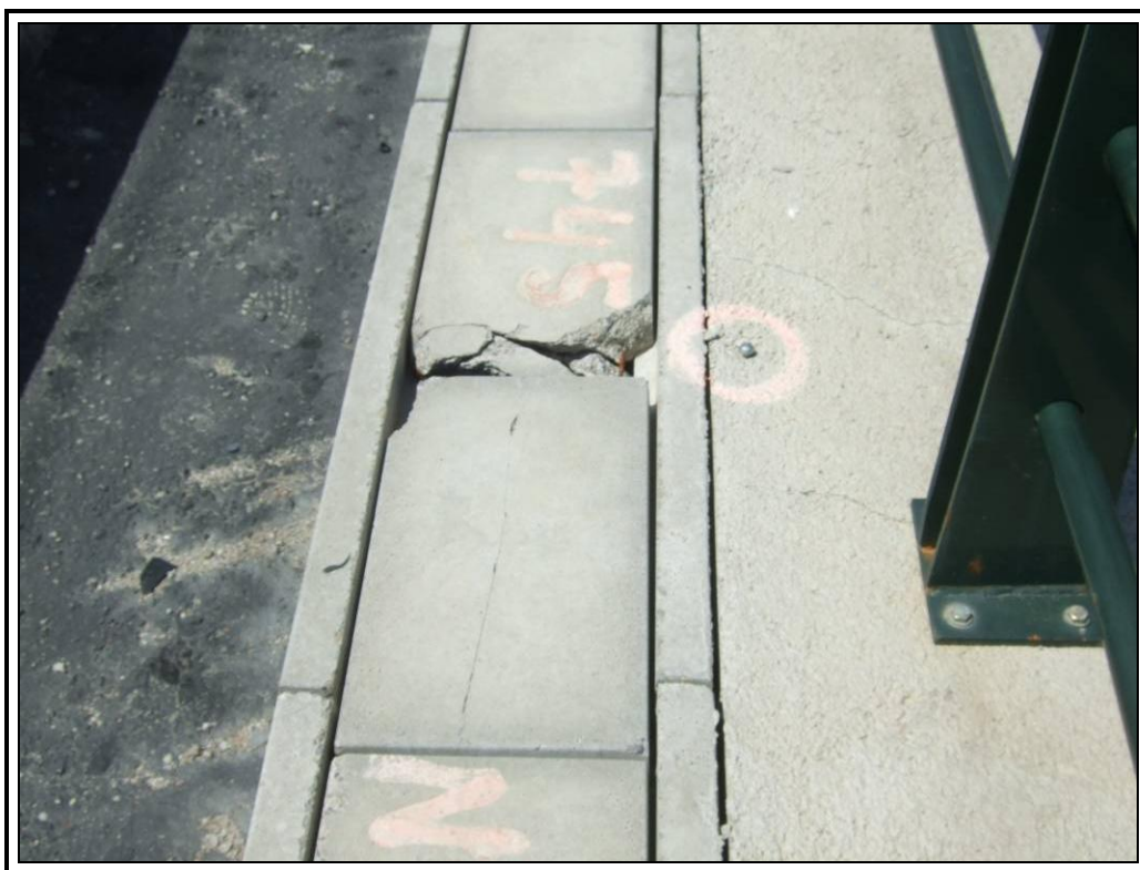
Tapas de canaleta rotas
