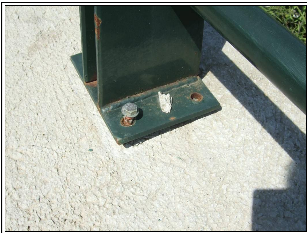
Deterioro de sujeción de barandilla
