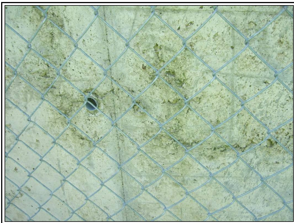
Coqueras en aleta izquierda de estribo uno
