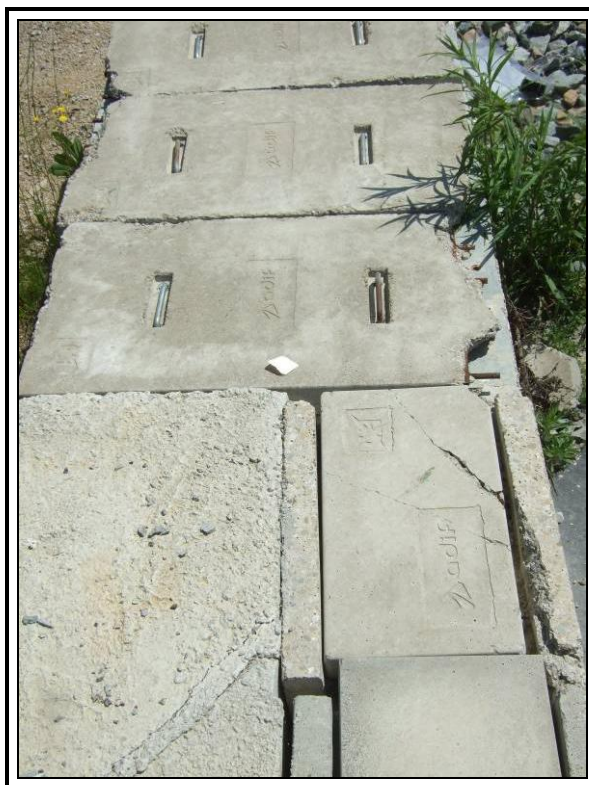
Tapas de canaleta rotas
