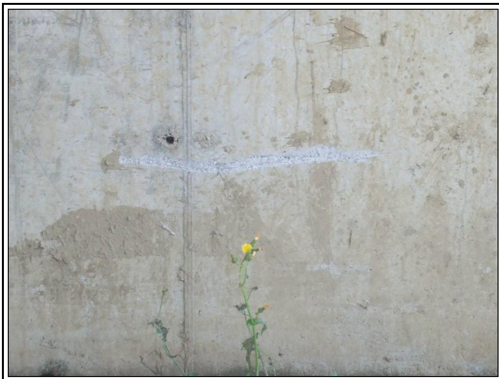
Rozadura en paramento de estribo dos
