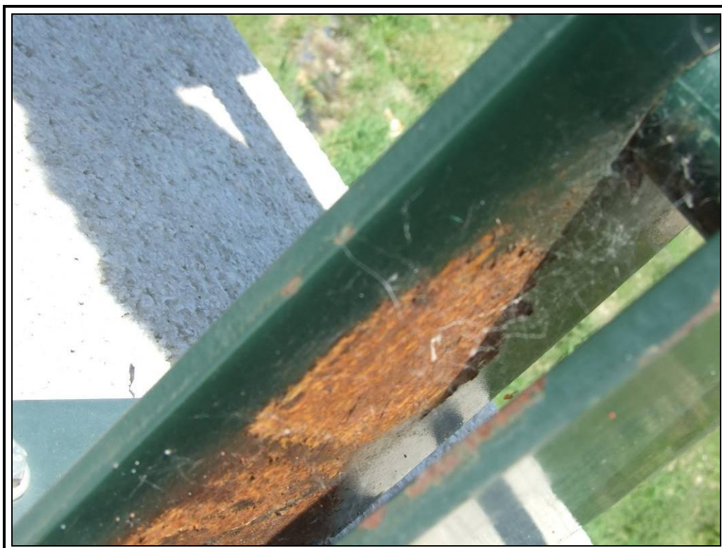
Oxidación en barandilla
