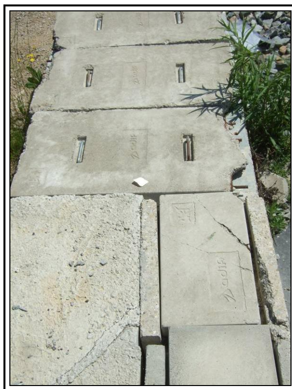
Tapas de canaleta rotas
