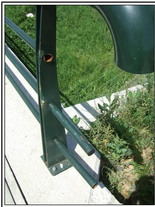
Rotura de elemento horizontal de barandilla
