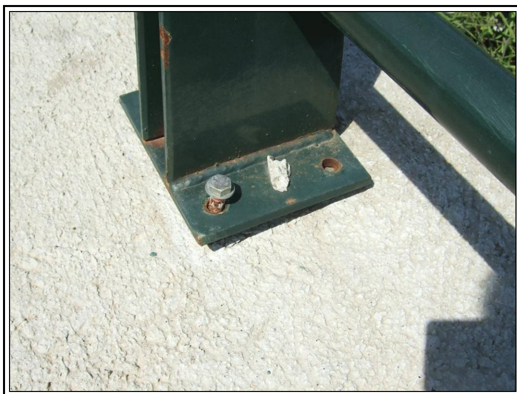
Deterioro de sujeción de barandilla
