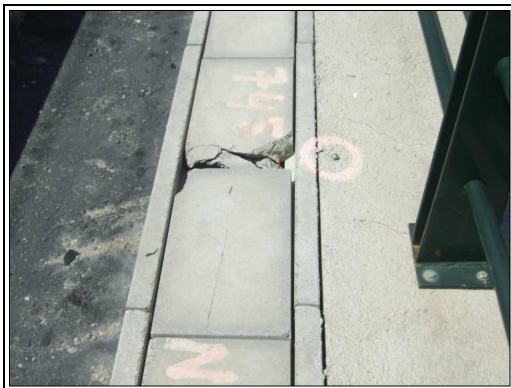
Tapas de canaleta rotas
