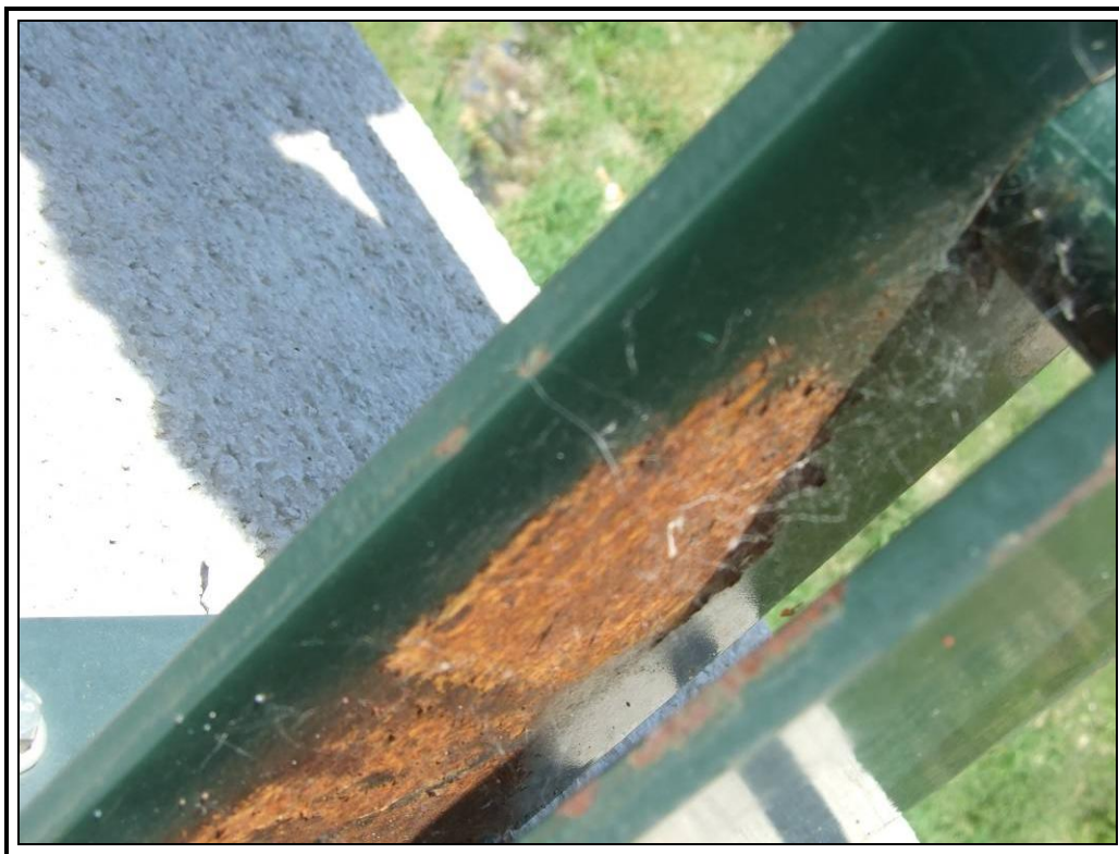
Oxidación en barandilla
