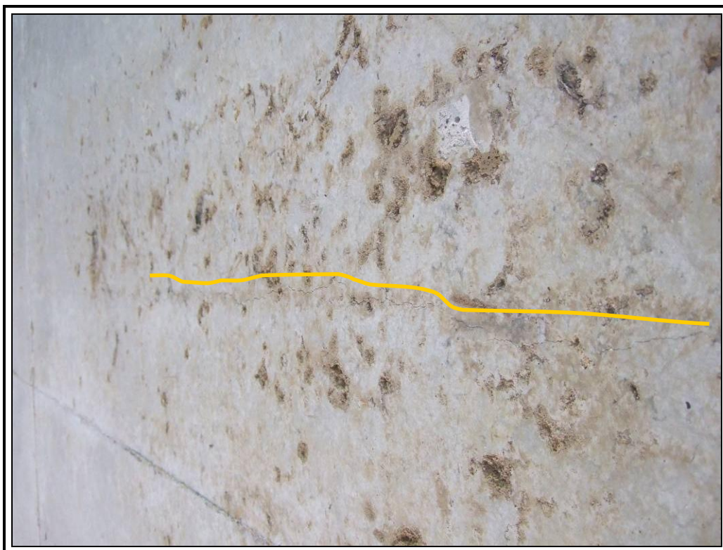
Pequeñas coqueras y fisuras de retracción en fibra inferior del dintel
