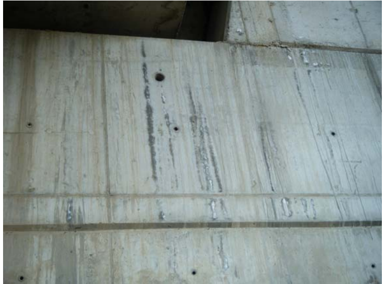
Fotografía N°16: Eflorescencias en el estribo 2
