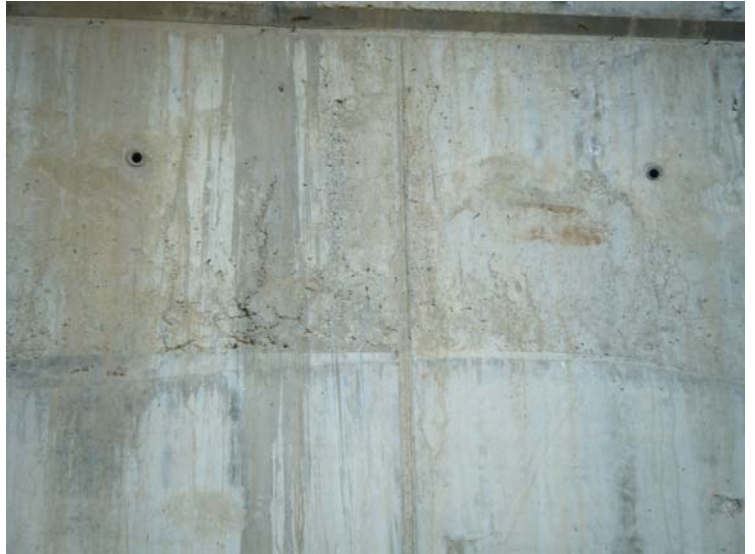
Fotografía N°19: Nido de grava en el estribo 2
