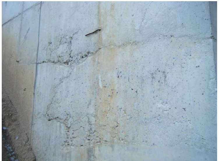
Fotografía N°18: Nido de grava en la aleta derecha del estribo 1
