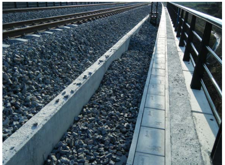
Fotografía N°14: Acumulación de balasto en la conducción del lado izquierdo
