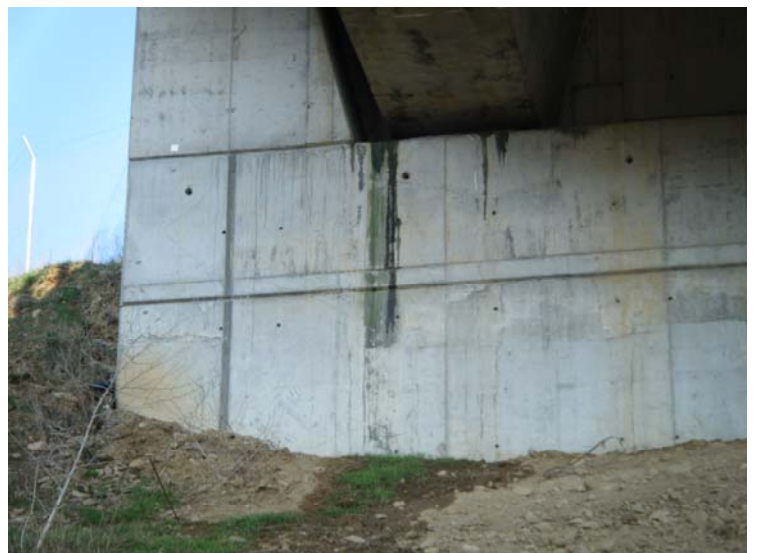
Fotografía N°15: Humedades en el estribo 2
