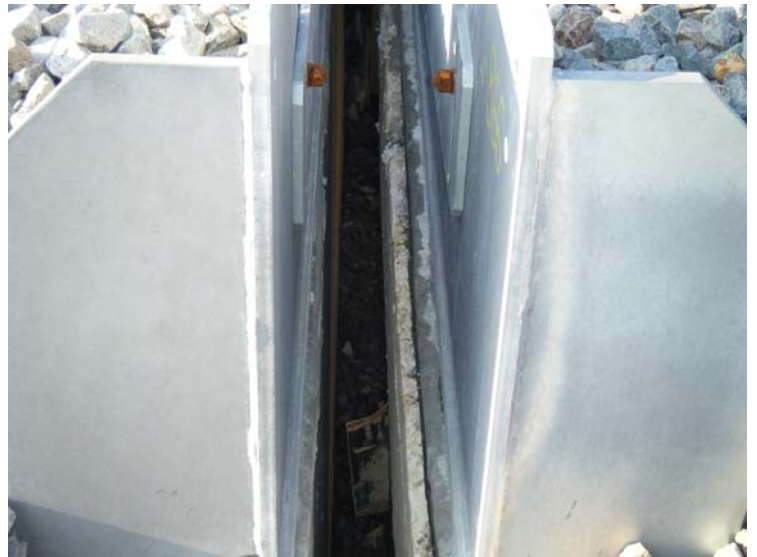
Fotografía N°13: Filtración de material por la junta del estribo 1
