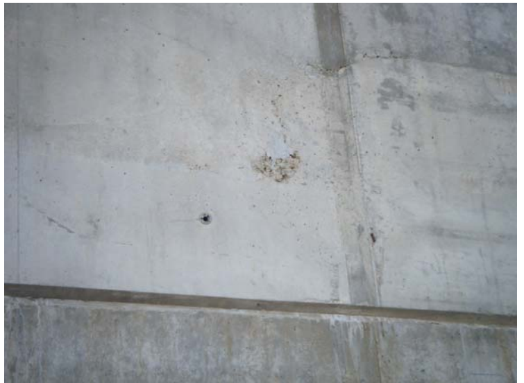
Fotografía N°17: Nido de grava en el estribo 1
