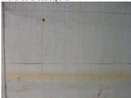
Fotografía nº 11. Fisuras en hastial de entrada
