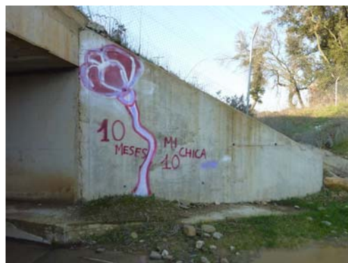
Fotografía nº 8. Pintadas en el estribo de entrada
