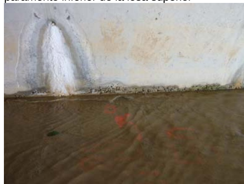
Fotografía nº 10. Eflorescencias en el hastial de salida
