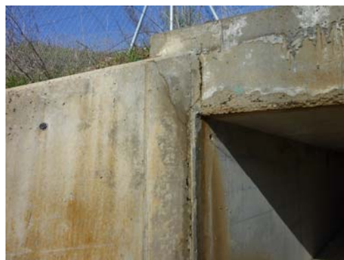
Fotografía nº 8. Fisura en la aleta derecha del estribo de entrada
