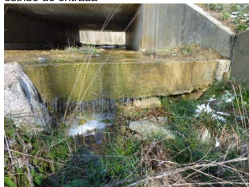
Fotografía nº 10. Descalce de la losa inferior
