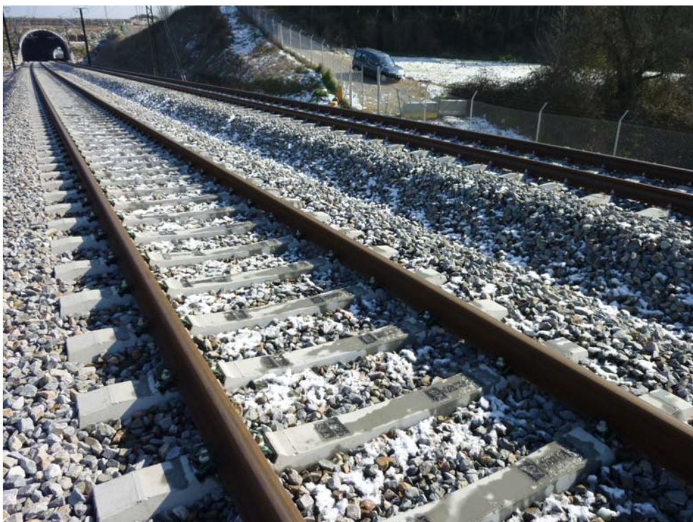
Fotografía 109: Material de vía
