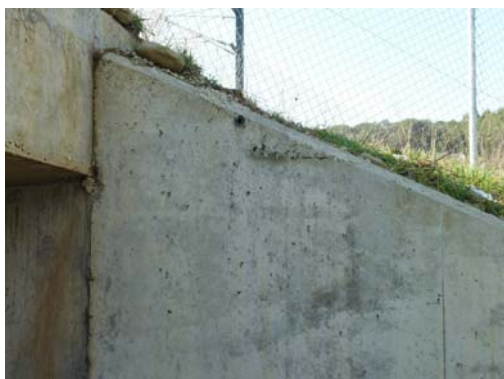
Fotografía nº 7. Nido de grava en la aleta izquierda del estribo de entrada
