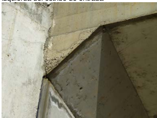
Fotografía nº 9. nido de grava en la cara lateral derecha de la losa superior
