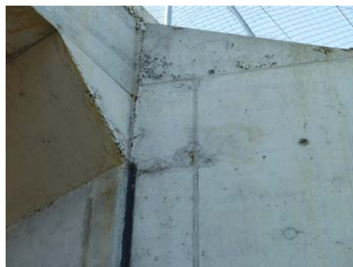
Fotografía nº 8. Nido de grava en la aleta izquierda del estribo de entrada
