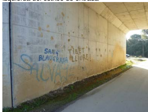
Fotografía nº 10. Pintadas en el hastial del estribo de salida
